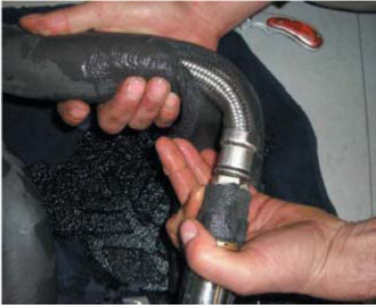
Kuva 26. Asennuksessa on huomioitava, ettei letku jää liian kierteisesksi /6/.
