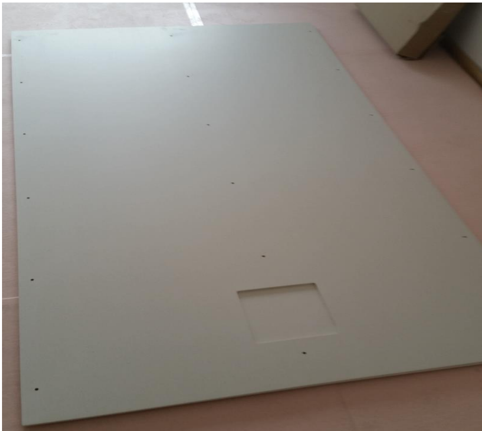
Kuva 19. Väärät reikärivit kattolevyssä.
