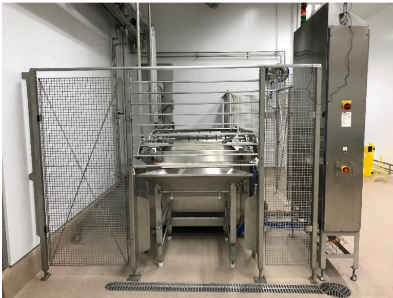
Kuva 3. Uusi esikeittokattila sivusta; takana keittoallas, edessä jäähdytysallas.
