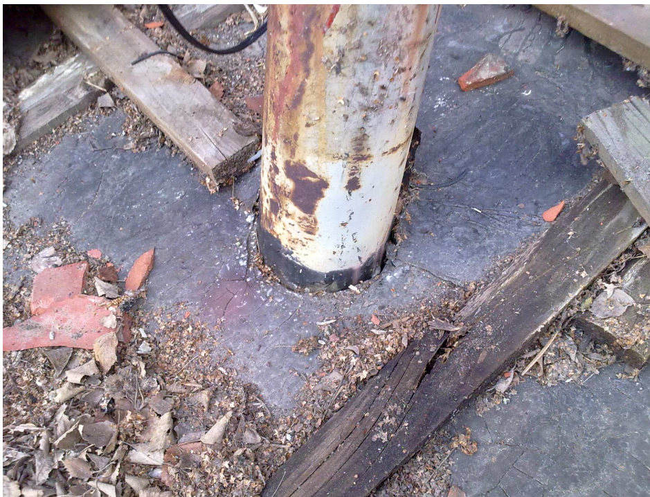
Kuva 6. Vanha läpivienti ei ollut tiivistetty kunnolla
