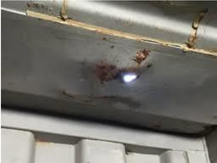
Figur 8: Ett hål i taket. (Western Container Sales 2019)
