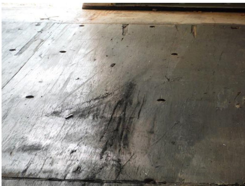
Figur 6: Delaminering av ett containergolv. (Herr 2 2015)
