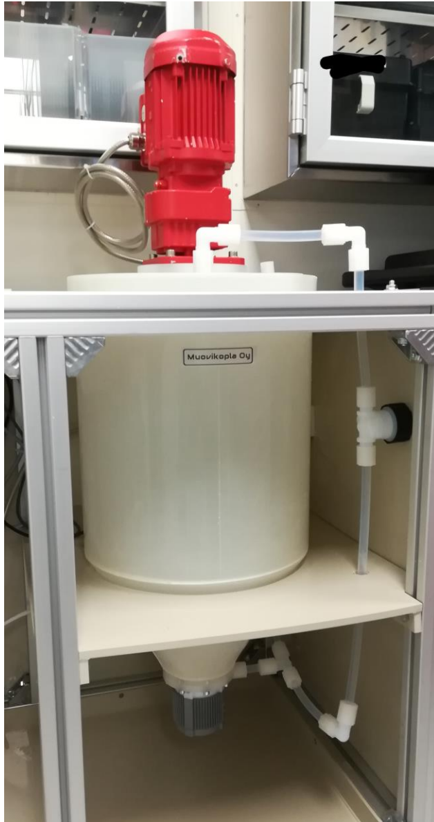
Kuva 17. Kuva valmiista sekoituskammiosta
