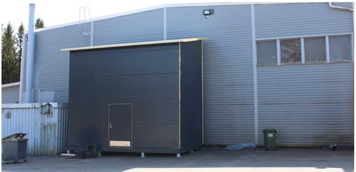
KUVA 23. Pölynpoistolaitte sijoitettiin sitä varten rakennettuun konttiin. (Samuli Sahi, 2020)
