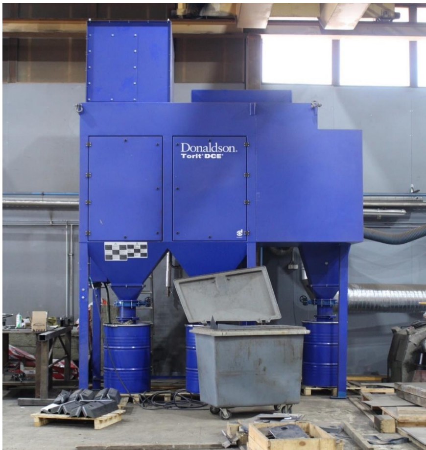
KUVA 11. Levyhallissa sijaitseva pölynpoistolaite. (Samuli Sahi, 2020)
