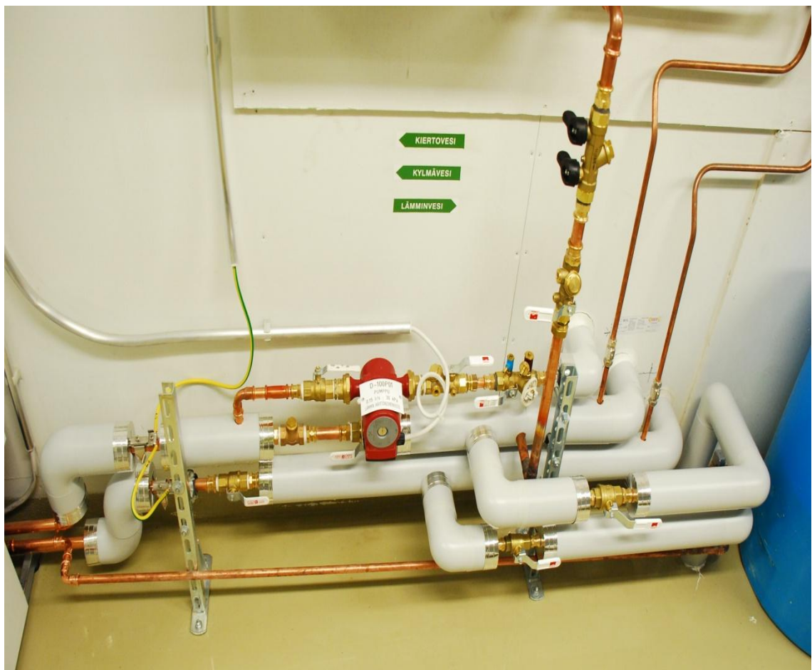
Kuva 6. Laadukkaasti asennettu vesilaitteiston putkitus
