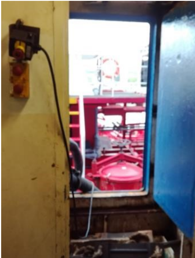
Kuva 17. Hätä-seis-painike bunkkeriasemalla bunkrauksen aikana
