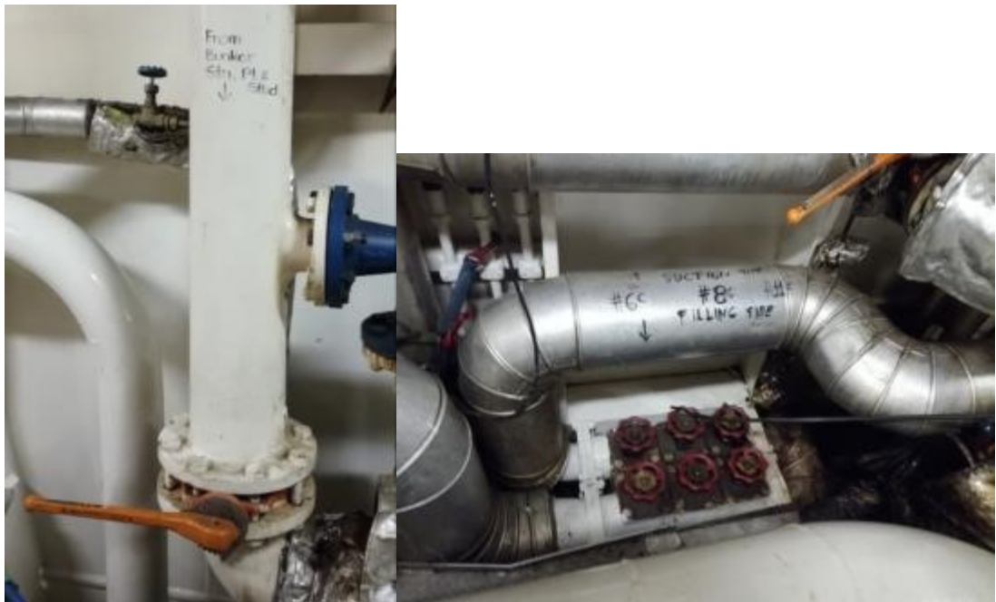
Kuva 4. Konehuoneessa HFO-tankkien venttiilit
