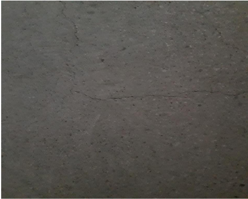
Kuva 1. Työmaan kylpyhuoneen lattiassa halkeama
