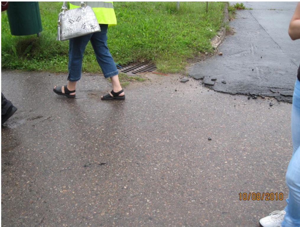
KUVA 33. Kuivatusongelma ja päällystekynnys kaupunginviraston läheisyydessä
