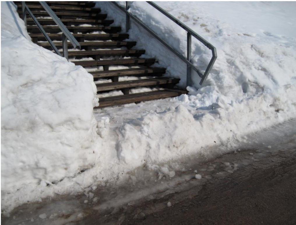
KUVA 19. Rappusten puutteellinen talvikunnossapito
