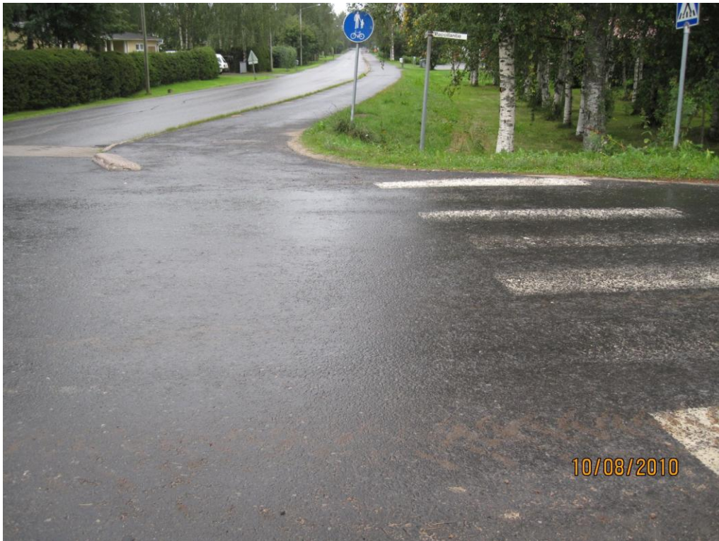
KUVA 21. Kulunut suojatiemaalaus johdattaa ojaan eikä suojatien reunassa ole pientä kynnystä
