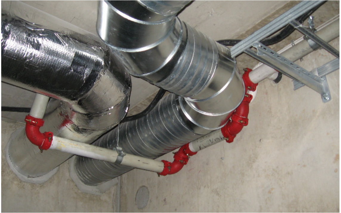
Kuva 16. Putkiston ei toivottu asennustapa.
