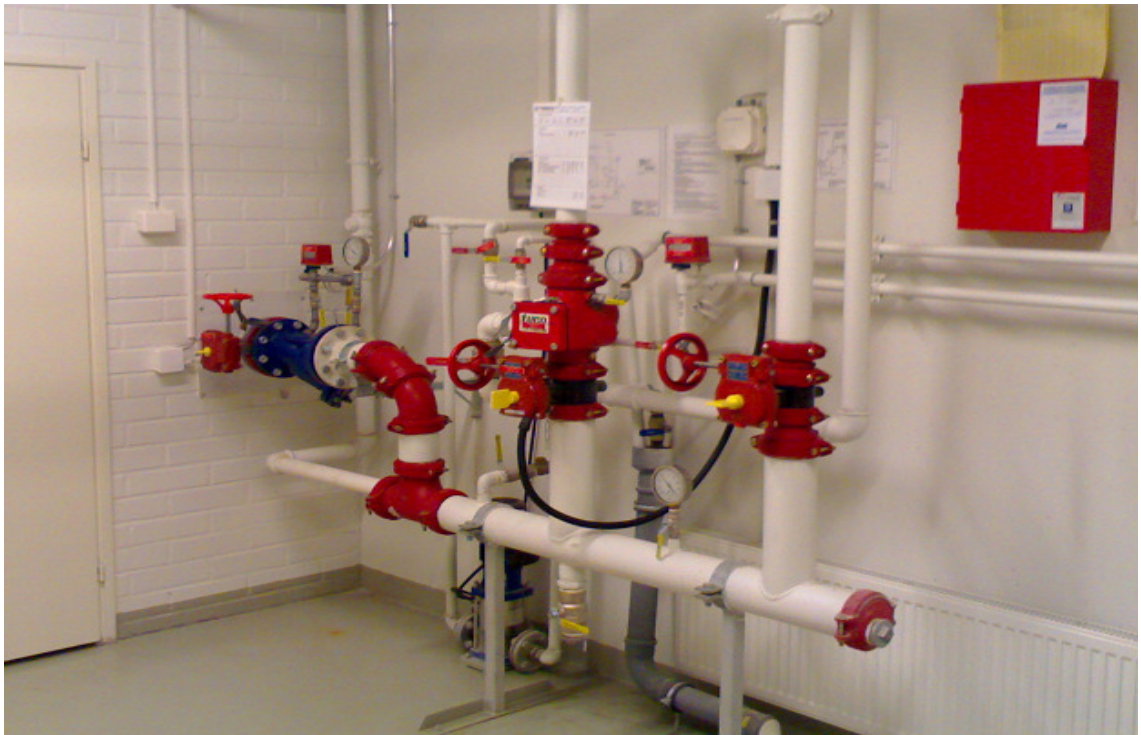
Kuva 2. Erään hoivakodin asennusventtiili laitteineen.
