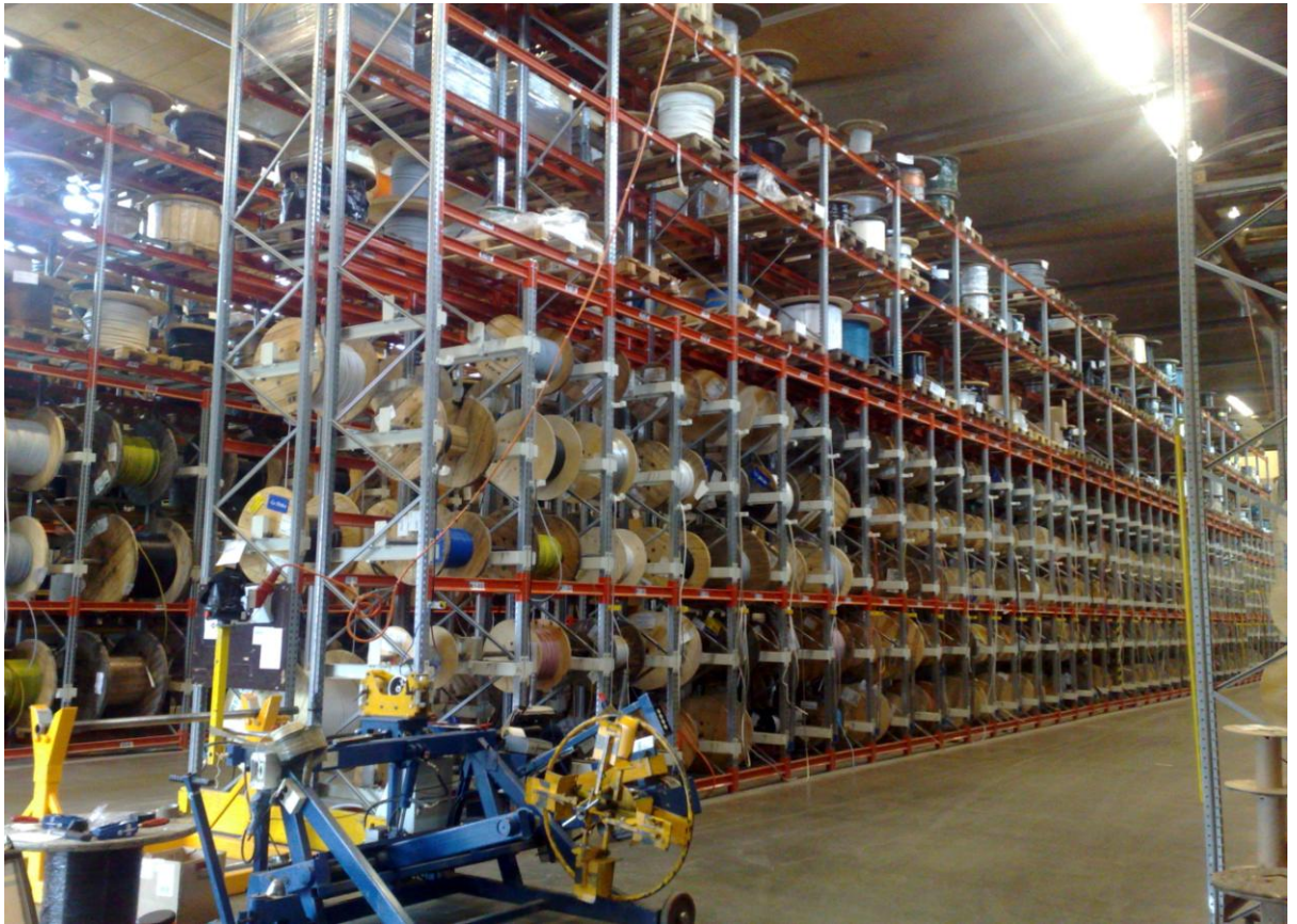
Kuva 5. CP4-alueen vetokone ja kelapukki sekä varastopaikkoja kaapelihallissa ennen muutostöitä K1-käytävän puolelta.
