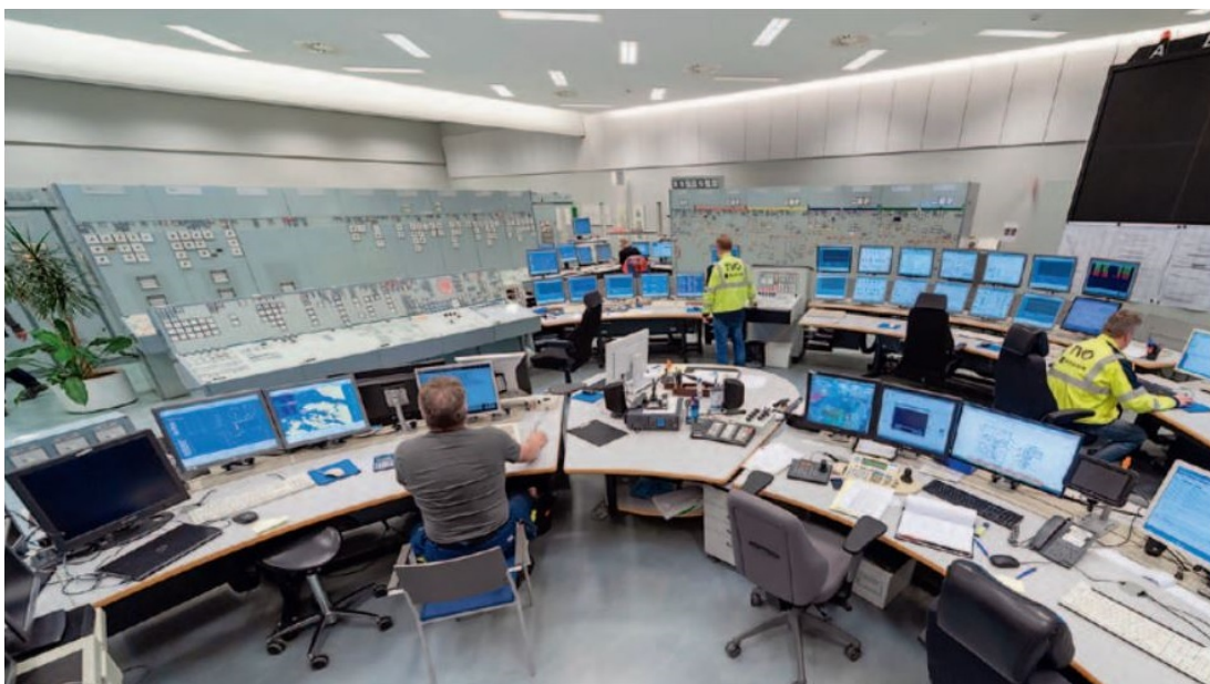
Kuva 3. OL1-laitosyksikön valvomo vuosihuoltojen aikaan (TVO, Uutisia Olkiluodosta 1/2018)
