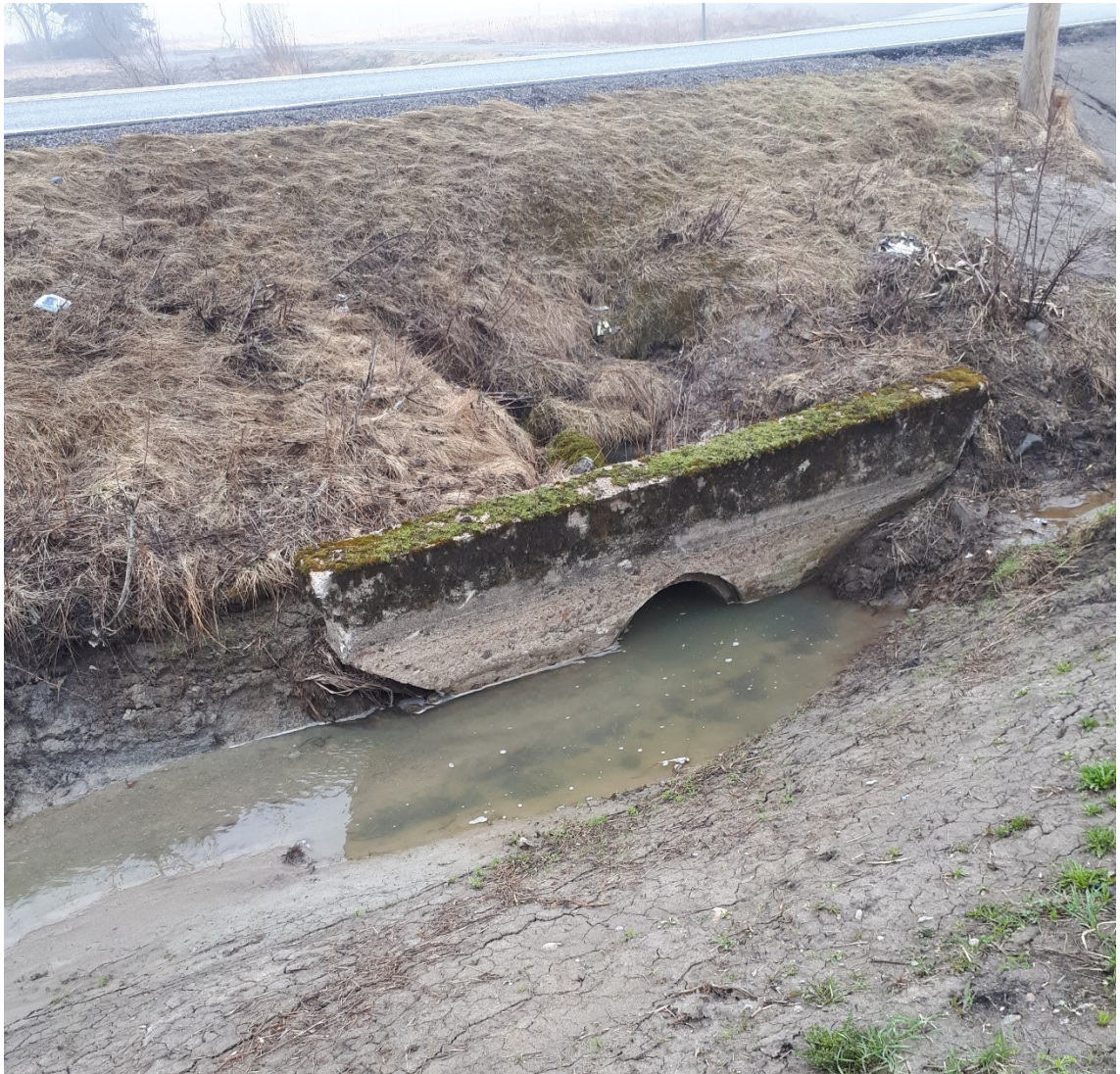
Kuva 44. Liikkunut rummun pää.
