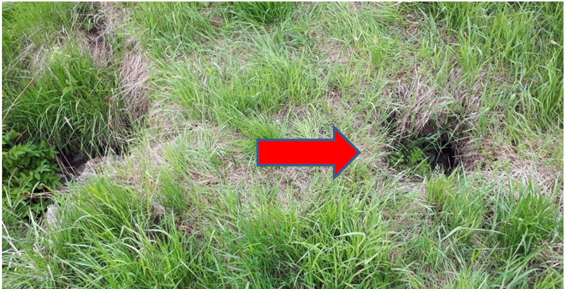
Kuva 10. Maatalousliittymän vanha putki sortunut päältä.
