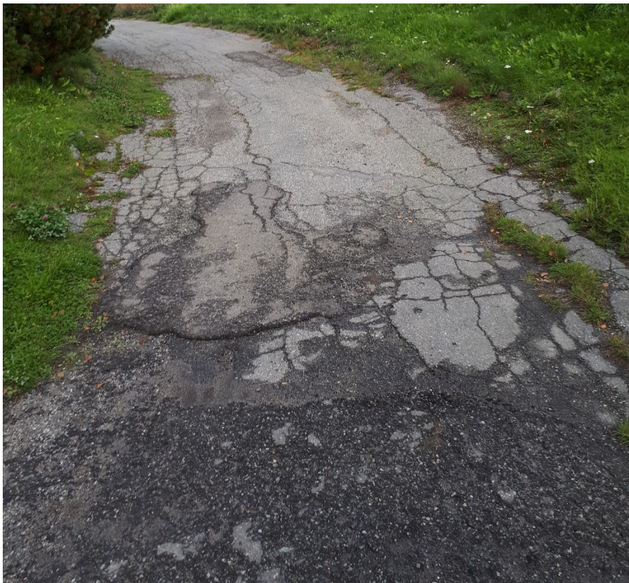
Kuva 38. Asfaltti on painunut reunoilta ja halkeillut.
