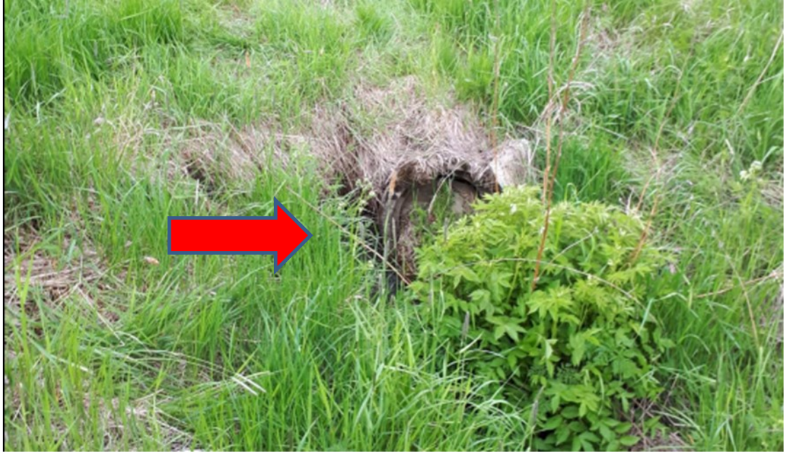
Kuva 9. Maatalousliittymän vanhan putken pahasti rehevöitynyt alapää.
