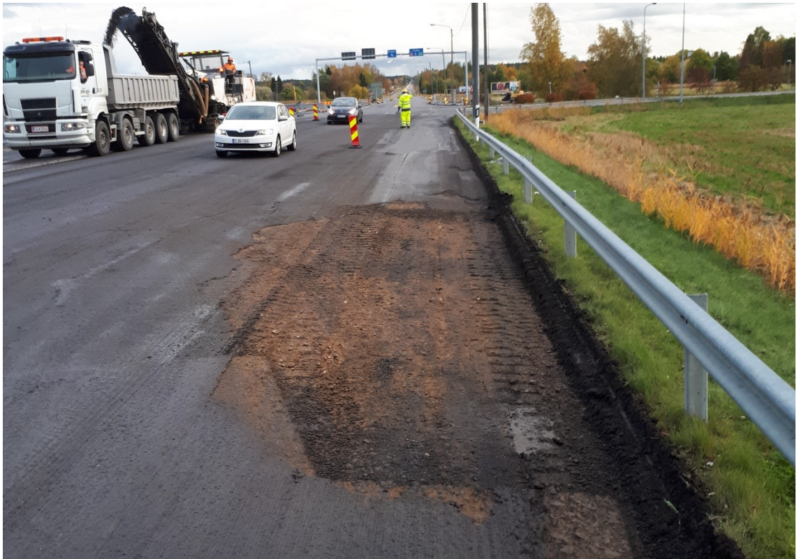
Kuva 33. Asfaltti irronnut kokonaan jyrinnän yhteydessä.
