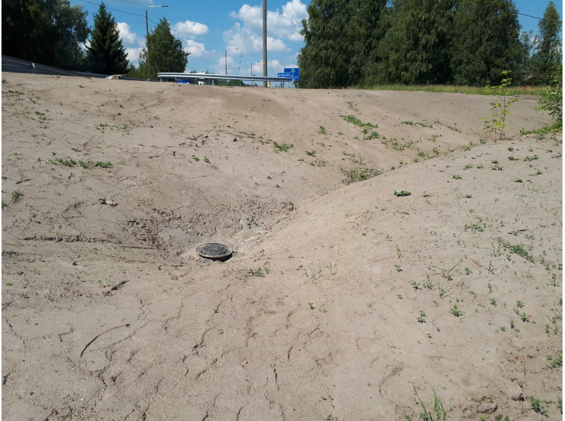
Kuva 41. Vaarallinen kaivo on korvattu uudella.
