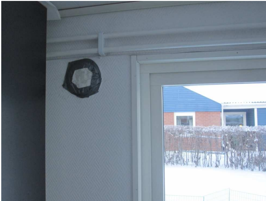
KUVA 2. Teipillä tiivistetty tuloilmaventtiili
