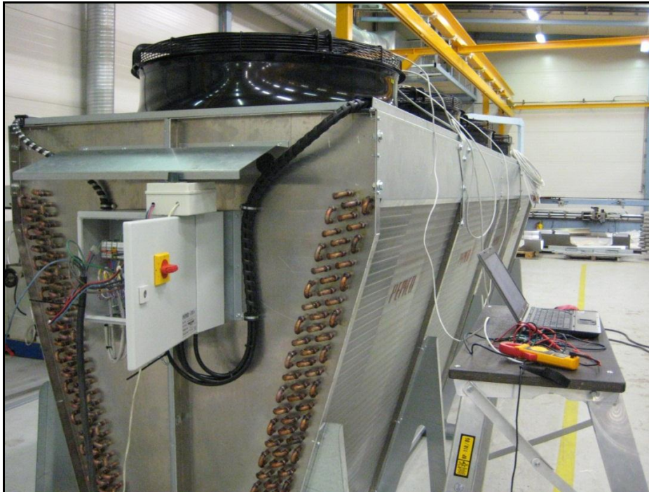
KUVA 5. Liuosjäähdyttimen kytkeminen kenttäväylään
