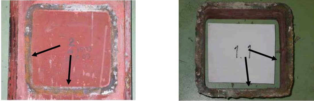
Kuva 3. Ruostejälkien perusteella havaittiin heti, että liitos ei ollut paikoin tarttunut lainkaan vahvikelevyyn (Kuvälähde: Onnettomuustutkintakeskus 2004)
