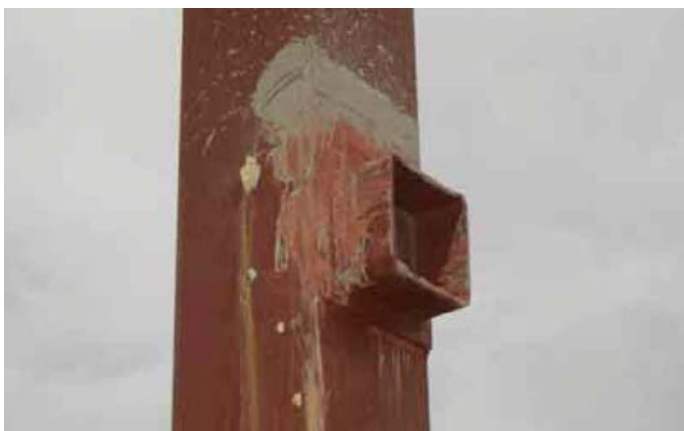
Kuva 2. Huoltoaseman rakennustyömaalla romahtaneen vaakapalkin liittyminen pystypalkkiin (Onnettomuustutkintakeskus 2004).
