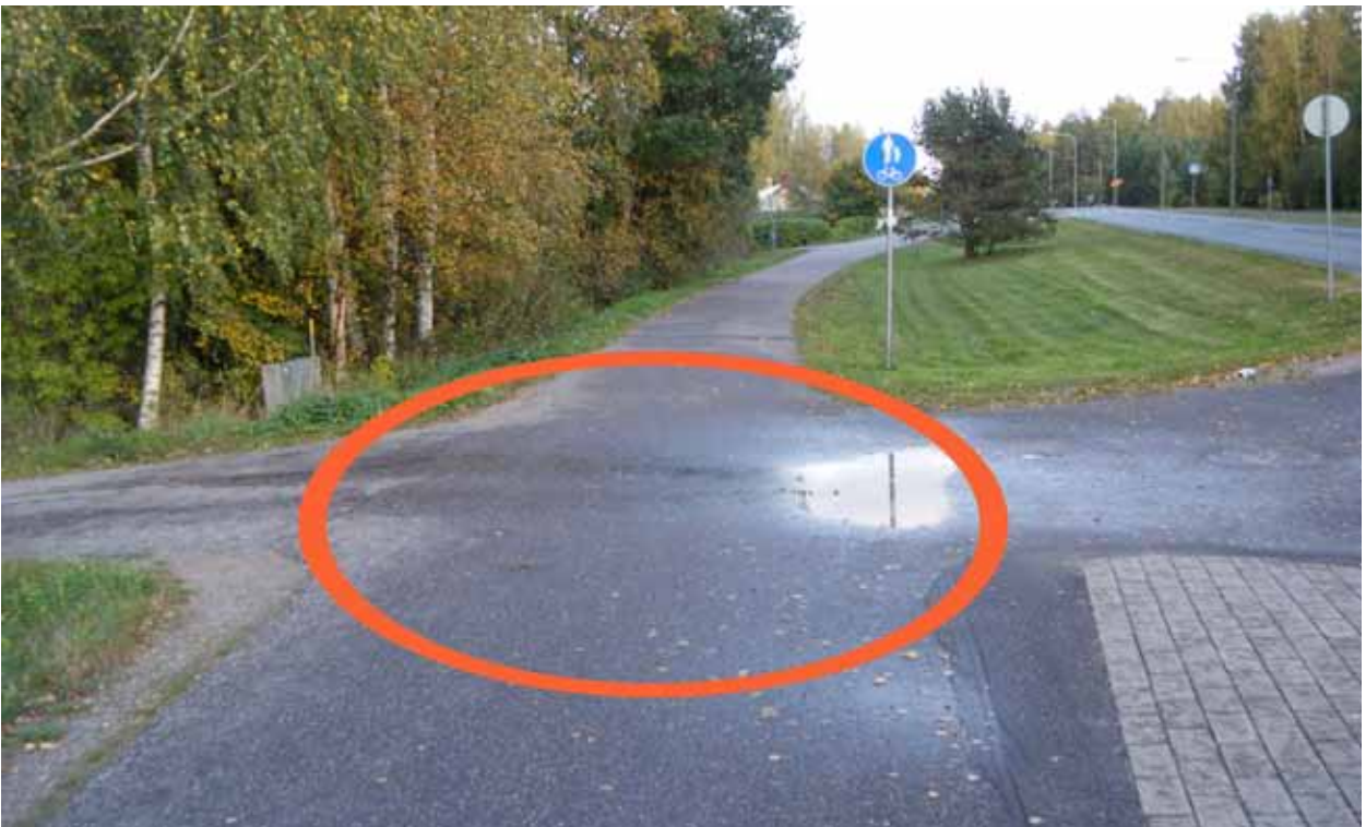
Kuva 104. Pyörätien jatke puuttuu.
