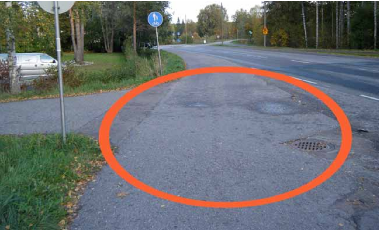
Kuva 107. Pyörätien jatke puuttuu.
