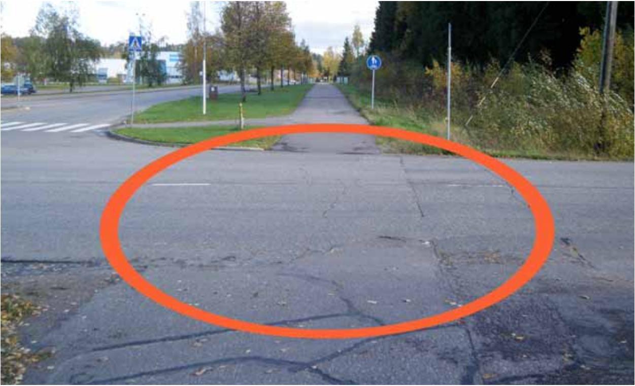
Kuva 151. Pyörätien jatke puuttuu.
