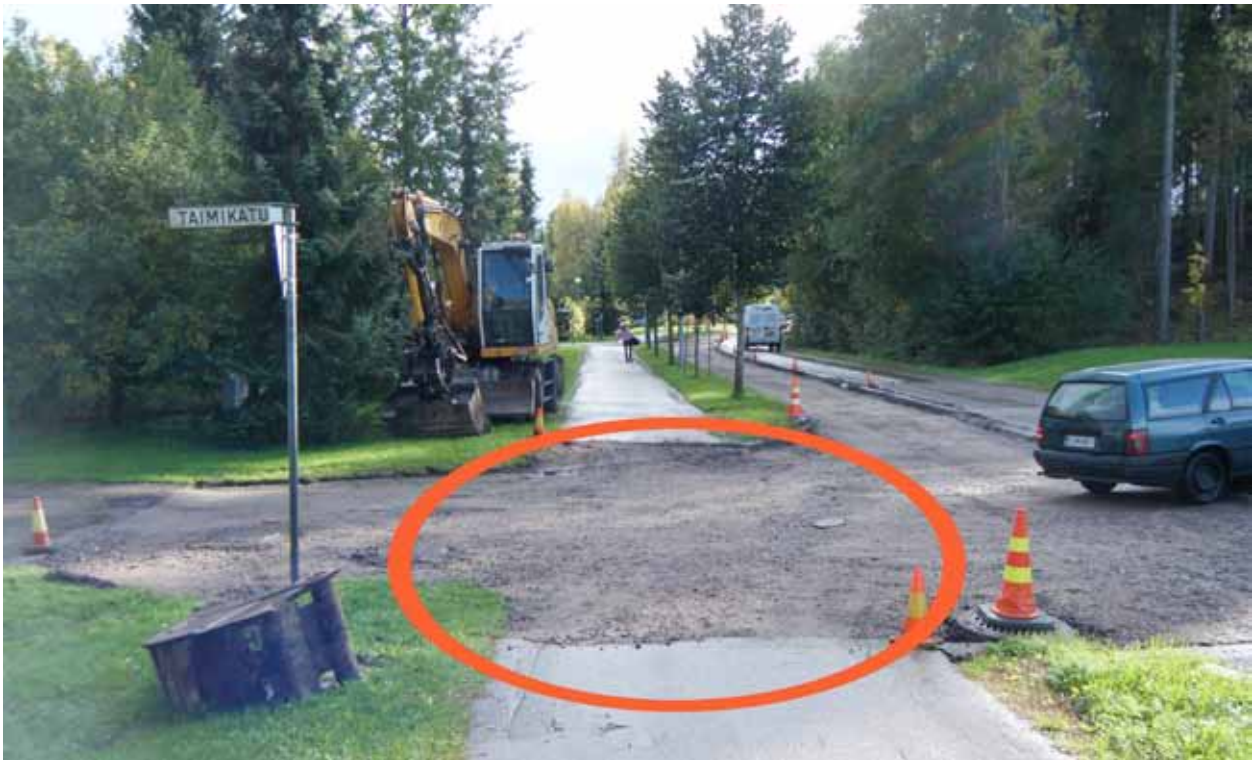
Kuva 83. Pyörätien jatke puuttuu.
