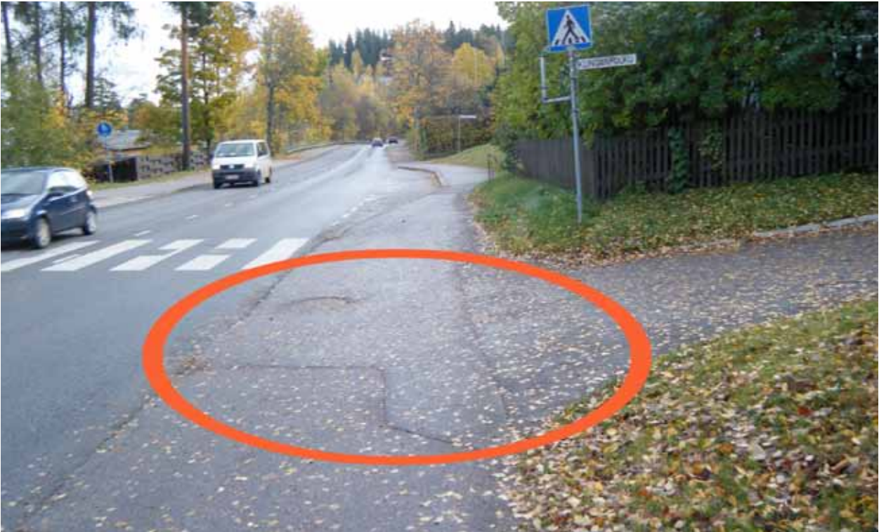
Kuva 155. Pyörätien jatke puuttuu.
