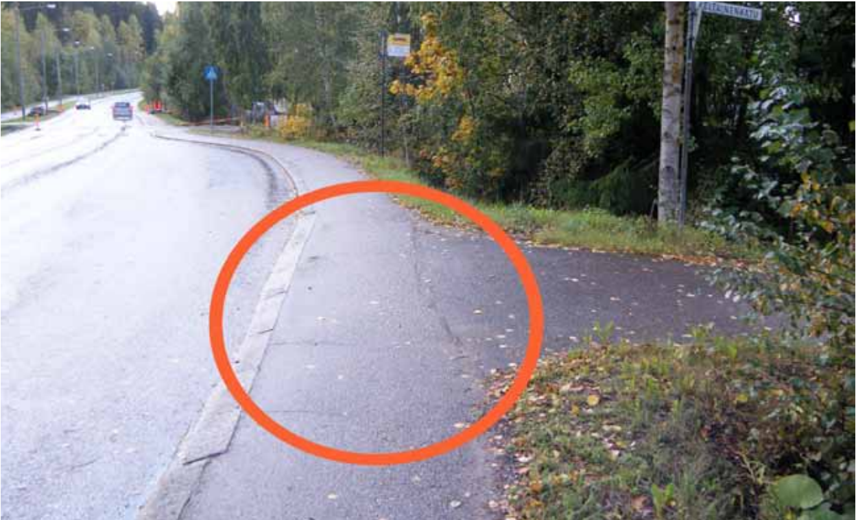
Kuva 91. Pyörätien jatke puuttuu.
