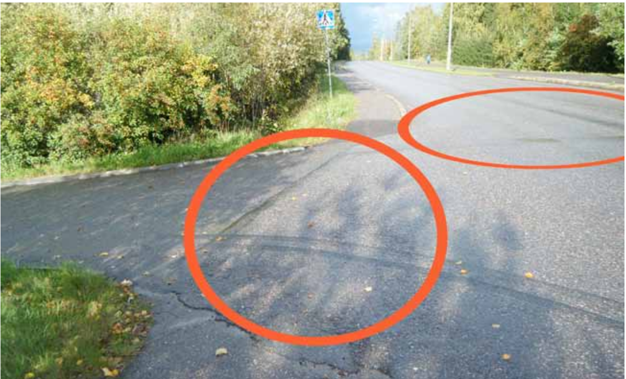
Kuva 100. Pyörätien jatke puuttuu.
