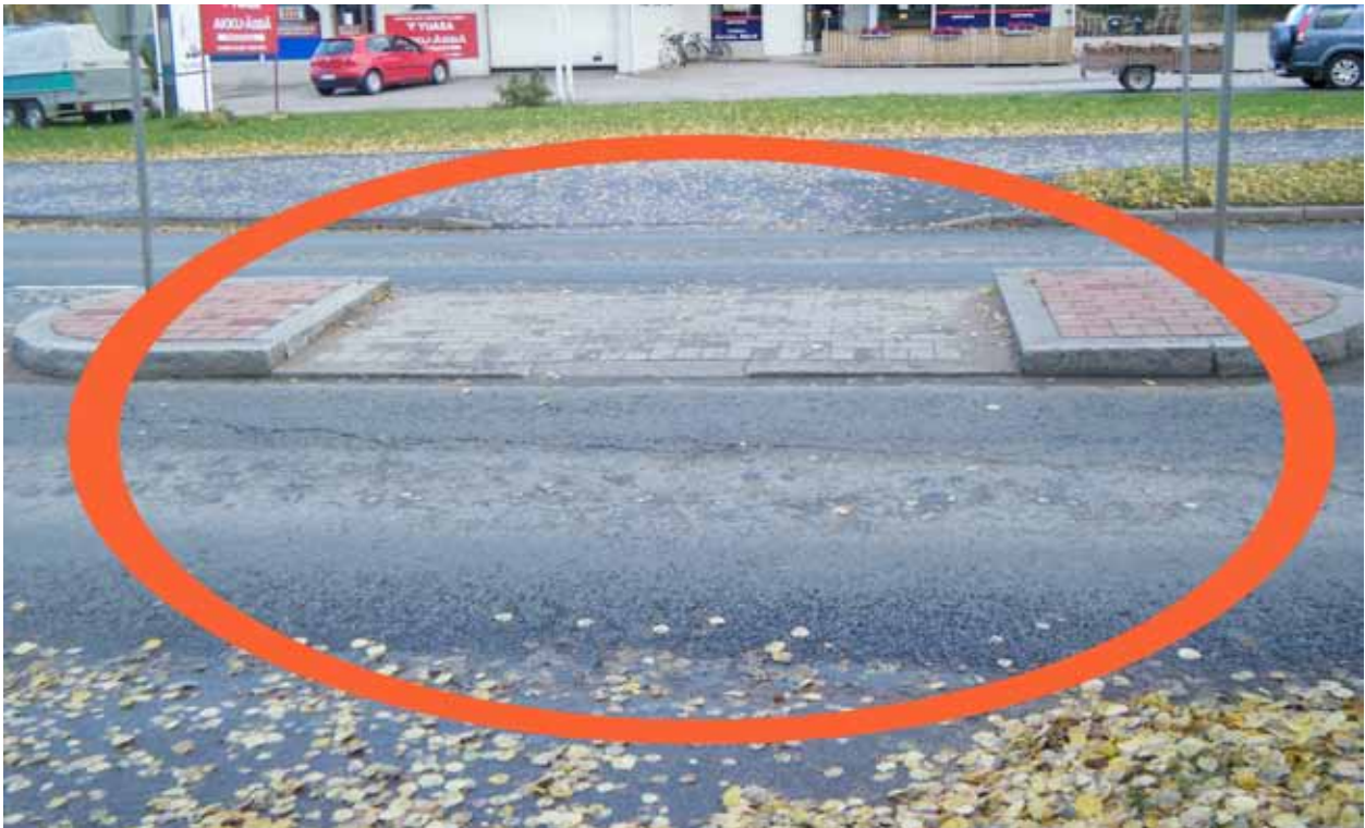
Kuva 147. Pyörätien jatke puuttuu.
