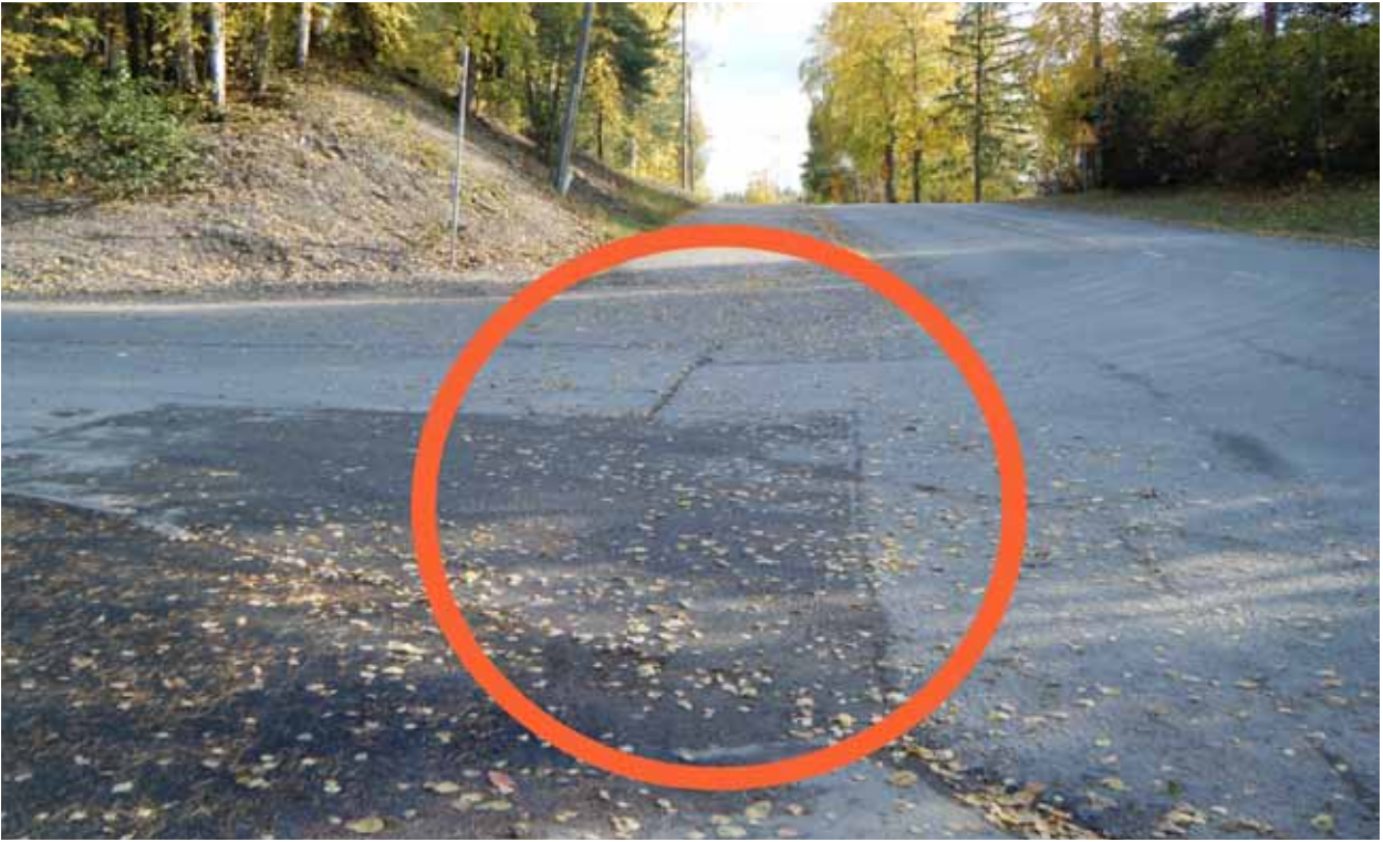
Kuva 139. Pyörätien jatke puuttuu.
