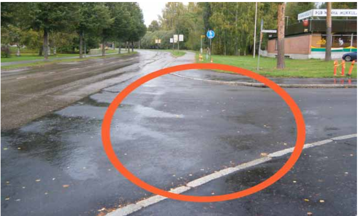
Kuva 58. Pyörätien jatke puuttuu.
