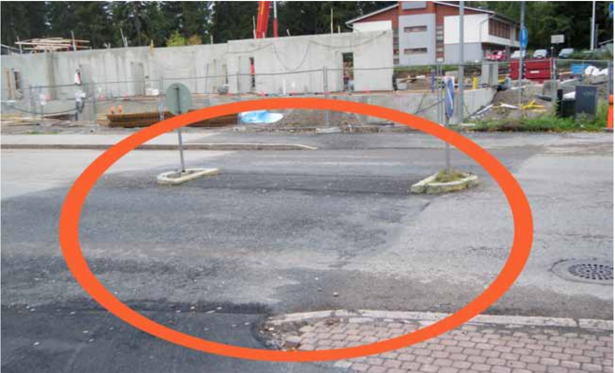
Kuva 39. Pyörätien jatke puuttuu.
