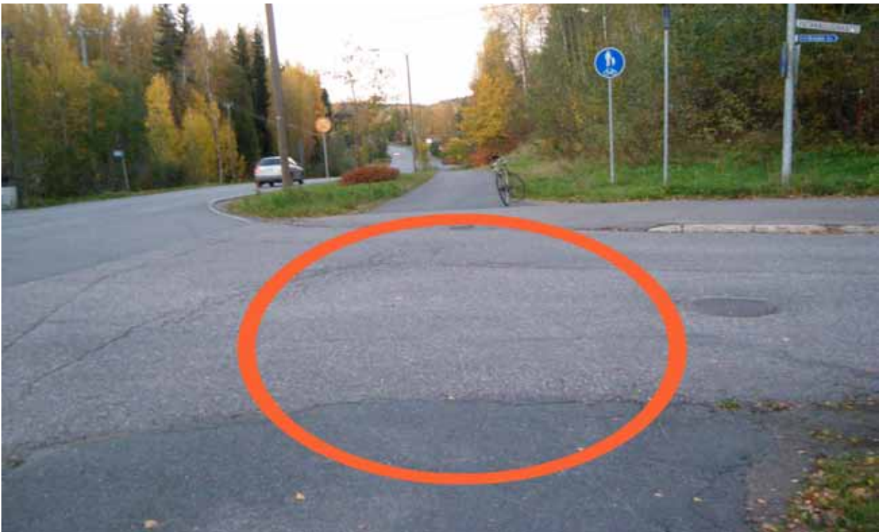
Kuva 142. Pyörätien jatke puuttuu.
