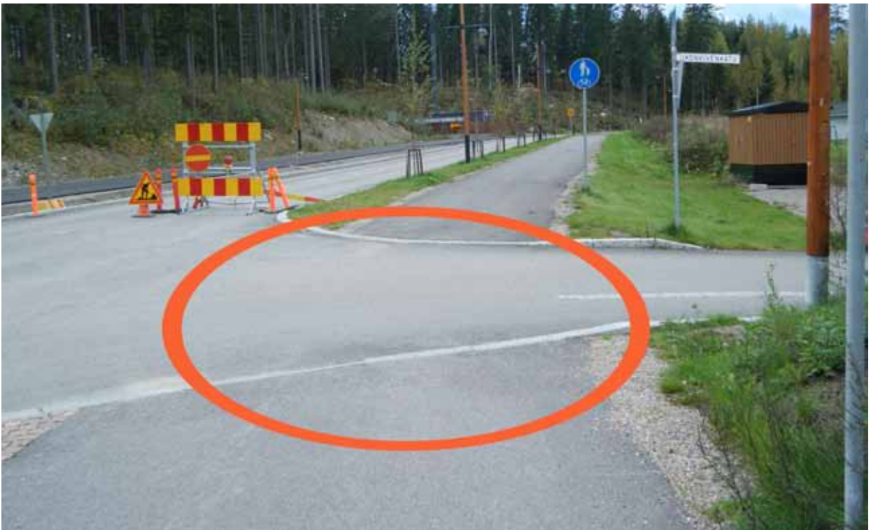
Kuva 70. Pyörätien jatke puuttuu.
