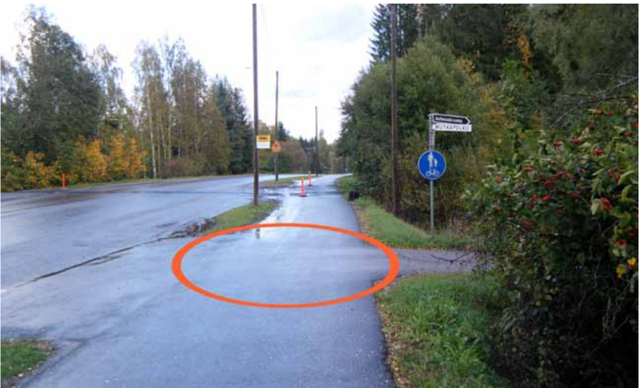
Kuva 92. Pyörätien jatke puuttuu.
