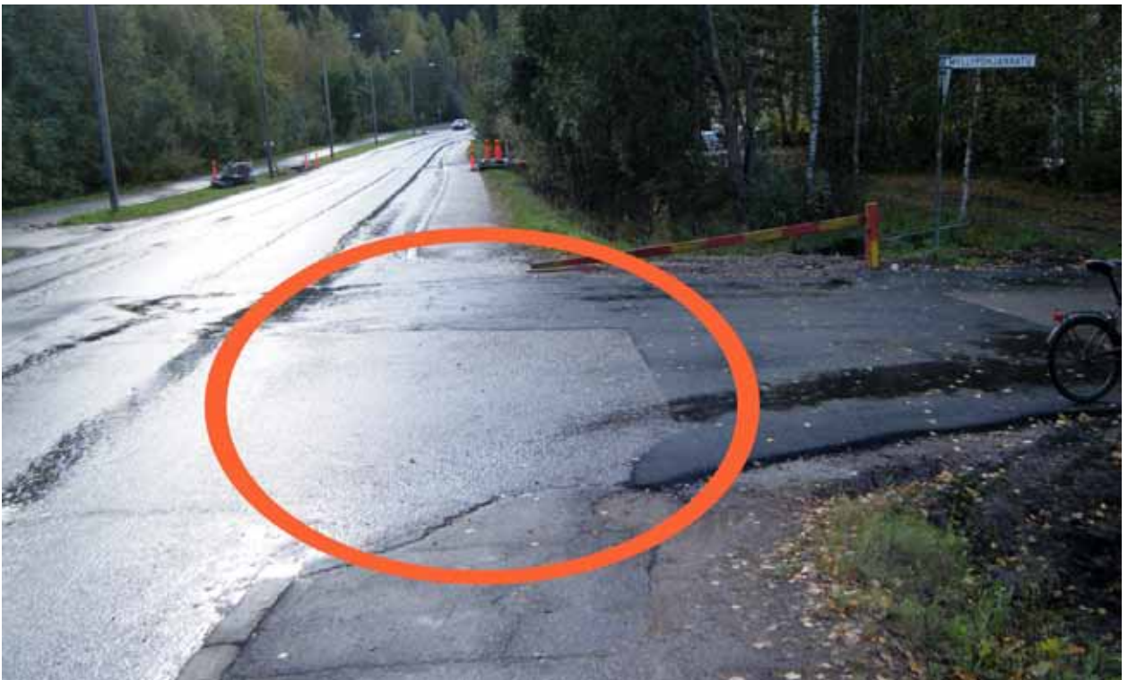
Kuva 90. Pyörätien jatke puuttuu.
