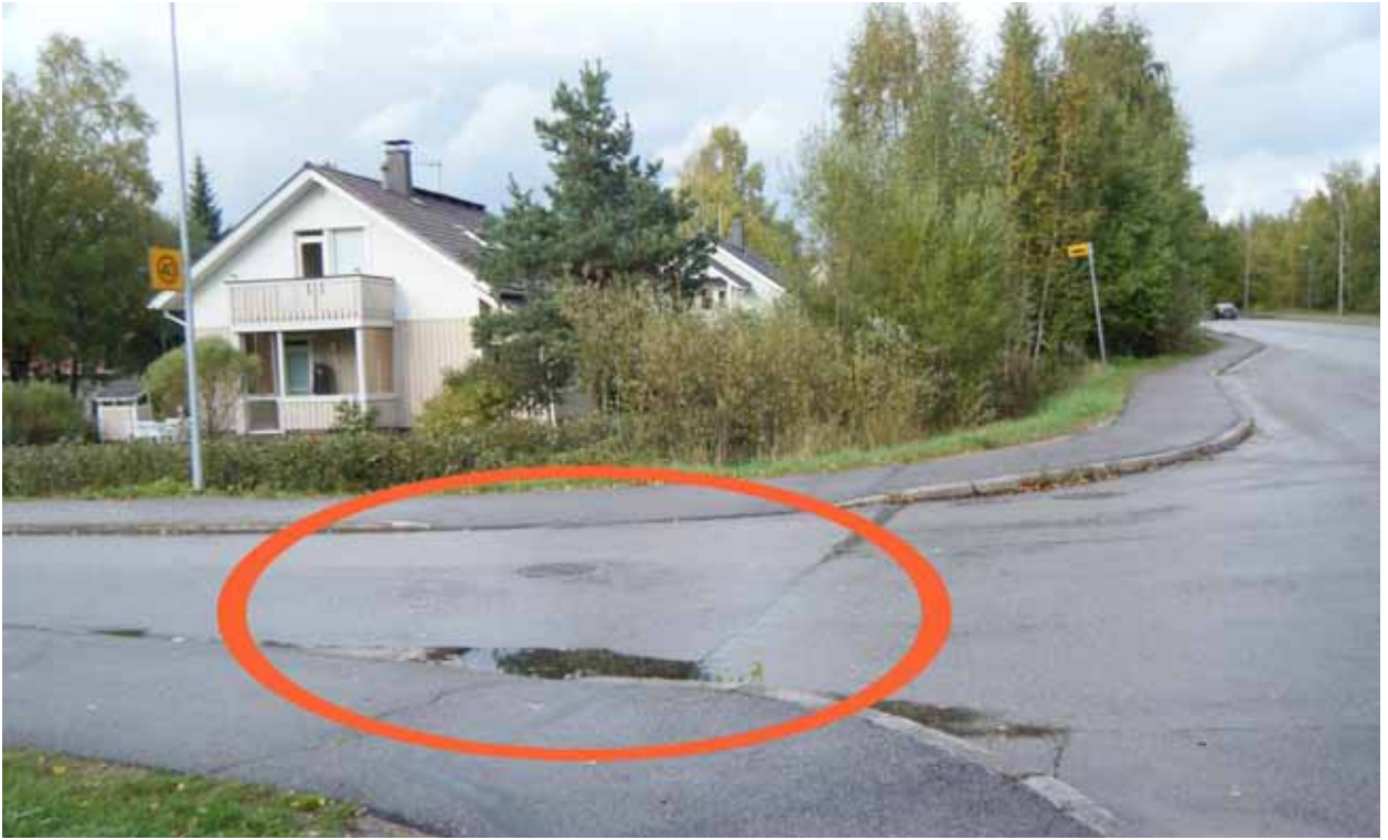
Kuva 97. Pyörätien jatke puuttuu.
