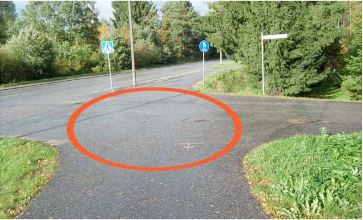
Kuva 99. Pyörätien jatke puuttuu.
