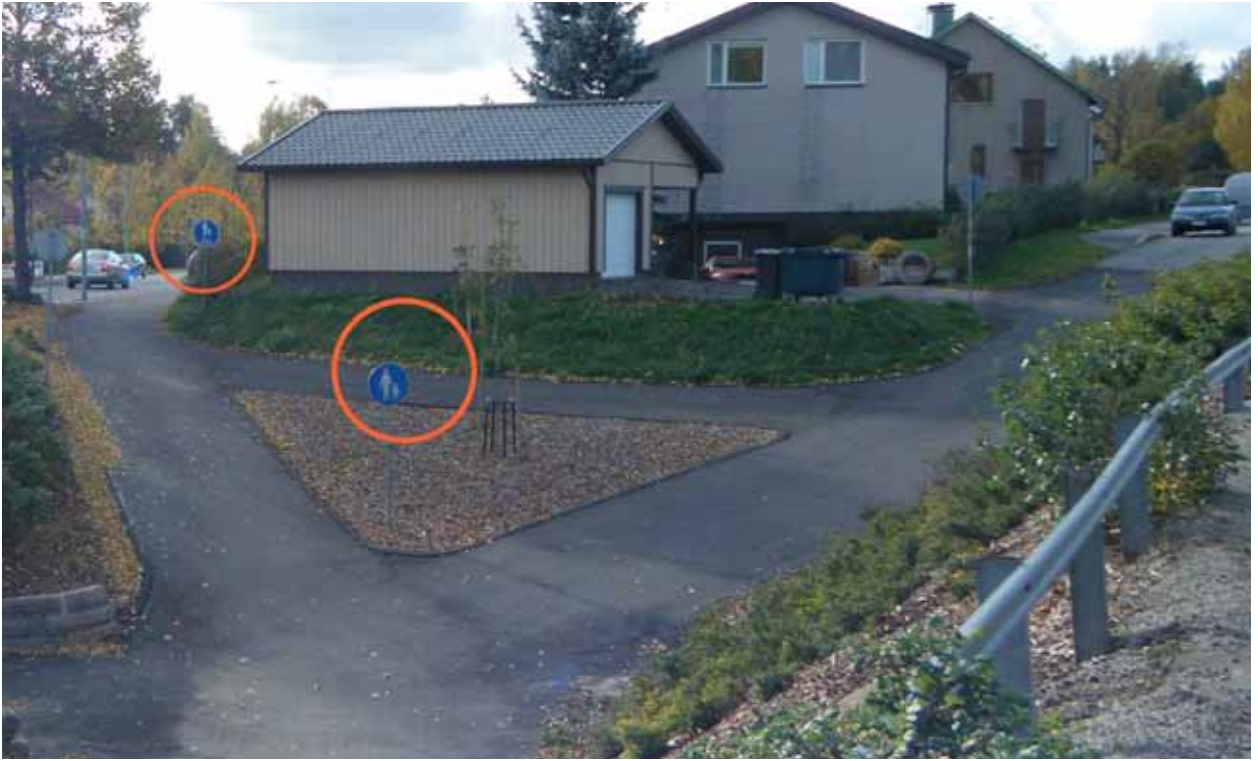
Kuva 153. Kevyenliikenteenväylä liikennemerkki puuttuu.
