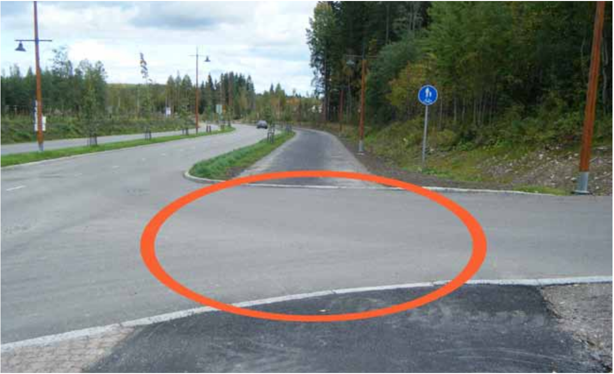
Kuva 71. Pyörätien jatke puuttuu.
