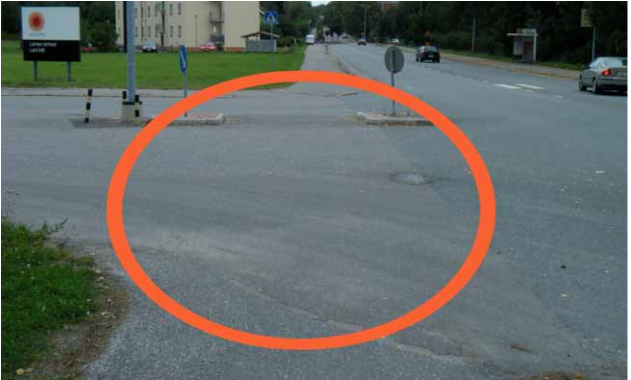
Kuva 17. Pyörätien jatke puuttuu.
