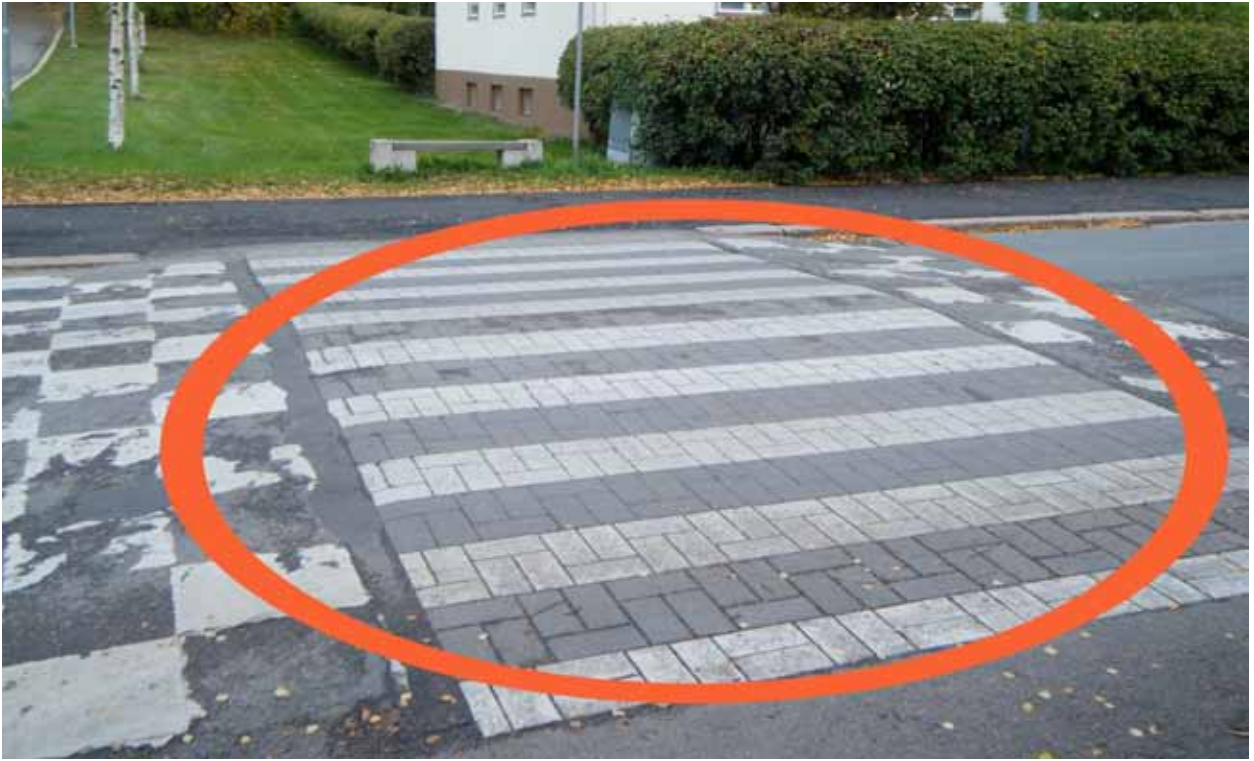
Kuva 137. Pyörätien jatke puuttuu.
