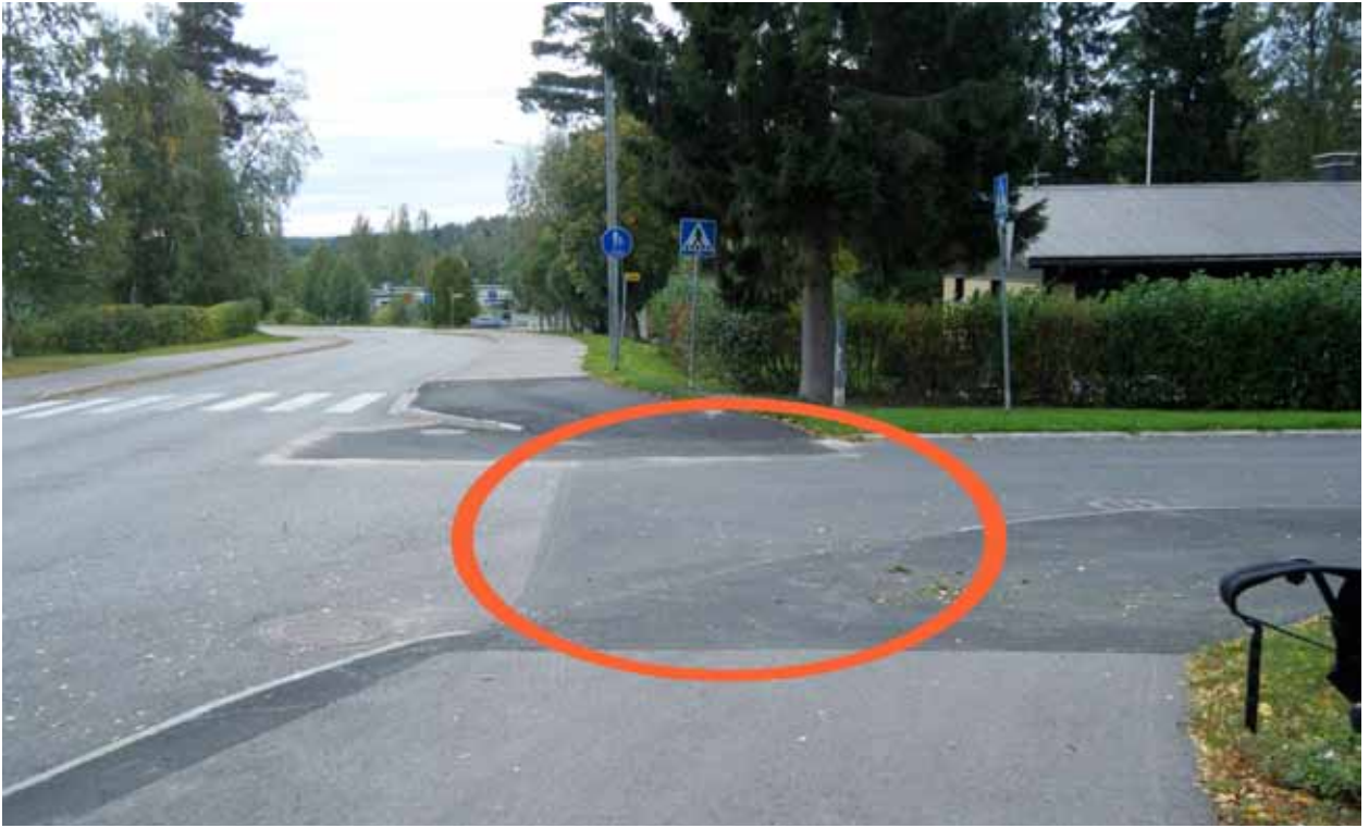
Kuva 9. Pyörätien jatke puuttuu.
