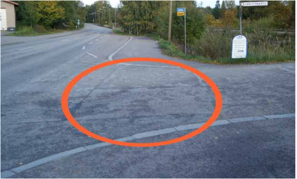
Kuva 109. Pyörätien jatke puuttuu.
