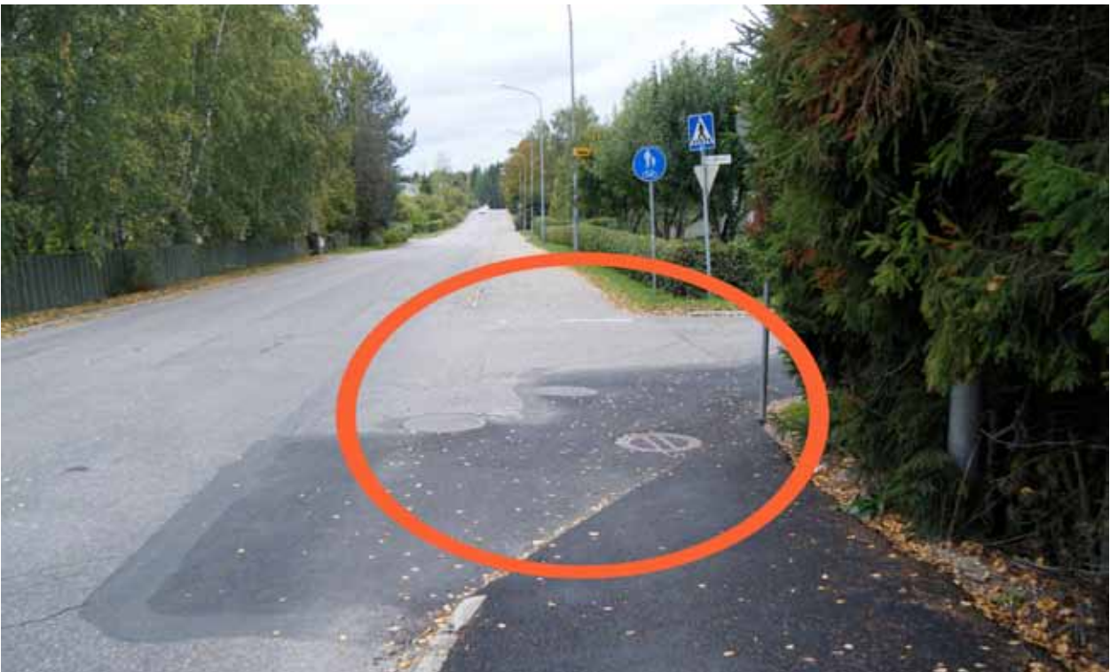
Kuva 44. Pyörätien jatke puuttuu.
