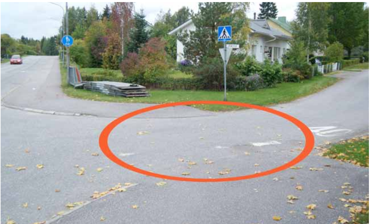
Kuva 46. Pyörätien jatke puuttuu.
