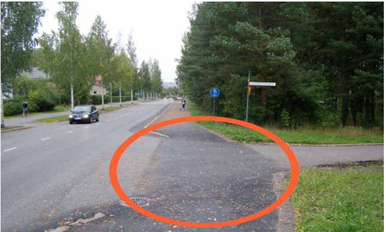
Kuva 42. Pyörätien jatke puuttuu.
