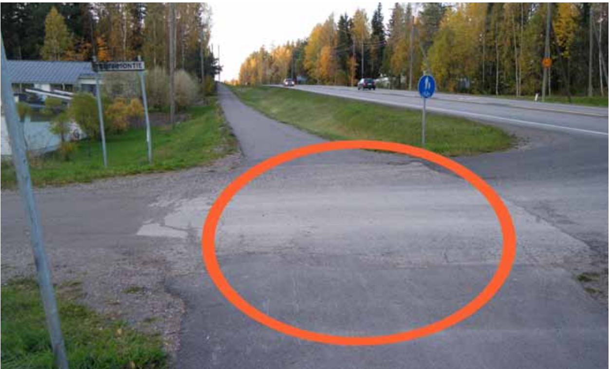
Kuva 140. Pyörätien jatke puuttuu.
