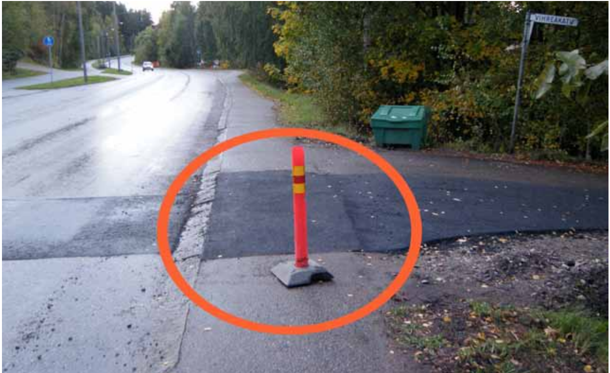
Kuva 93. Pyörätien jatke puuttuu.
