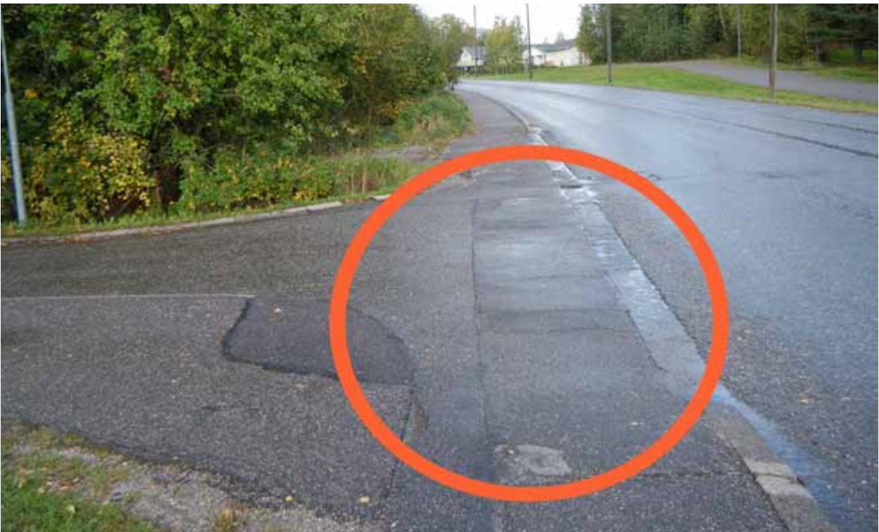
Kuva 96. Pyörätien jatke puuttuu.
