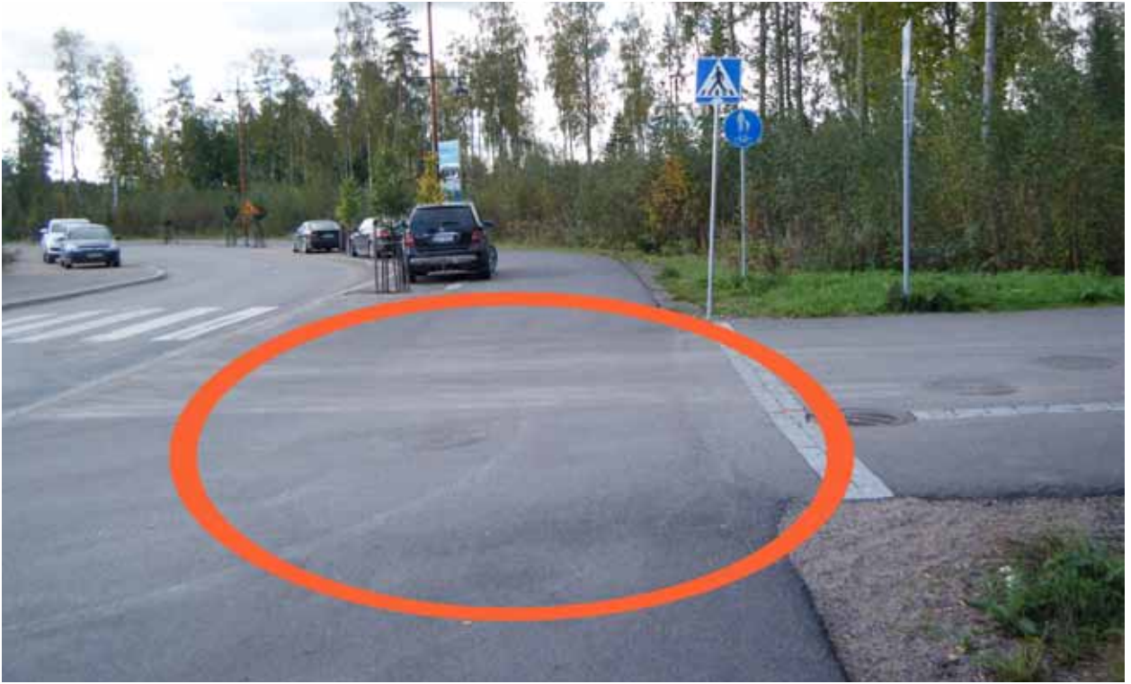
Kuva 77. Pyörätien jatke puuttuu.
