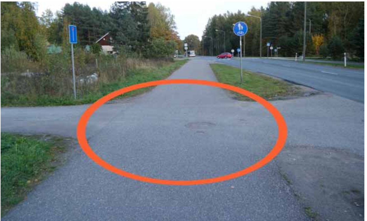
Kuva 106. Pyörätien jatke puuttuu.
