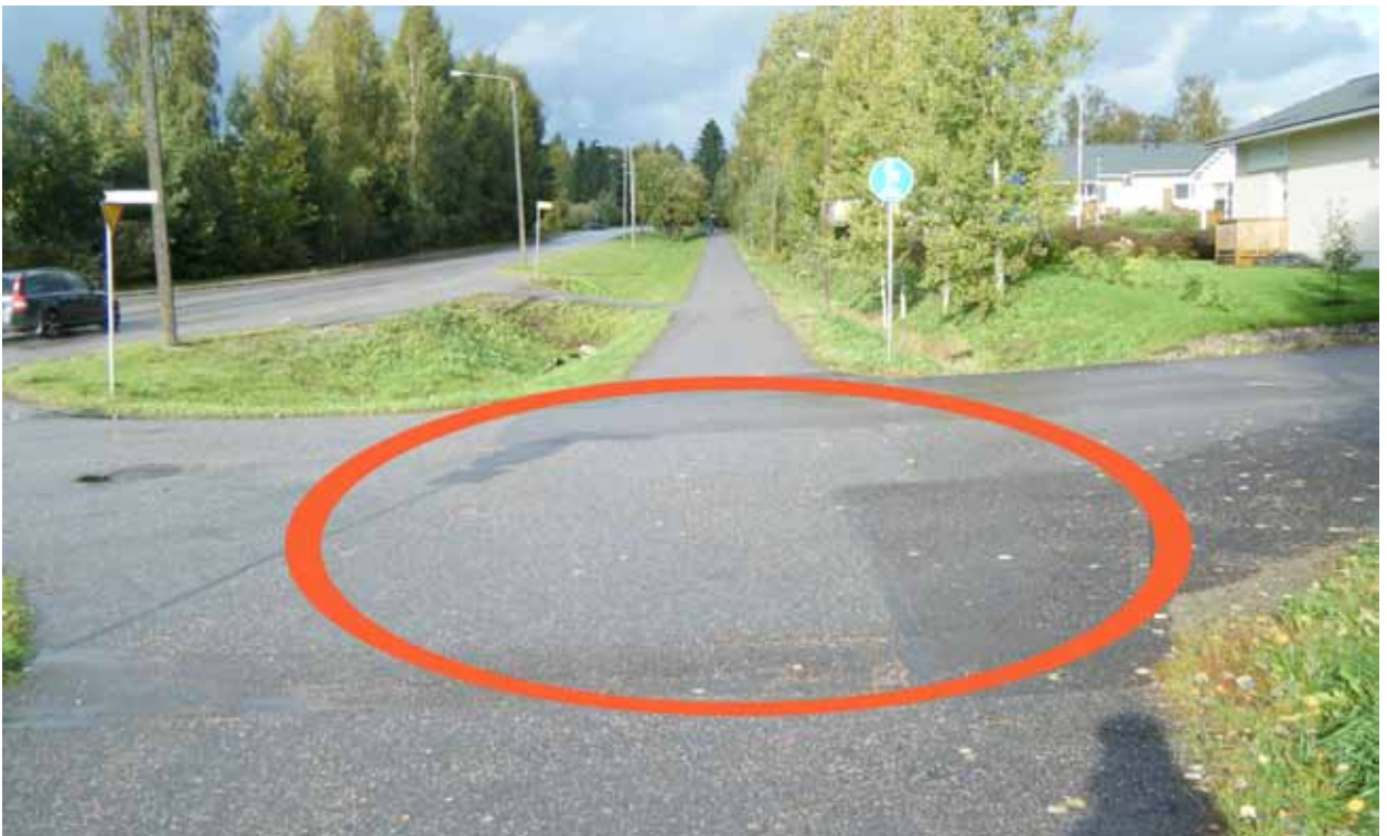
Kuva 98. Pyörätien jatke puuttuu.
