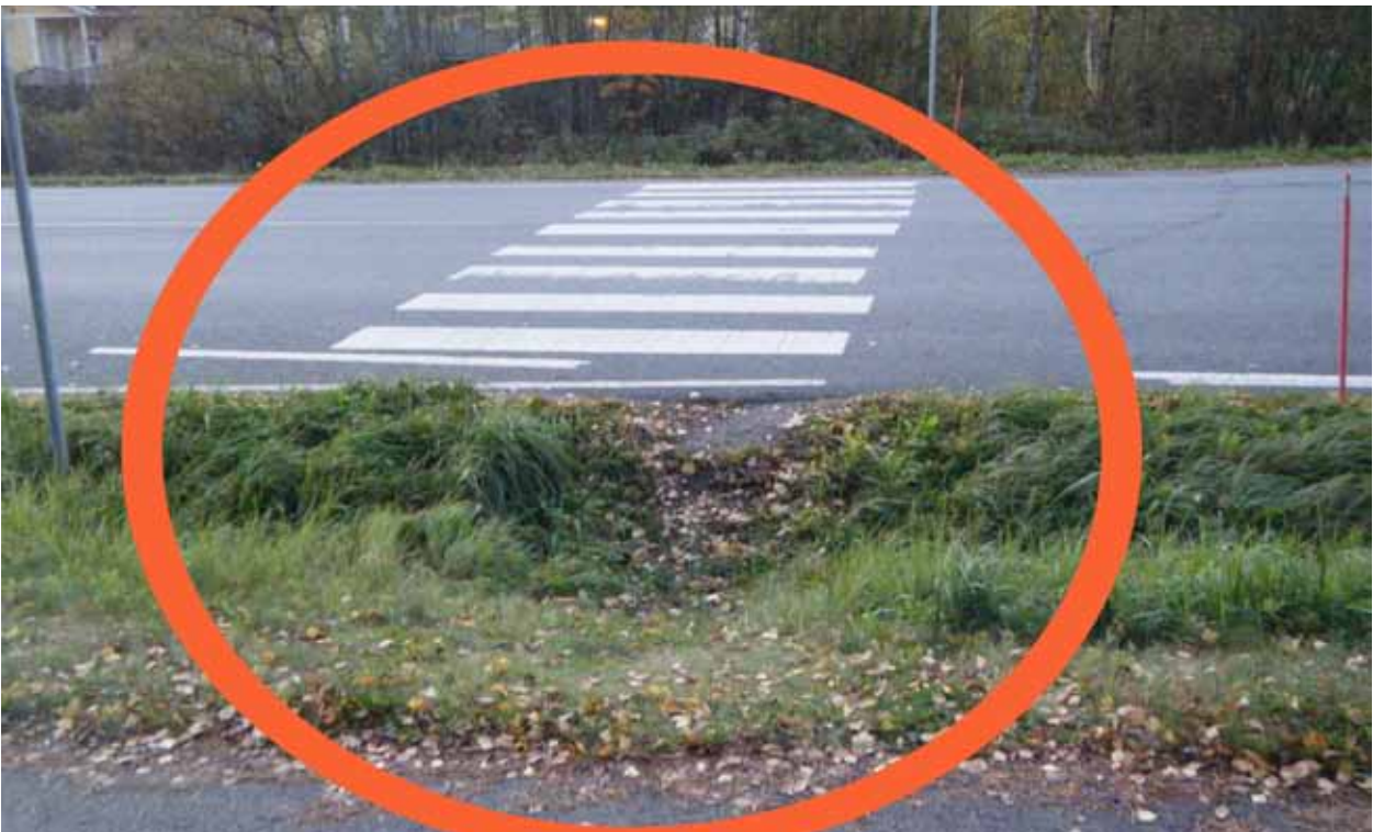
Kuva 144. Kevyenliikenteen väylältä ei yhteyttä suojatielle.
