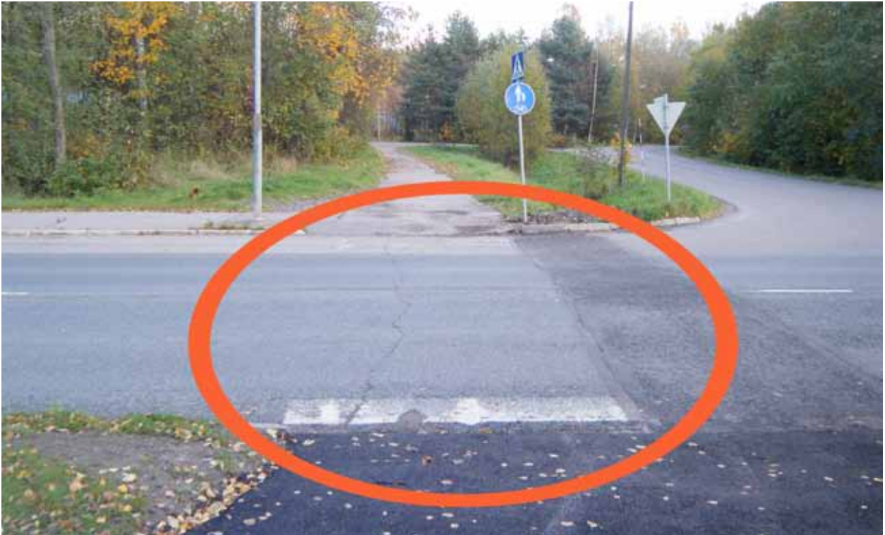
Kuva 149. Pyörätien jatke puuttuu.
