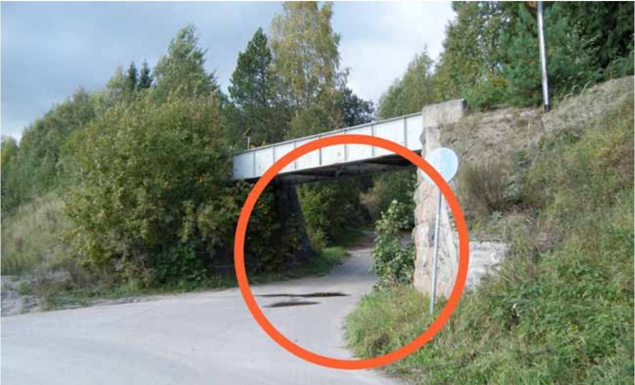
Kuva 63. Kasvillisuus peittää näkemäalueen. Kevyenliikenteenväylän liikennemerkki huonokuntoinen ja vinossa.
