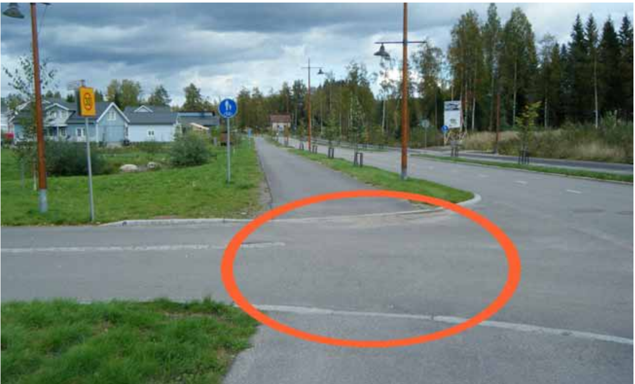
Kuva 72. Pyörätien jatke puuttuu.
