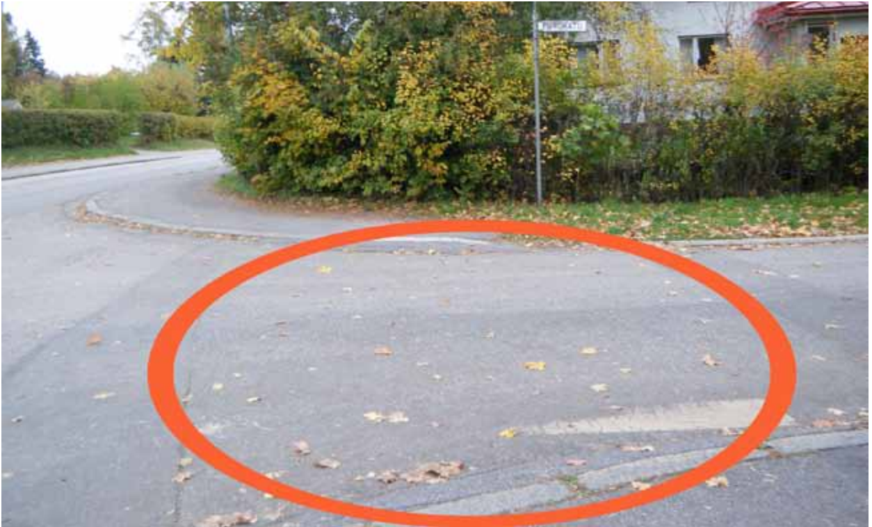
Kuva 125. Pyörätien jatke puuttuu.
