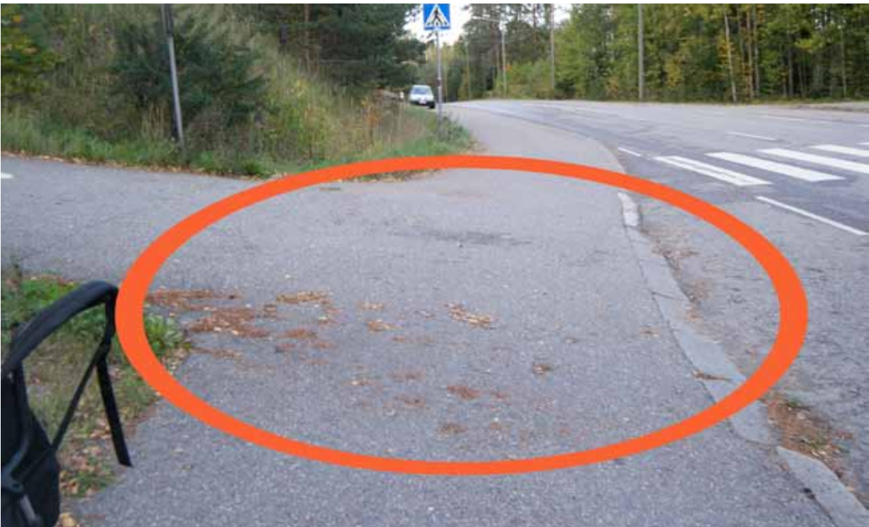
Kuva 112. Pyörätien jatke puuttuu.
