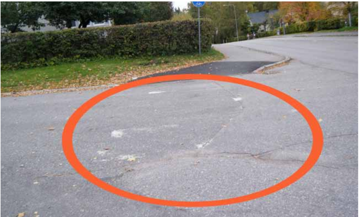
Kuva 126. Pyörätien jatke puuttuu.
