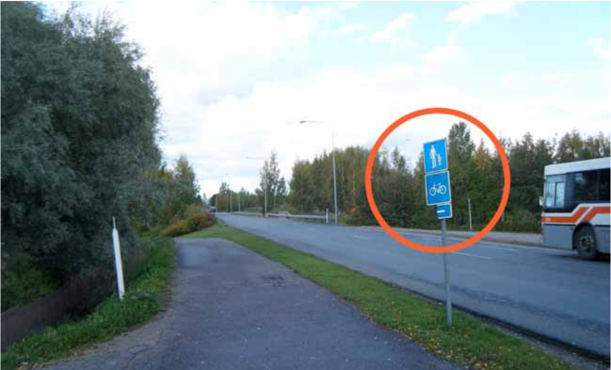
Kuva 103. Huonokuntoinen ja poikkeava yhdistetyn kevyenliikenteenväylän liikennemerkki.
