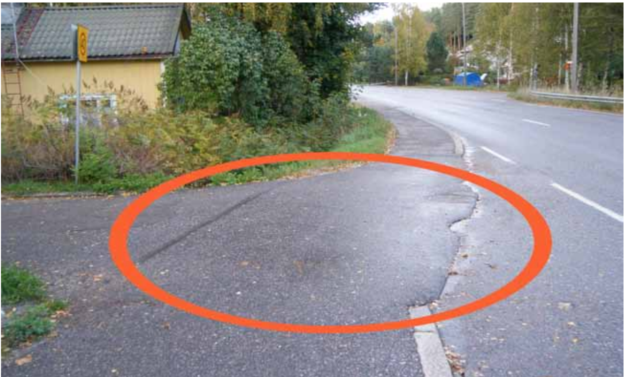
Kuva 114. Pyörätien jatke puuttuu.
