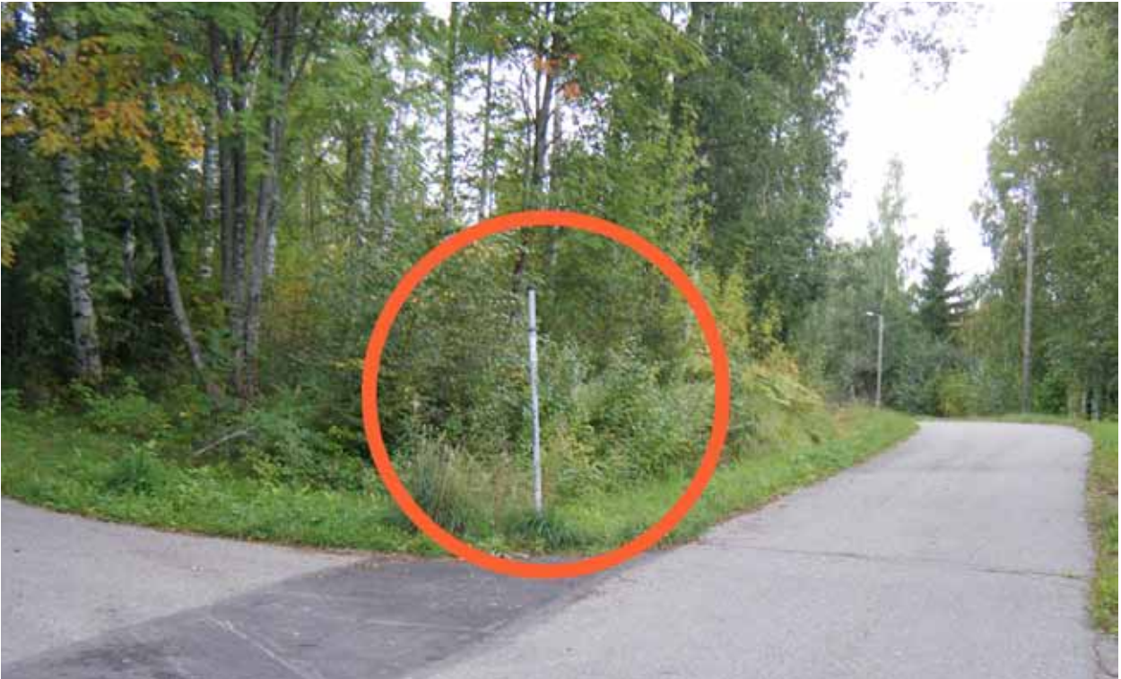
Kuva 3. Tolppa, josta puuttuu liikennemerkki.
