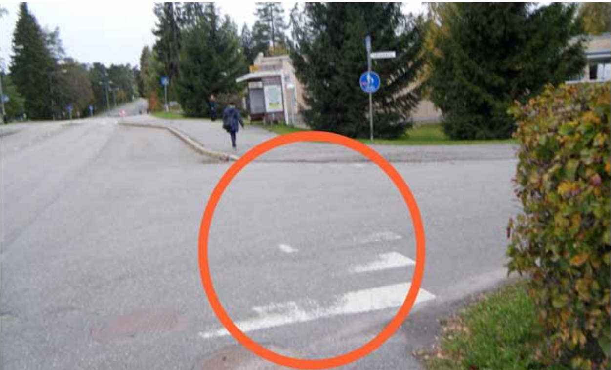
Kuva 128. Pyörätien jatke puuttuu.
