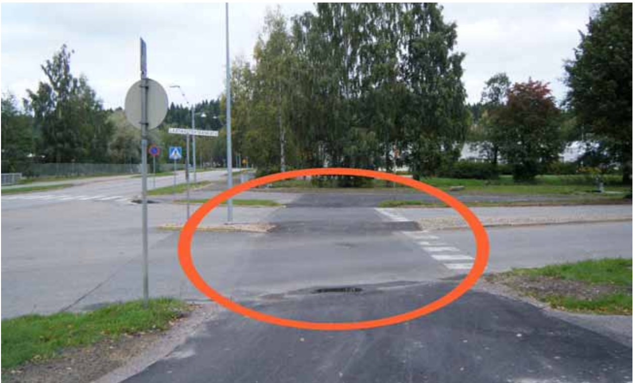
Kuva 54. Pyörätien jatke puuttuu.
