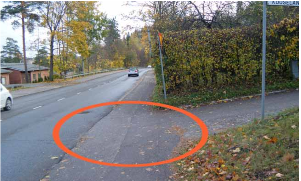
Kuva 154. Pyörätien jatke puuttuu.
