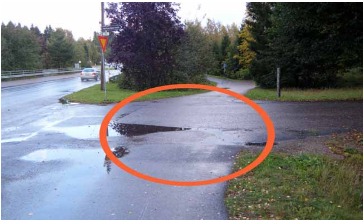
Kuva 94. Pyörätien jatke puuttuu.
