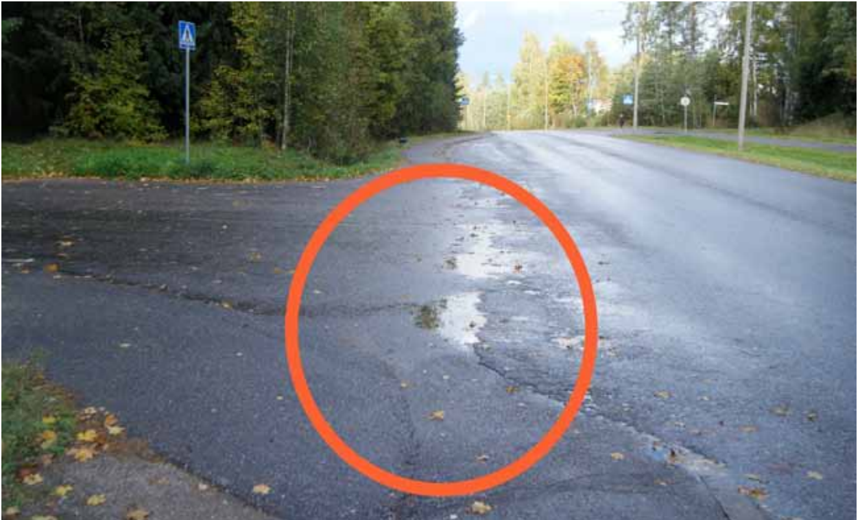
Kuva 101. Pyörätien jatke puuttuu.
