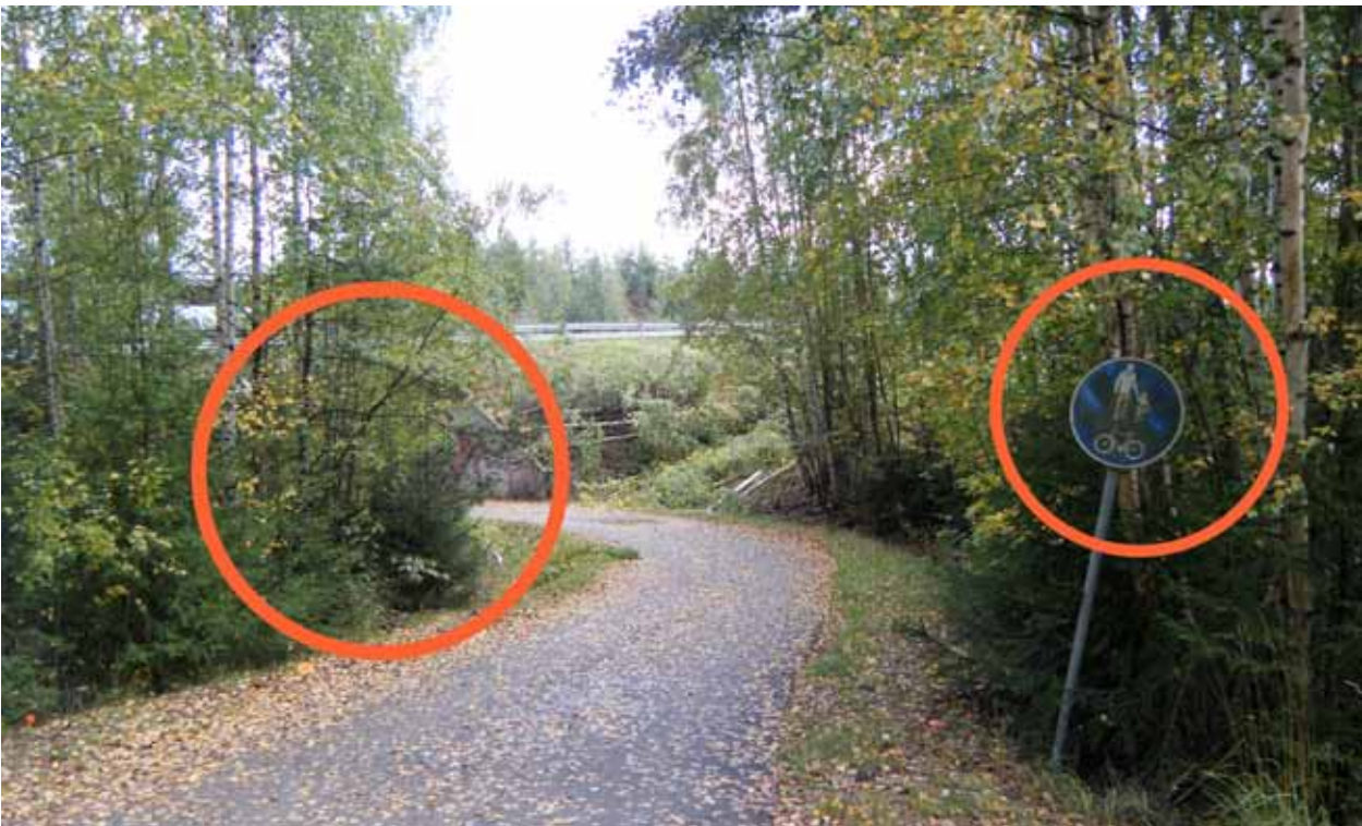
Kuva 68. Alikulkutunnelin suuaukon edessä oleva kasvillisuus peittää näkemäalueen. Huonokuntoinen yhdistetyn kevyenliikenteenväylän liikennemerkki.
