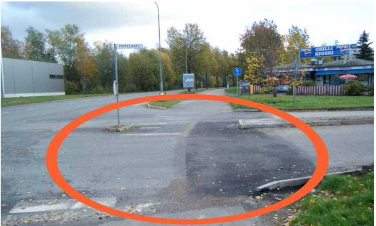
Kuva 146. Pyörätien jatke puuttuu.
