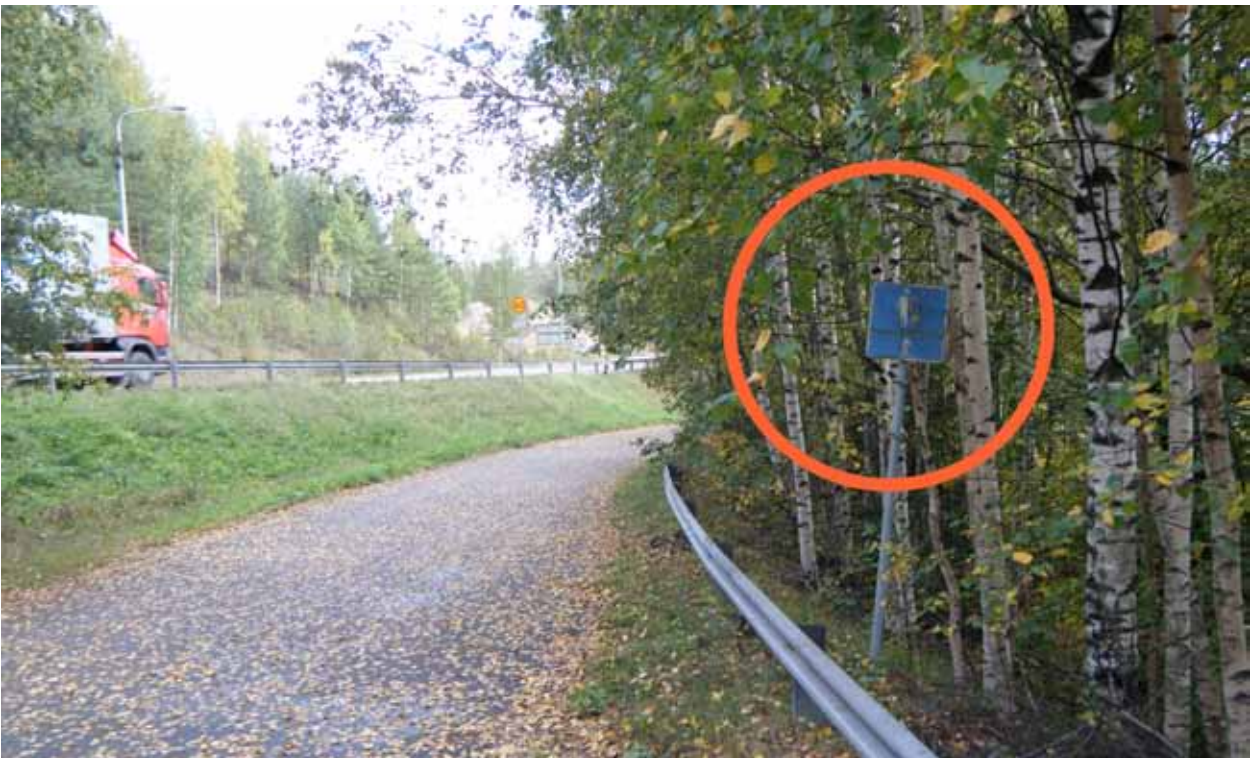
Kuva 64. Huonokuntoinen ja poikkeava yhdistetyn kevyenliikenteenväylän liikennemerkki.
