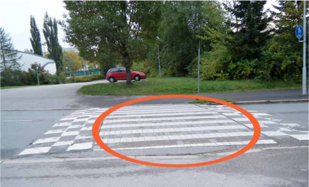
Kuva 135. Pyörätien jatke puuttuu.
