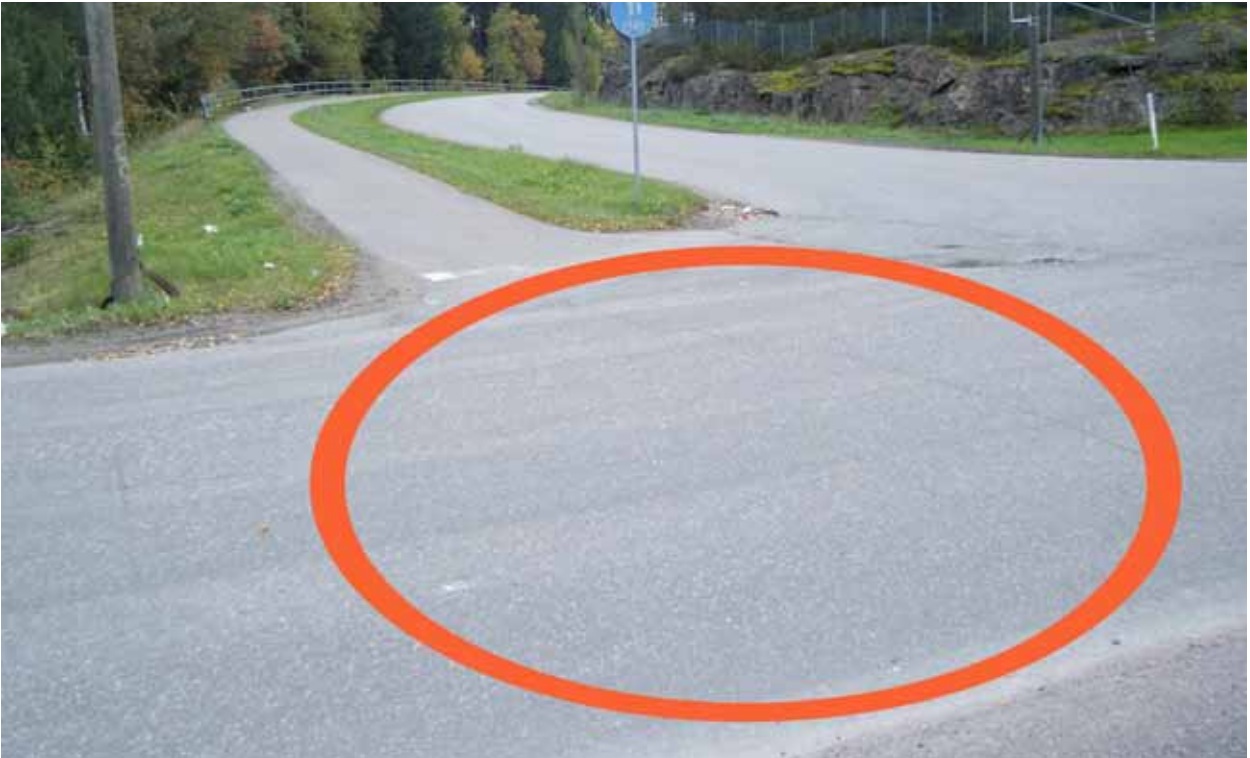
Kuva 119. Pyörätien jatke puuttuu.
