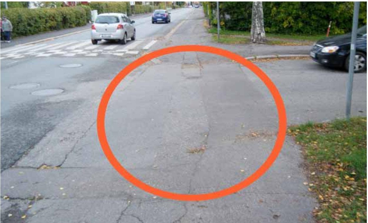
Kuva 136. Pyörätien jatke puuttuu.
