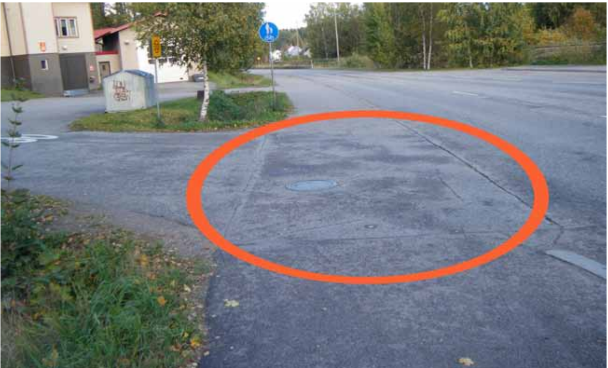
Kuva 108. Pyörätien jatke puuttuu.
