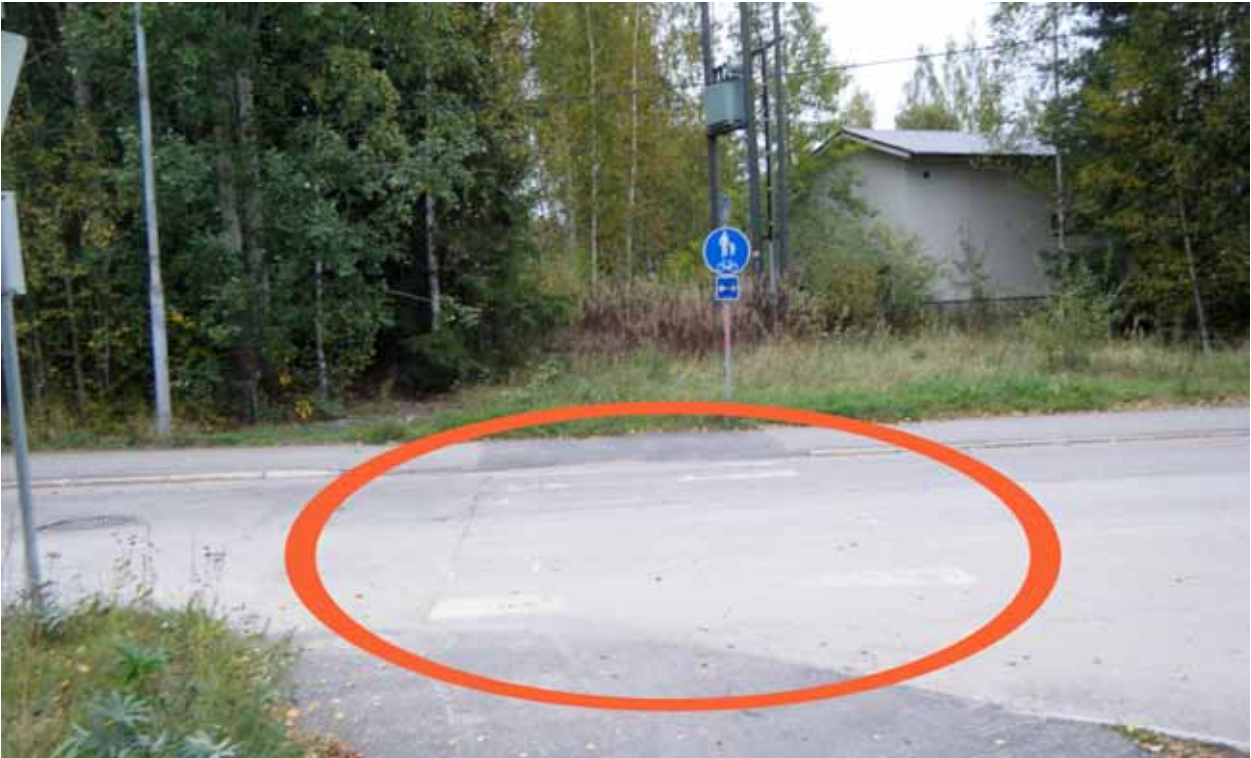
Kuva 47. Pyörätien jatke puuttuu.
