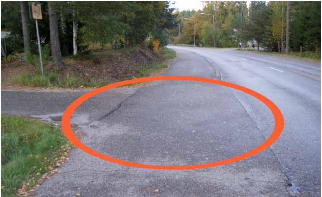
Kuva 113. Pyörätien jatke puuttuu.
