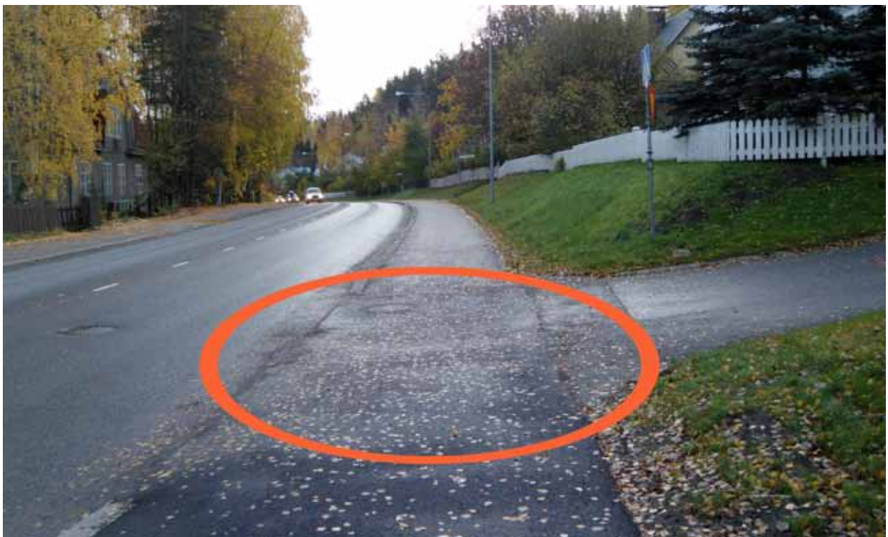
Kuva 158. Pyörätien jatke puuttuu.
