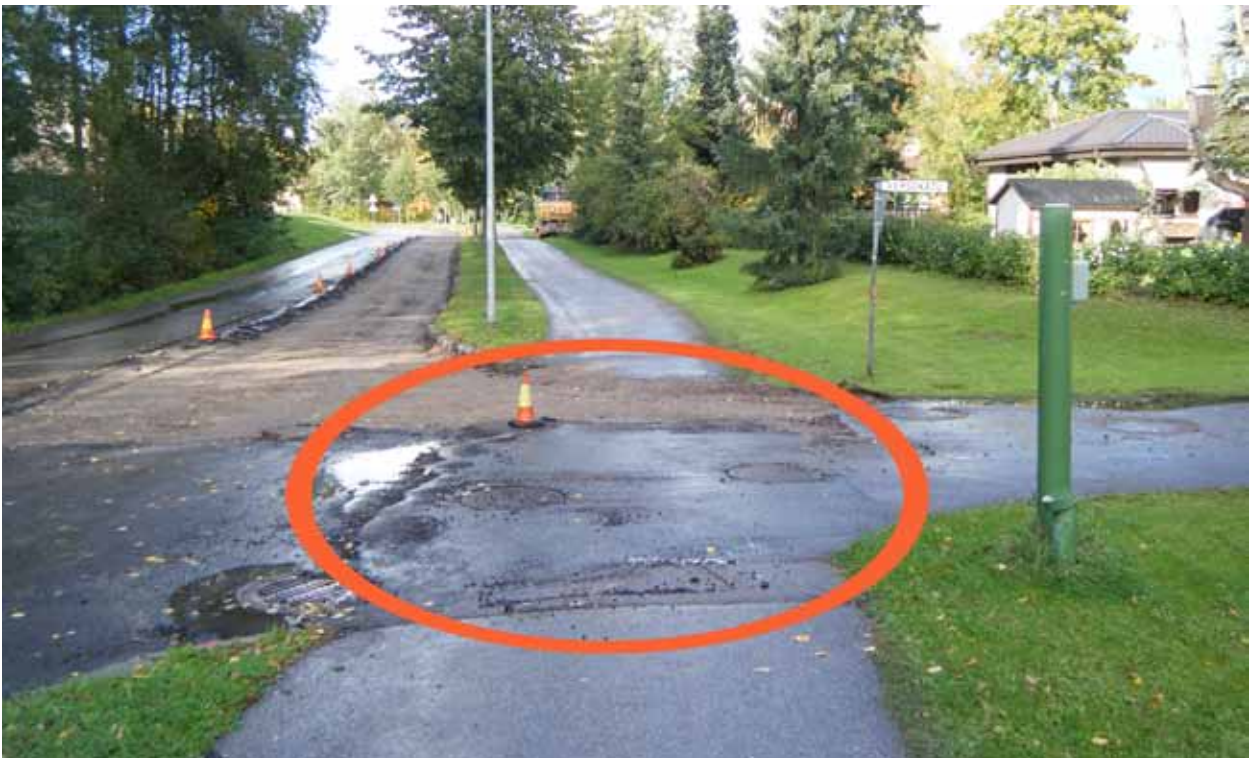
Kuva 82. Pyörätien jatke puuttuu.
