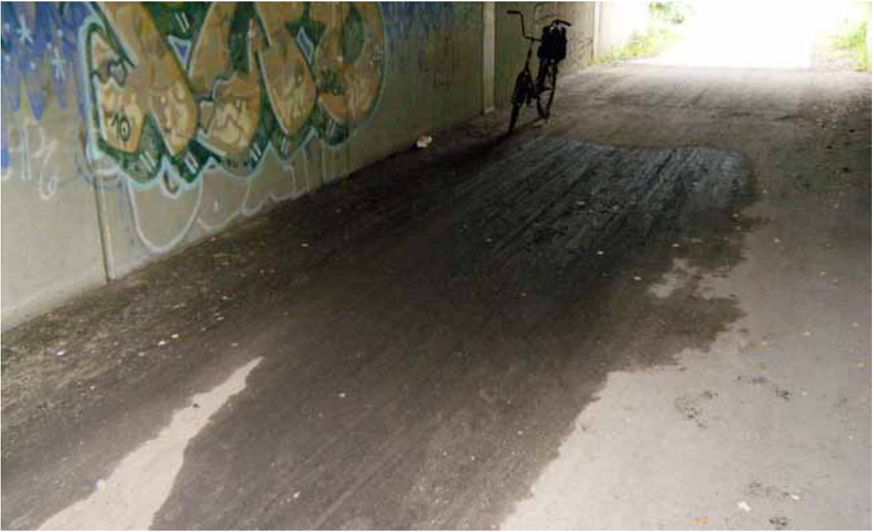
Kuva 3. Alikulcutunnelin pohjalle kerääntynyt mutaa sadevesien mukana.
