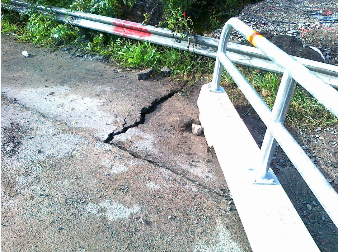
Kuva 17. Kevyen liikenteen väylä halkeilee
