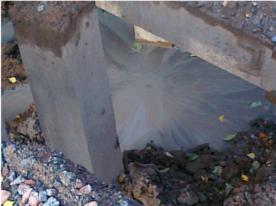
Kuva 4. Siltti ja hiekka nousivat kaivannon pohjalle pohjaveden mukana.
