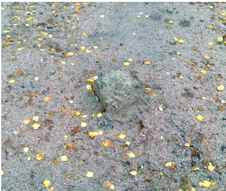
Kuva 6. Paalu tunkeutui väliaikaisen tierakenteen läpi.
