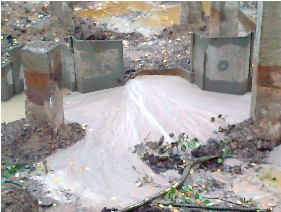
Kuva 5. Pohjavesi nousee teräspontin kylkeä pitkin.
