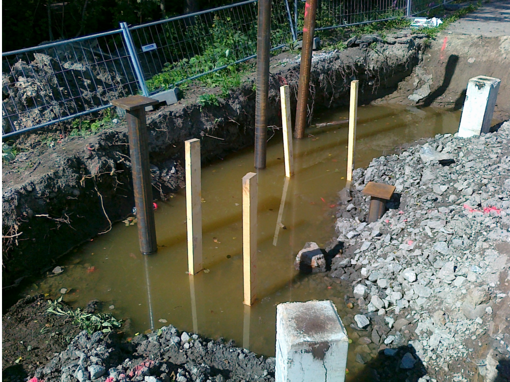
Kuva 25. Vesijohdon kaivanto täyttyi vedellä usein.
