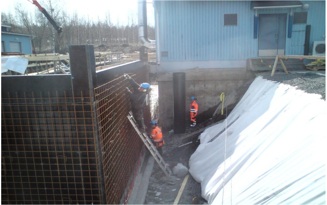
Kuva 11. Kuvassa näkyvät siniset pisteet muotissa ovat tulppia, joiden avulla estetään betonin pääseminen muottisiteille tarkoitettuihin läpivienteihin. Kuva Savo-Karjalan Vesihuolto Oy.
