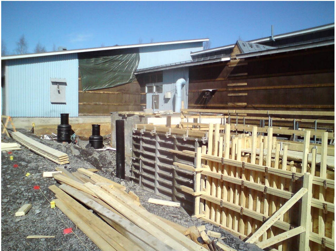
Kuva 6. Kuvassa kasettimuotin ja vanerimuotin liittymäkohta. Kuvassa on hyvin havaittavissa vaakasuojet, vinotuenta maapenkereeseen sekä muottilukkoja. Kuva Savo-Karjalan Vesihuolto Oy.
