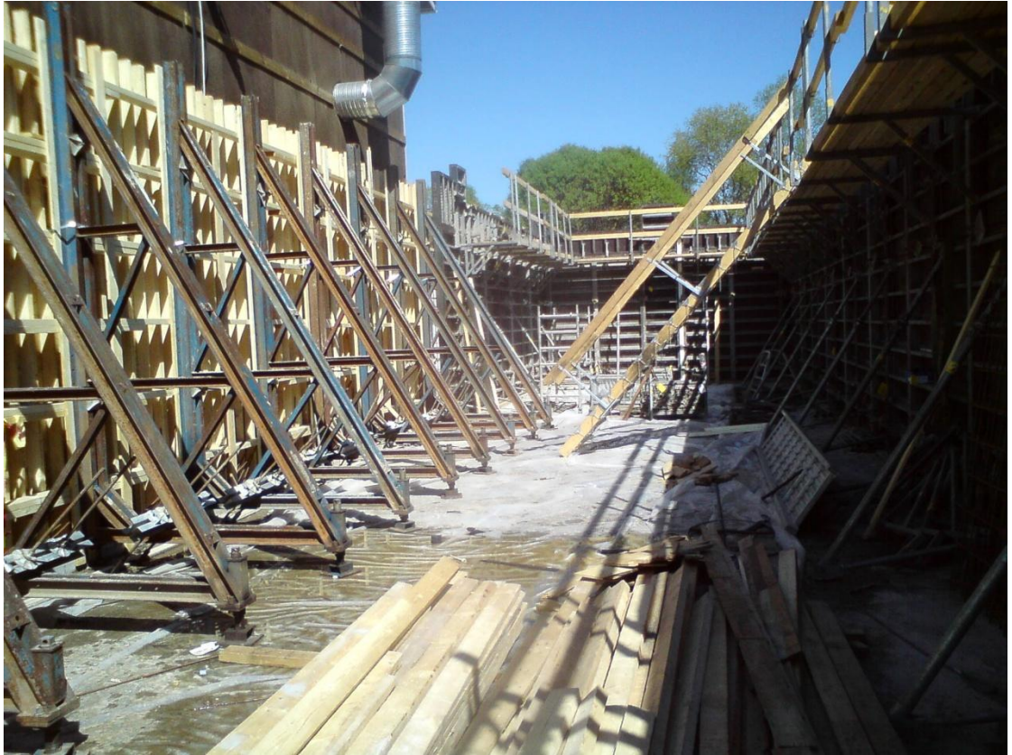
Kuva 13. Kuvassa oikealla valmista kasettimuottia, joka on tuettu pystyyn altaan lattiasta. Kuva Savo-Karjalan Vesihuolto Oy.
