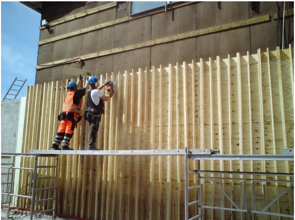
Kuva 4. Kuvassa on vastavaluseinän vanerimuotti, jossa on helposti nähtävissä vanerimuotin pystytuenta sekä ns. siivut 1 220 mm välein. Kyseisessä muotissa on käytetty 1 220x1 220 mm:n kokoisia vanerilevyjä. Kuva Savo-Karjalan Vesihuolto Oy.
