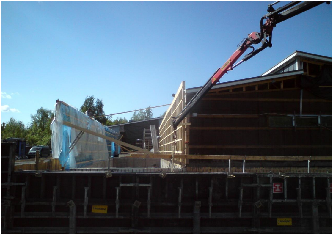
Kuva 18. Kuvassa on nähtävissä hyvin kasettimuotin muottilukkoja ja muottisiteitä. Muottilukot ovat hieman erilaisia kuin BFD –lukot, vaikka toimintaperiaate on sama. Kuva Savo-Karjalan Vesihuolto Oy.
