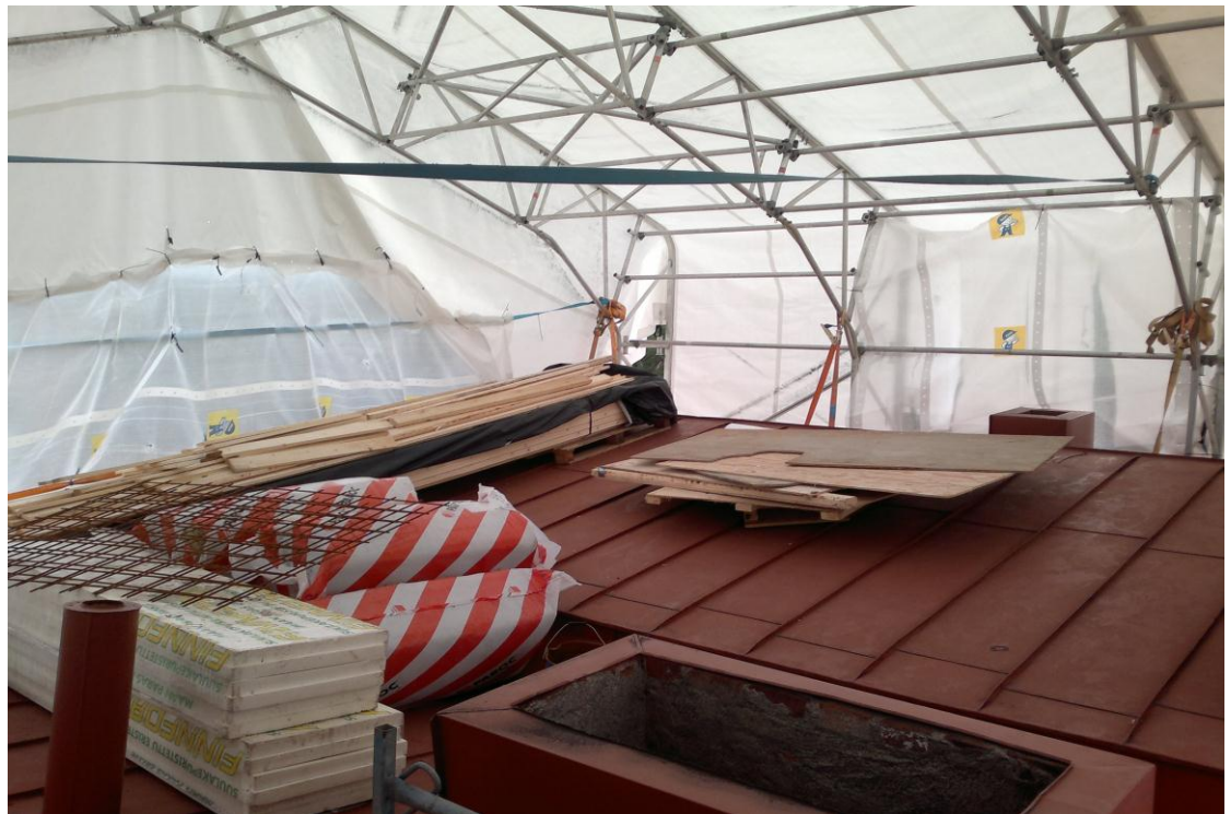
Kuva 4 Telinerami, Kederkatos. Kuvassa katos pystytettynä kerrostalon katolle. Kuvan otto hetkellä on talvi, mutta katoksen sisällä on hyvät työskente-lyolosuhteet. Kuva Harri Vääntinen, 2011
