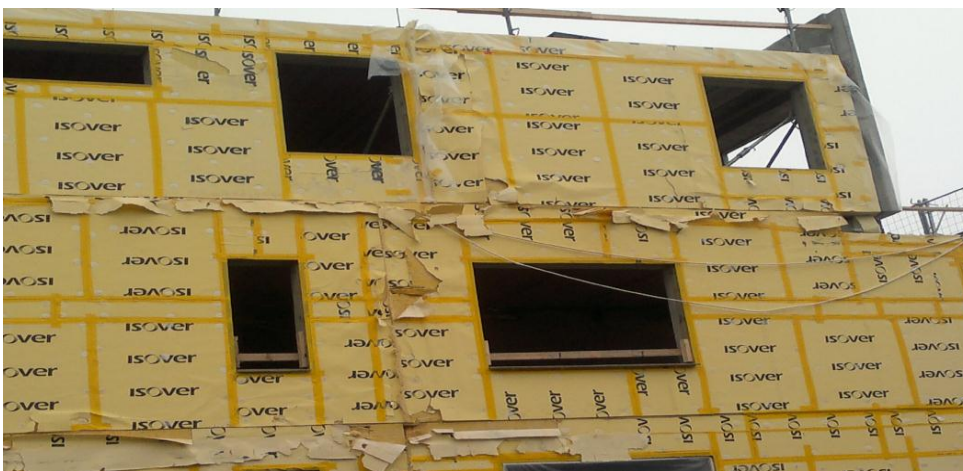
Kuva 2. Tyypillinen tilanne kerrostalotyömaalla. Lämmöneristeiden puutteellista suojausta sääolosuhteita vastaan. Kuva Harri Vääntinen, 2011
