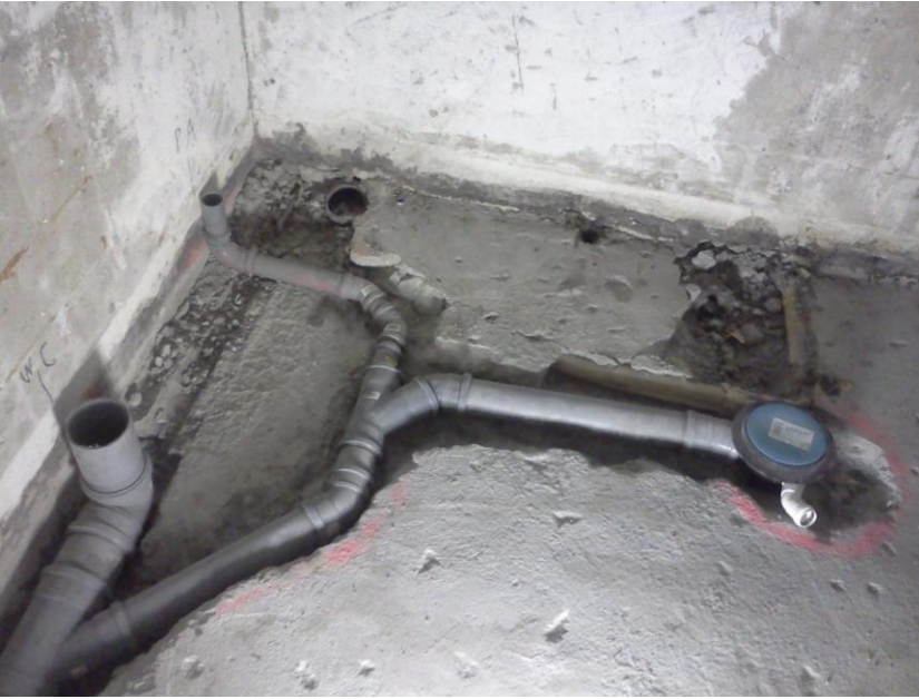
Kuva 2. Kylpyhuoneen viemärihajotukset. Kuva: Timo Soininen
