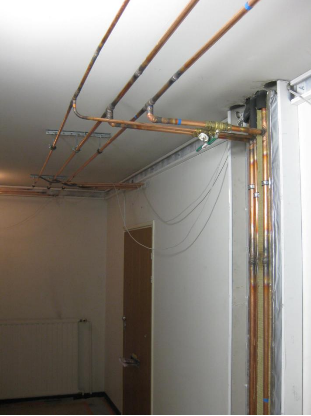
Kuva 7. Porrashuoneeseen sijoitetut vesijohdot.
