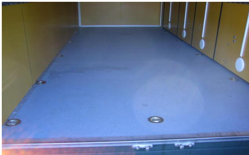
KUVA 10. Räjähdetarvikevaraston lattia on päällystetty staattista sähköä poistavalla matolla (Kuva Morehouse Oy)
