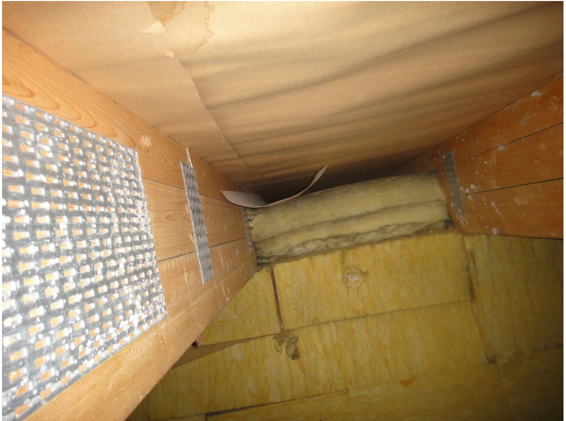
Kuva 6. Puutteellinen tuuletusväli, Case 1, päärakennuksen yläpohja, kuva Olli Suominen, 2011
