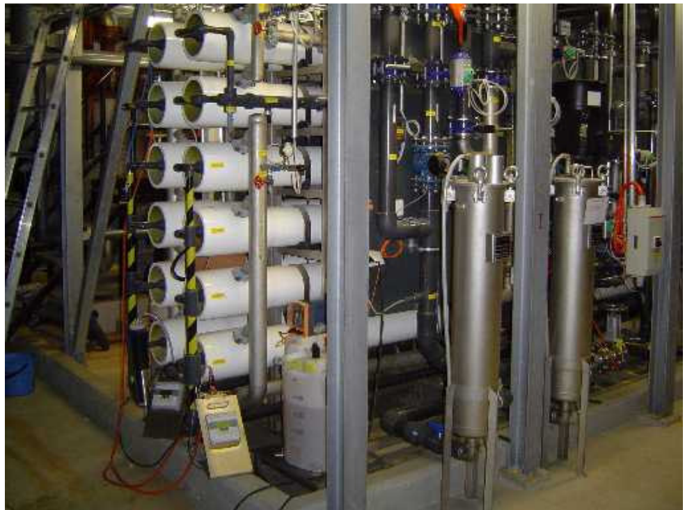
Kuva 11. Suomenojan voimalaitoksen käänteisosmoosikoneikko
