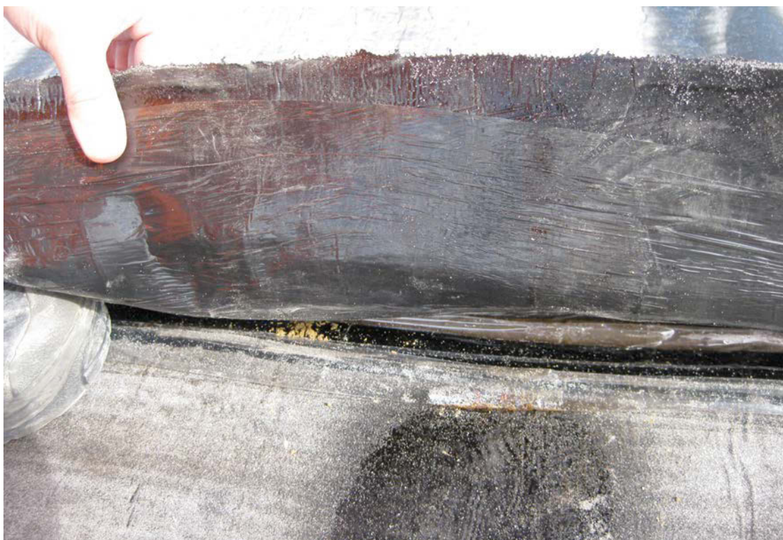
KUVA 25. Lähikuva saumasta; jopa geomembraanin alapinnan ohut muovikalvo on vielä tallella (Nousiainen. 2010)
