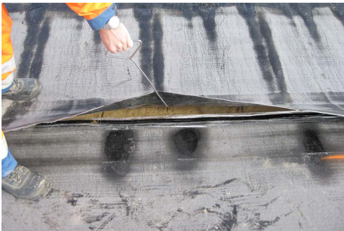
KUVA 24. Geomembraanien välinen sauma kokonaan auki (Nousiainen. 2010)
