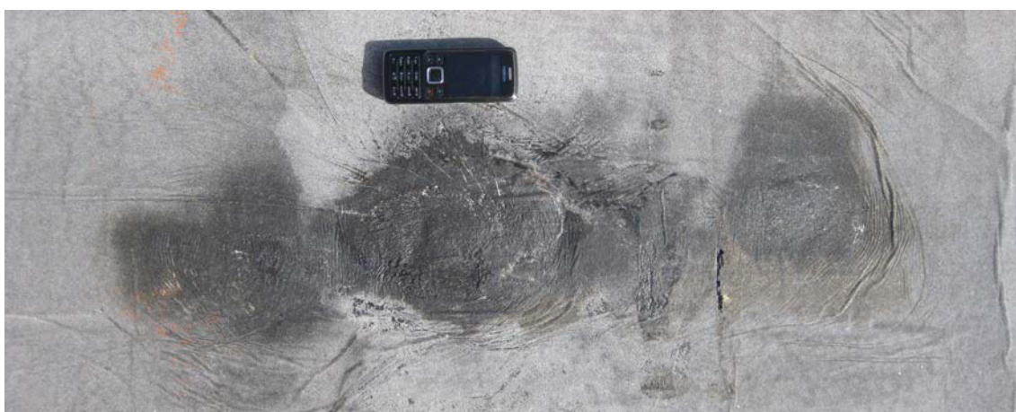
KUVA 28. Poikkeama geomembraanin päätyosassa (Nousiainen. 2010)
