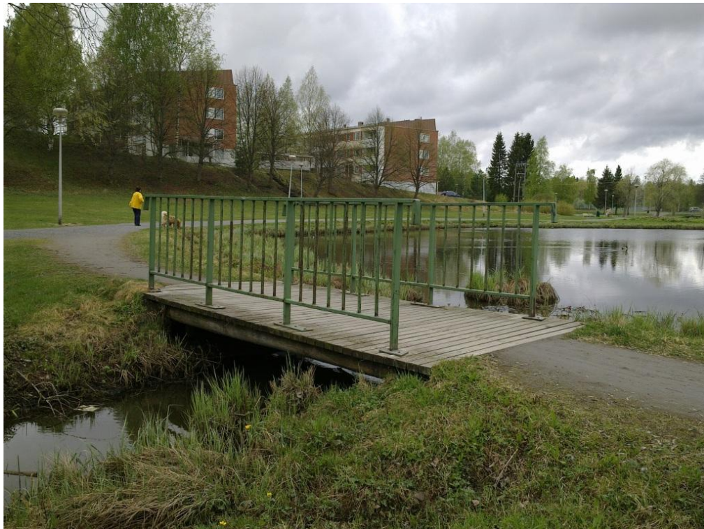
Kuva 14 Sillat kaipaavat kunnostusta. A-M Pohja.
