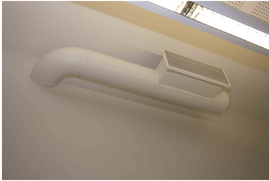
KUVA 27. Häiritsevää ääntä tuottava päätelaite luokkahuoneessa E120
