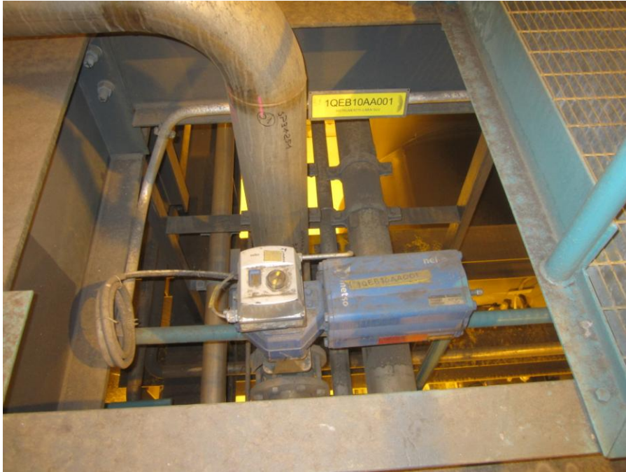
Kuva 12. Instrumentti-ilman sulkuventtiili, 1QEB10AA001 (Risto Judin)
