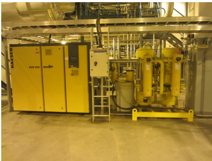
Kuva 11. Turbiinisalin kompressoriyksikkö ja kuivausyksikkö (Risto Judin)
