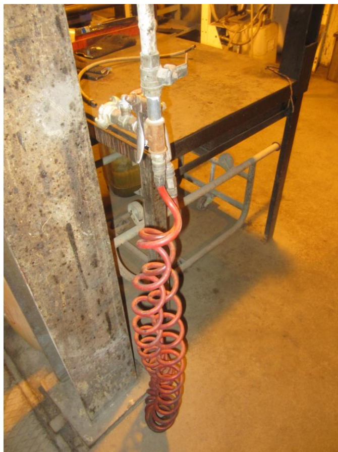
Kuva 6. Öllyvoimalaitoksen 2. kerroksen paineilmatyöpiste (Risto Judin)
