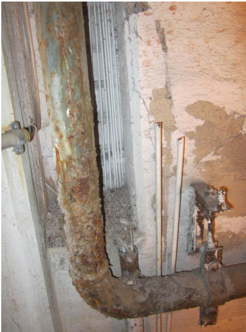
Kuva 7. Työkaluilmalinjan putki, 2. turbiinisali (Risto Judin)
