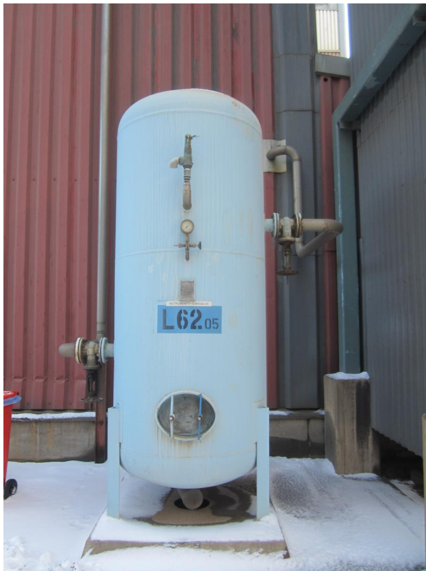
Kuva 8. Pyroflow- kattilalaitoksen paineilmasäiliö (Risto Judin)
