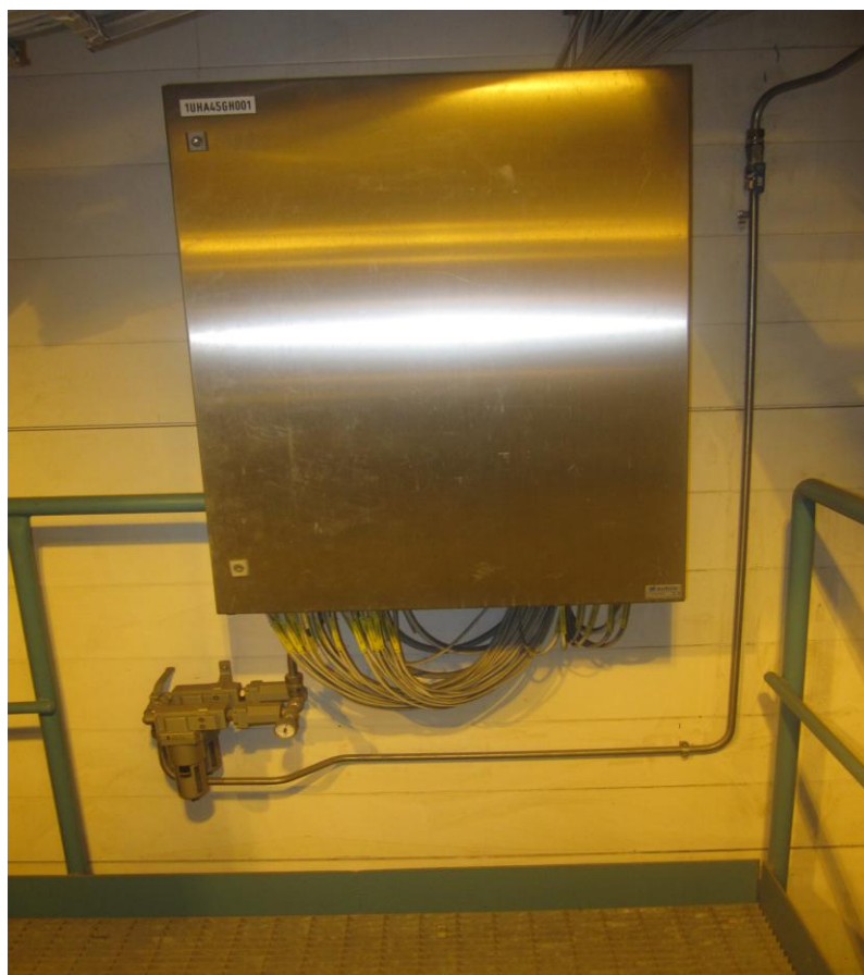
Kuva 13. Toimilaittekaappi (Risto Judin)
