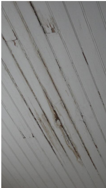
Kuva 24. Luokkahuoneen sisäkatossa kattovuodon aiheuttamia kosteusvaurioita. (Talka 2012)
