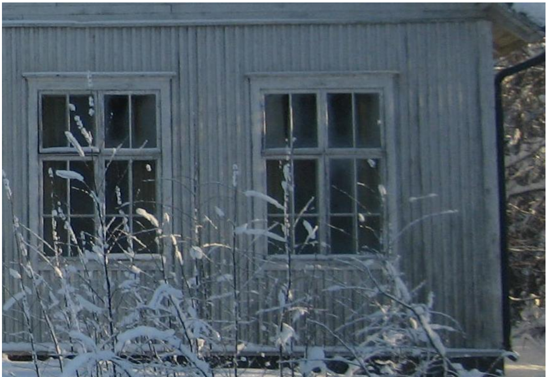
Kuva 18. Maalipinnassa on pintahometta (Talka 2012)
