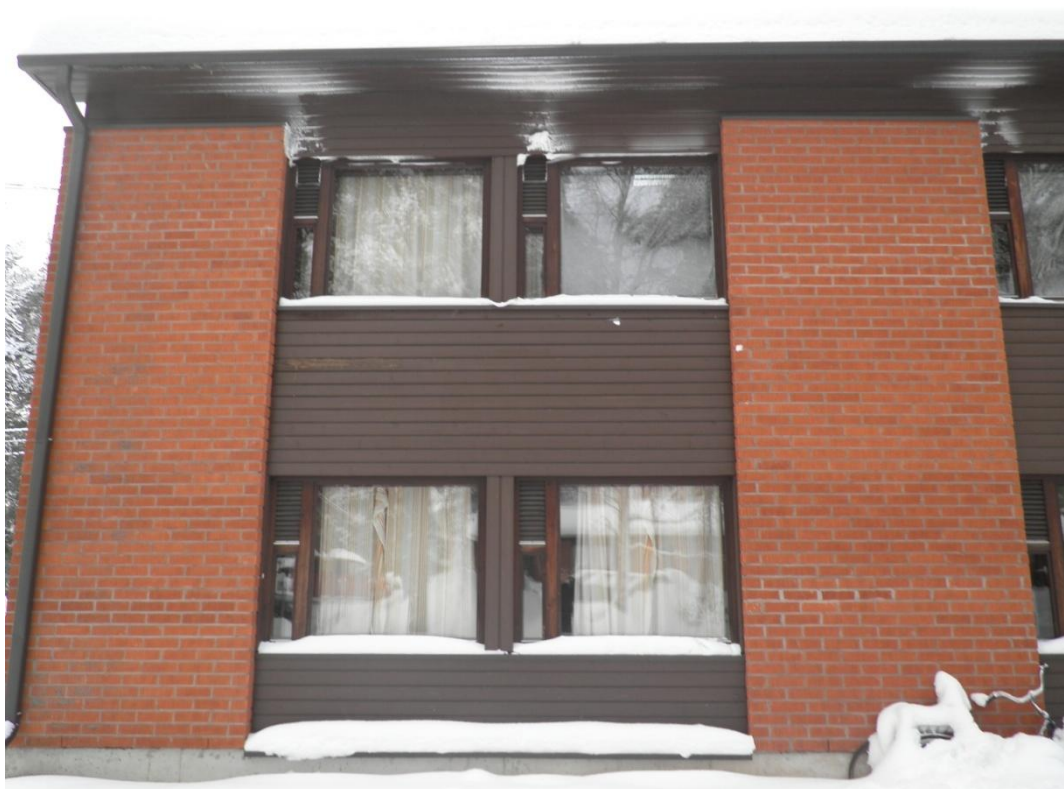
Kuvio 5. Ikkunoiden tuloilmaventtiilit ulkoapäin
