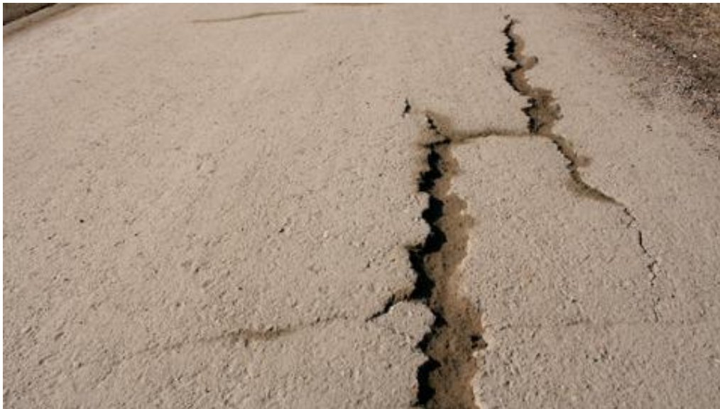
KUVA 2 Routavaurio kadun päällysteessä (Kuva: Tiina Bragge)
