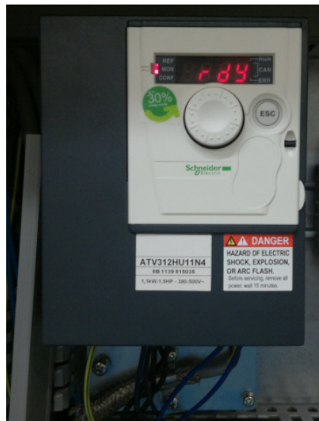
KUVIO 36. Taajuusmuuttaja asennettuna ja valmiina ohjaamaan moottoria.
