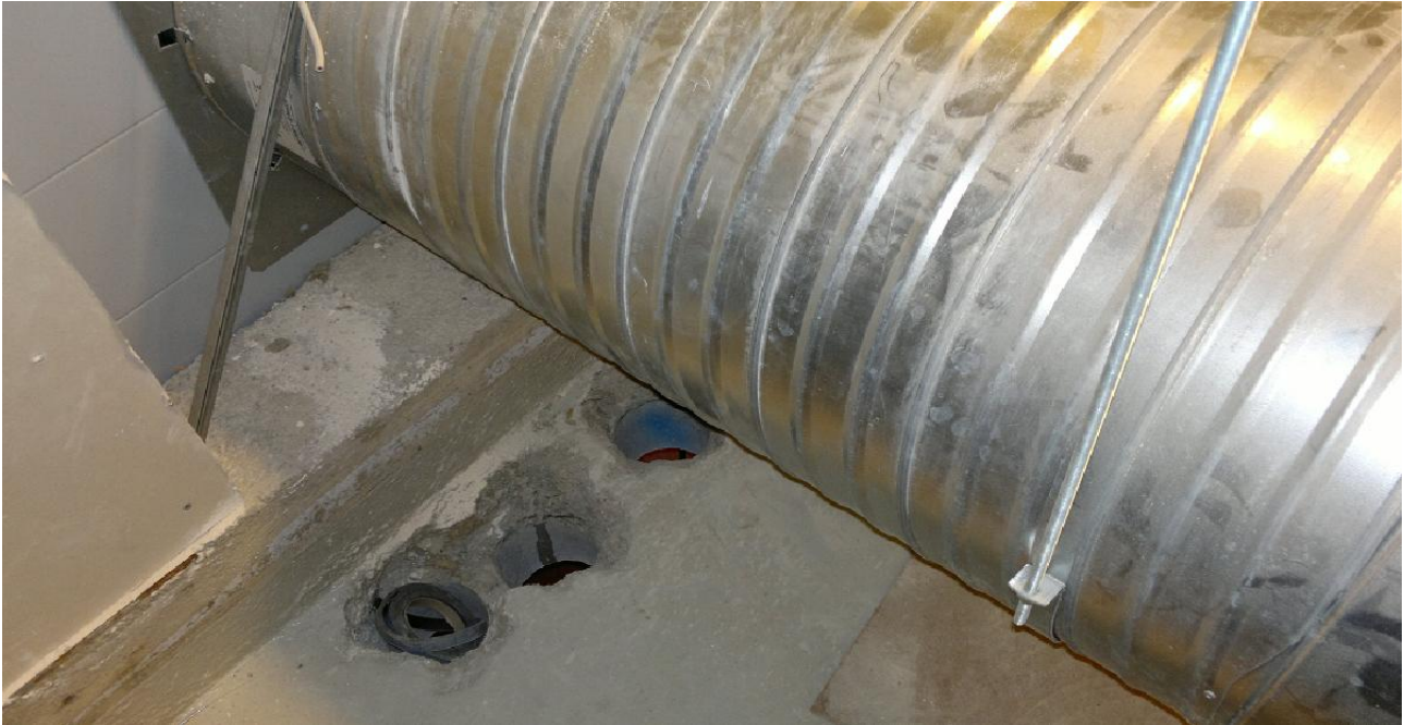
Kuva 9. Ristiriitaiset läpiviennit ilmastoinnille sekä vesiputkille
