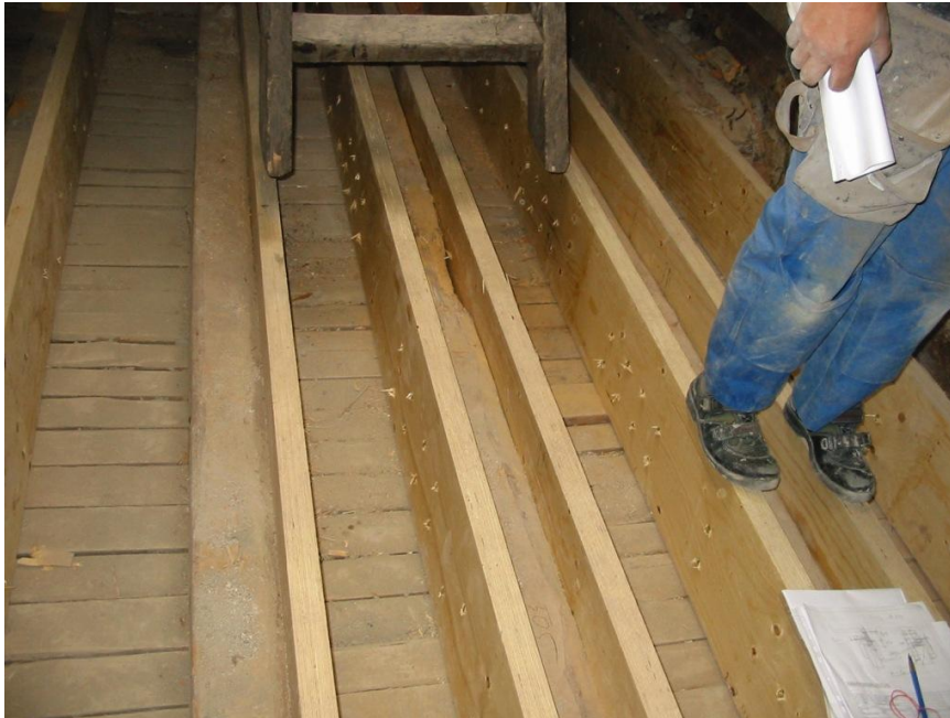
Kuva 34. Vanhojen kantavien puupalkkien kylkiin kiinnitetyt kertopuiset vahvistuspalkit (Insinööritoimisto R J Heiskanen Oy, 2005)
