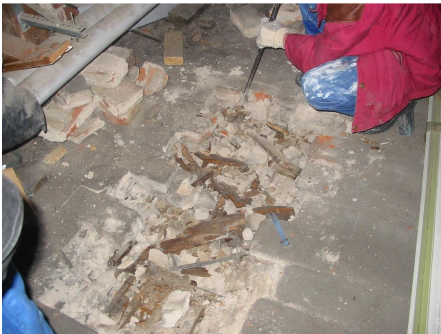
Kuva 32. Tiilipalopermannon alapuoliset lahonneet laudoitukset (Insinööritoimisto R J Heiskanen Oy, 2005)
