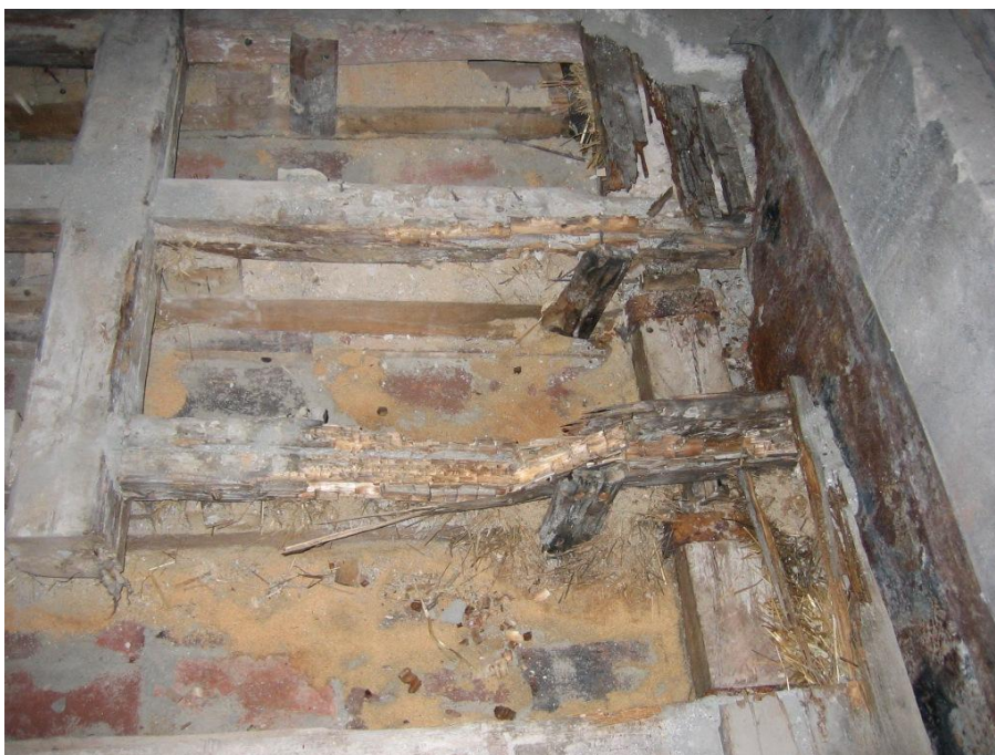
Kuva 33. Puuyläpohjan lahonnut puukoolaus (Insinööritoimisto R J Heiskanen Oy, 2005)
