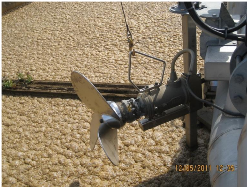
KUVA 2. Sekoitin täyttymässä olevassa ilmastusaltaassa.
