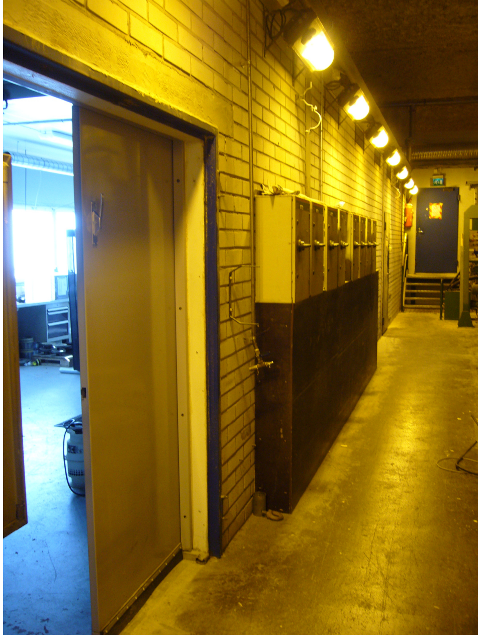
KUVIO 16. Linjan vasen sivu, Terähuoneen seinä ja sähkökeskukset
