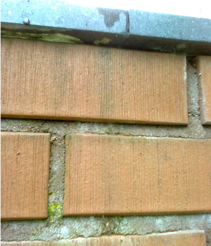
Kuva 6 Kuvassa on kuvan 3 takimmaisesta muurista toinen puoli. Kansikivien välinen tila on selvästi liian pieni elementtikittausta varten.
