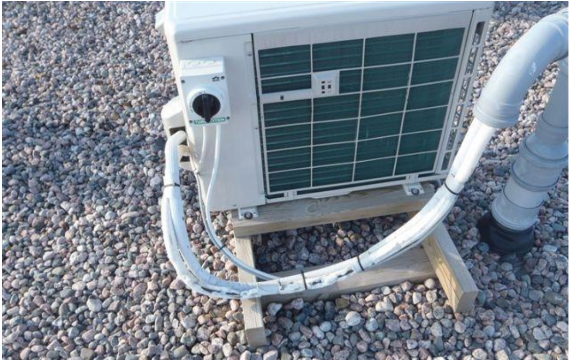
Kuva 12 Lauhduttimen putken eristeet ovat enää vain osassa putkea
