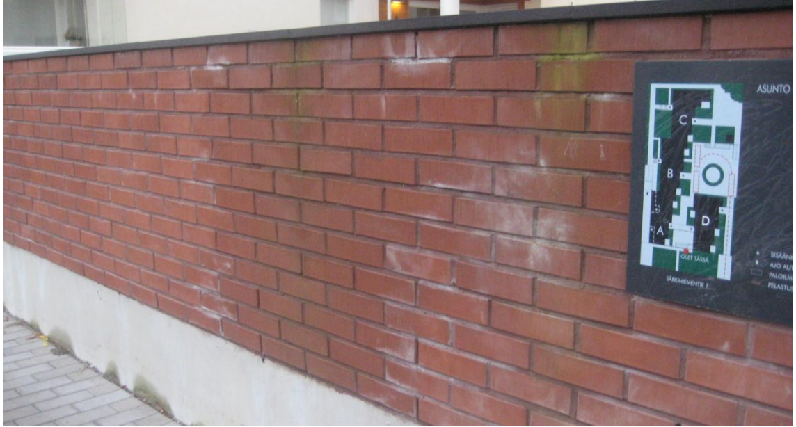
Kuva 8 Kuvassa näkyy veden rakenteisiin pääsemisen vaikutukset.
