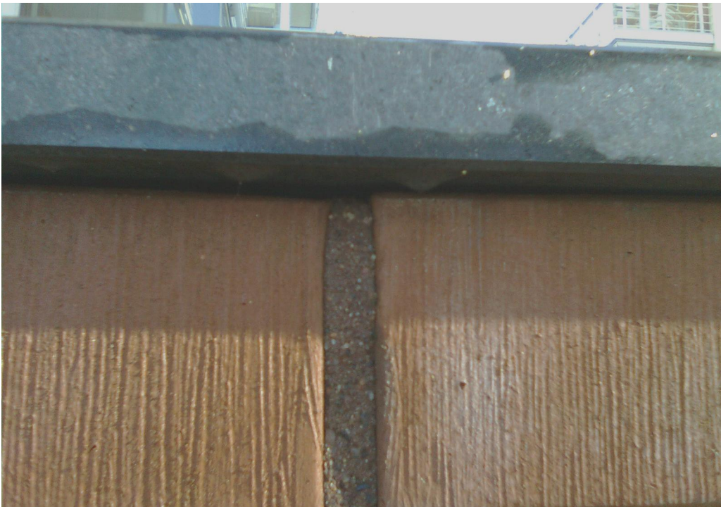
Kuva 7 Kansikiven alla näkyy kosteutta, vesitippoja ja kansikiven vähäinen muurin ylimeneminen.
