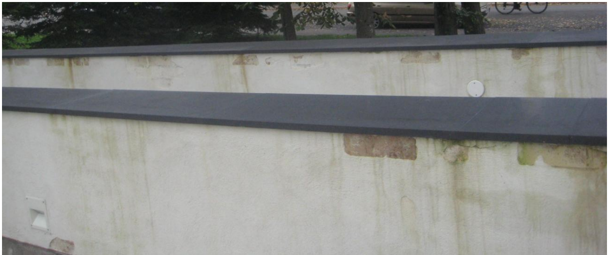
Kuva 5 Muurista on selvästi irronnut rappaus. Takimmaisessa muurissa vasemmalla näkyy selkeitä valumajälkiä saumojen kohdilla ja oikealla valumia näkyy koko matkalta.
