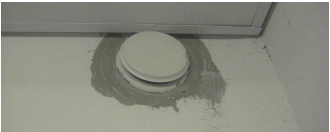
Kuva 14 Tuuletusventtiilin ympäryks on tiivistetty liian myöhään.
