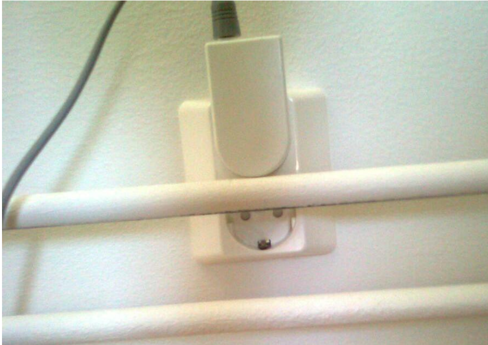
Kuva 10 Pistorasia on sijoitettu patterin putkien taakse. Vika korjattiin vuosikorjauksissa
