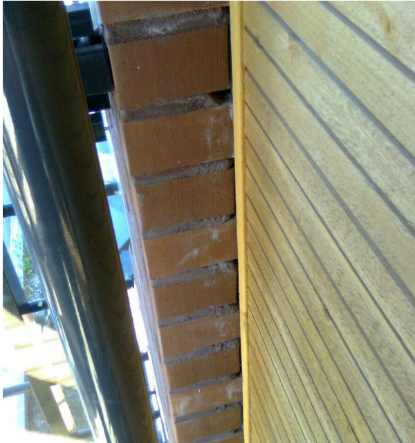
Kuva 13 Muurauslaasti on jäänyt selvästi vajaaksi parvekkeen paneelien vierestä.
