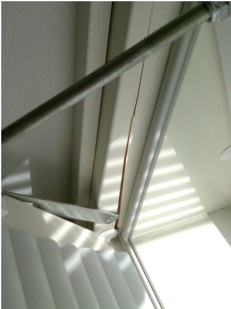
Kuva 4 Tuuletusikkunan haljennut karmi
