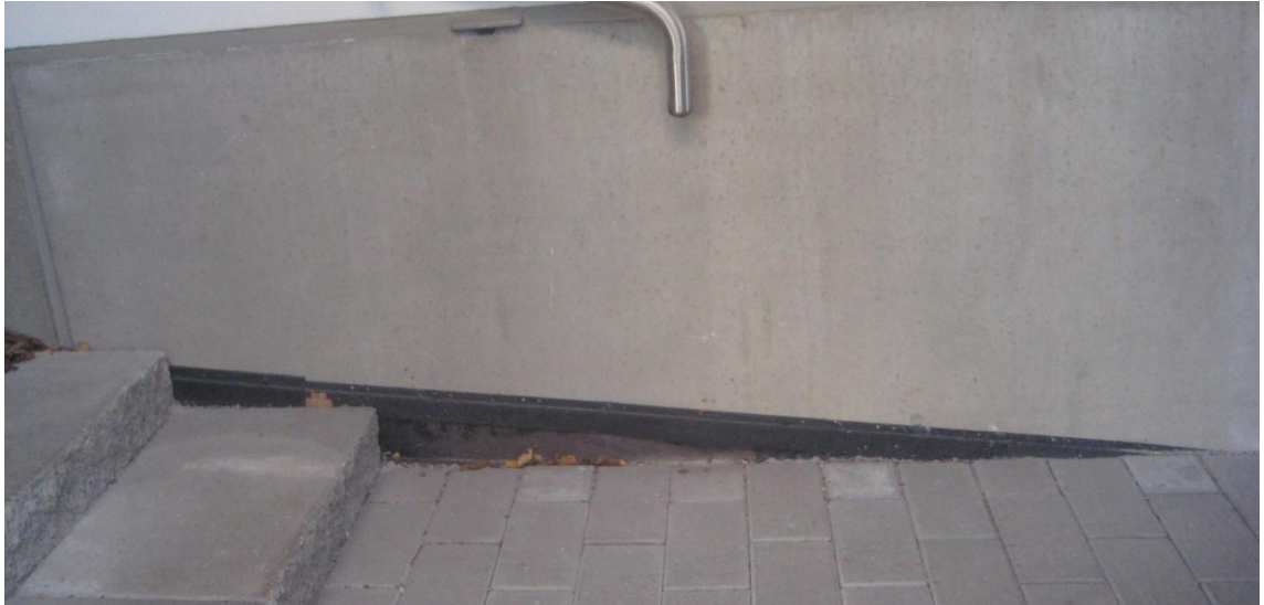
Kuva 3 Sokkelin vesieriste on jäänyt näkyville
