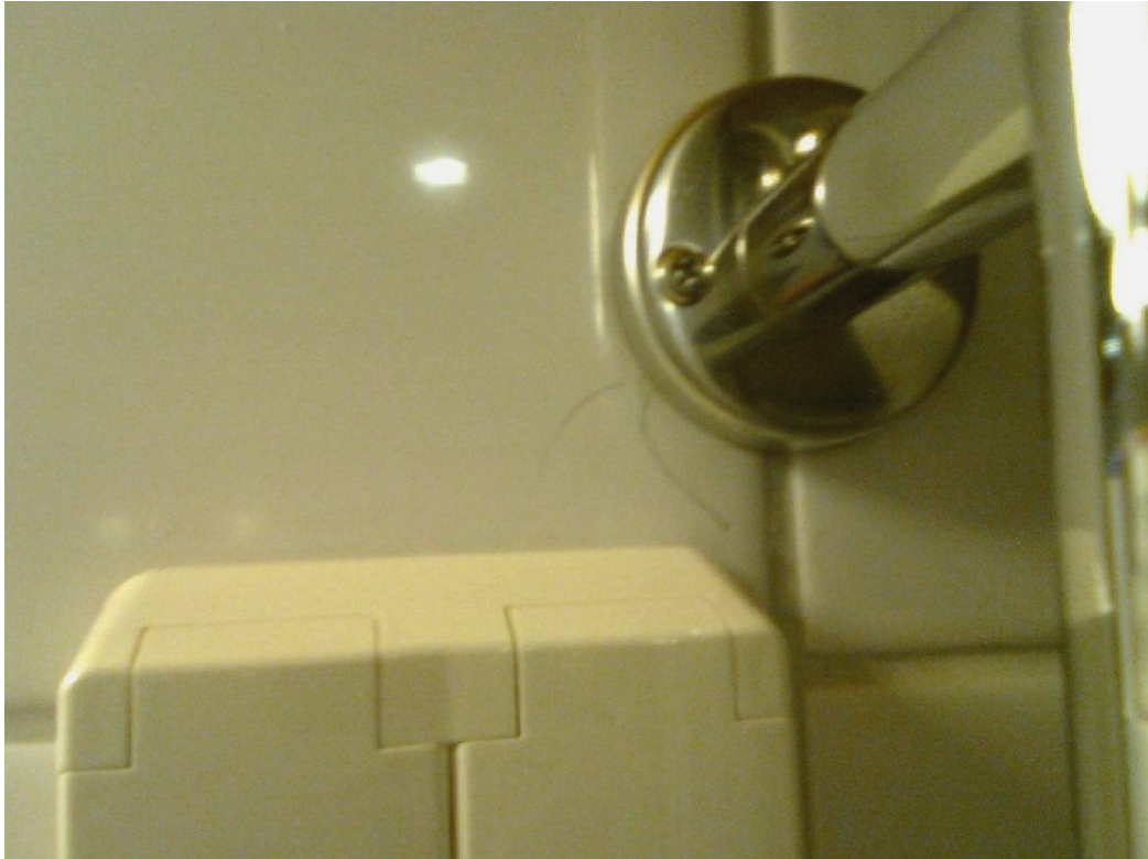
Kuva 2 Kuivauspatterin kiinnityksestä johtuva kaakelin halkeaminen
