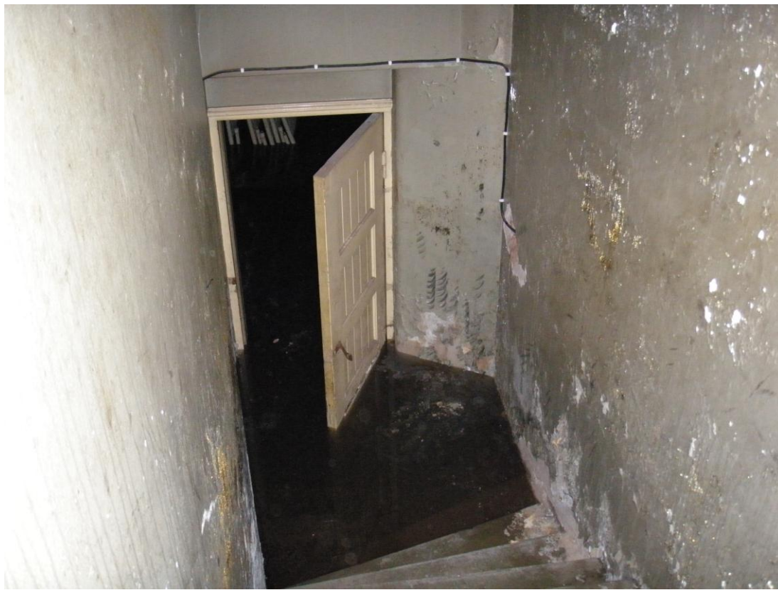
Kuva 11. Kellariin noussutta pohjavettä (kuva Riitta Takala)
