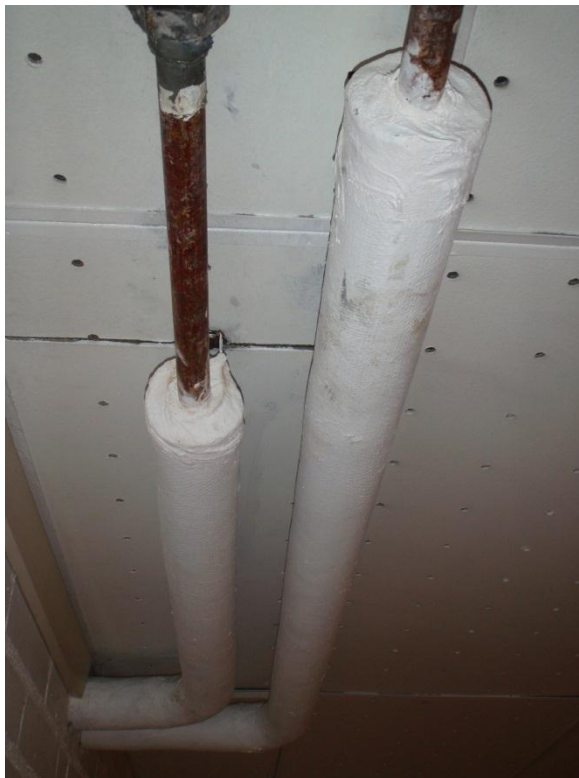
Kuva 6. Asbestia putkien eristeenä
