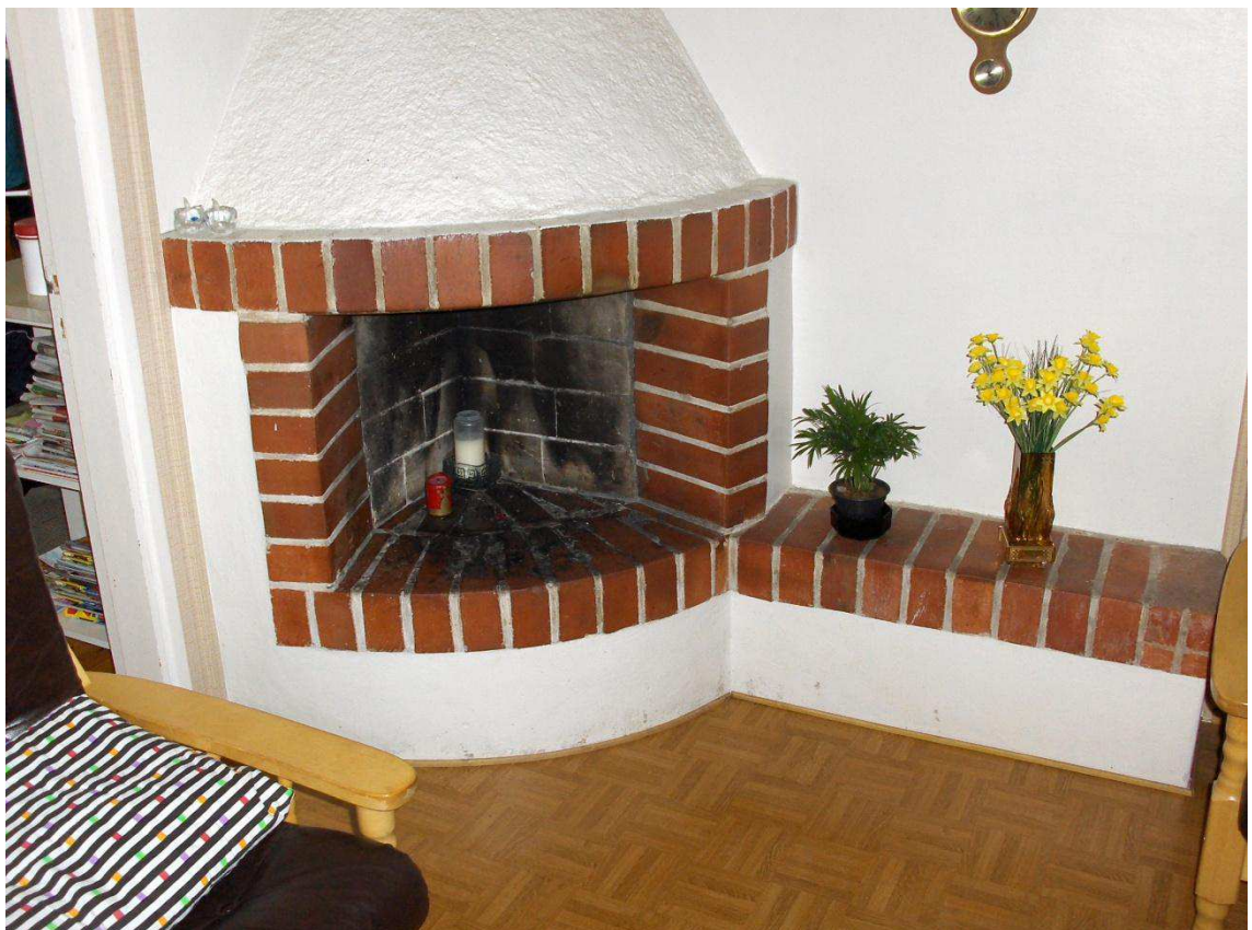
KUVA 9. Olohuoneessa sijaitseva avotakka, joka toimii pääasiallisena ilmastointihormina painovoimaisessa ilmanvaihdossa
