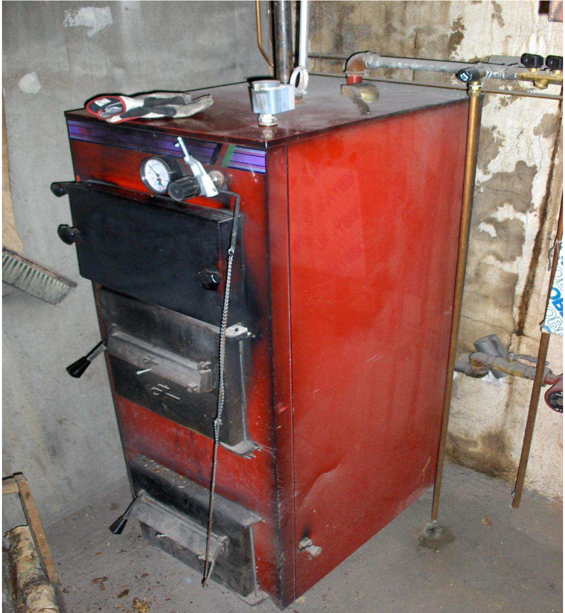
KUVA 8. Uusi lämmityskattila, jossa myös sähkövastus suoraa sähkölämmitystä varten
