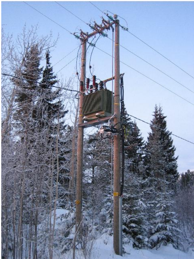
KUVIO 1. Vattenfall Verkko Oy:n sähköverkkoa (Vattenfall Verkko Oy).
