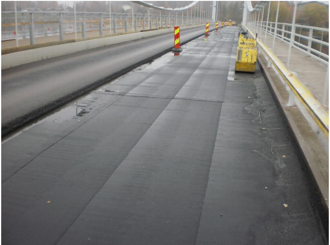
Kuva 3. Valmista kermieristystä. Lammikoituminen johtui riippusillan kallistumisesta. Sillan asentoa korjattiin valamalla vastapaino käytöstä poistuneelle kevyenliikenteen väylälle. Valokuva: Miika Riihimäki 2011.
