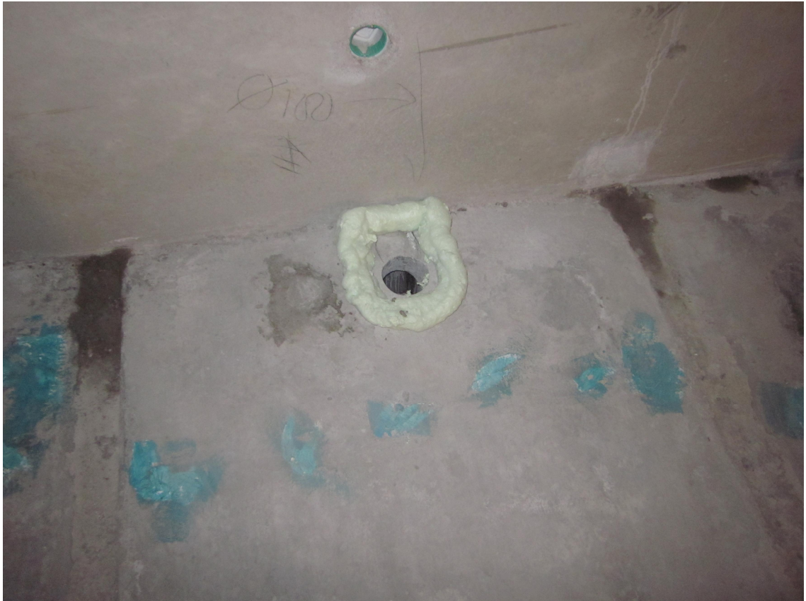
Kuvio 14. Poratulle läpiviennille on tehty eristevaahdolla toppari, koska viemäriputkea ei ole ehditty asentaa eikä läpivientä paikata.
