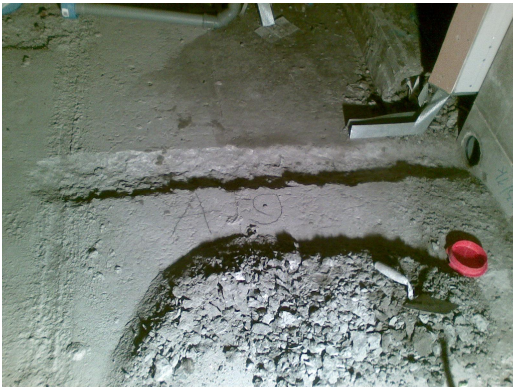
Kuvio 8. Viemäriputken liitoskohta on Elpo-hormissa niin syvällä kololaattaa nähden, että viemäriputkia varten kololaatan pohjaan on jouduttu piikkaamaan ura.
