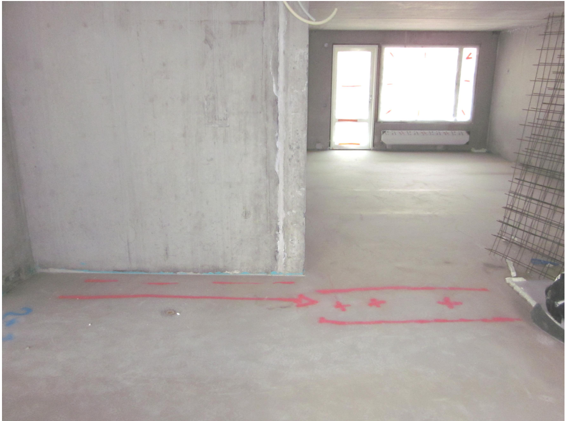
Kuvio 5. Valmiissa lattian tasoituksessa on seinän vierellä vuotokohta ja seinän oikealla puolella kovaksi jäänyt kaistale.
