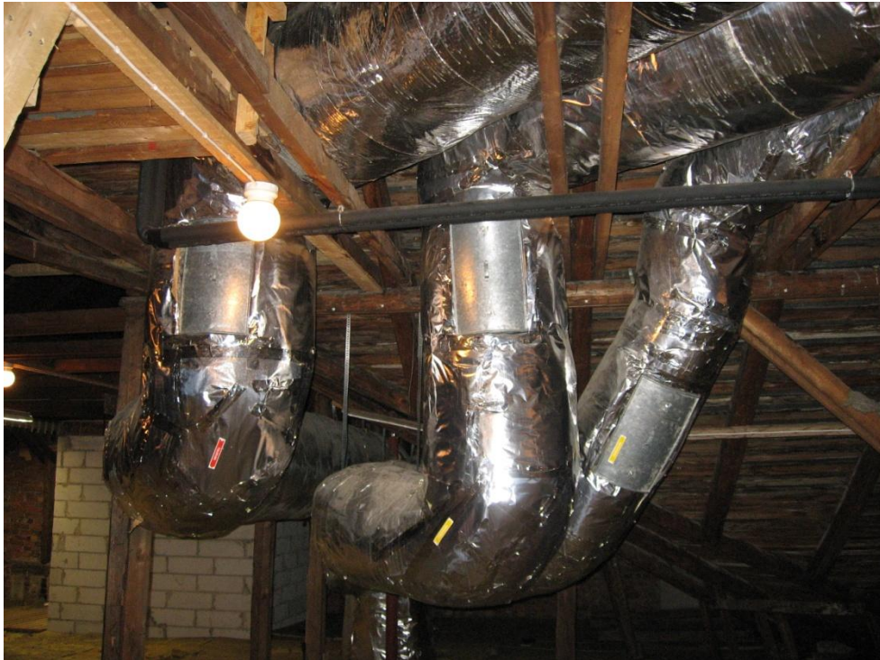
Kuva 3. Ullakolla kulkevia ilmanvaihtoputkia.
