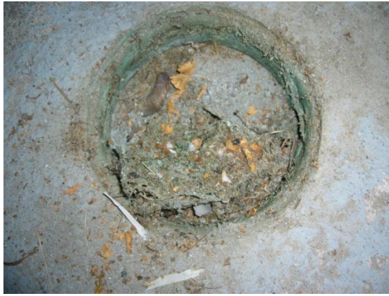
KUVIO 33. B-portaan takapihan portaikon alatason kaivo on tukossa
