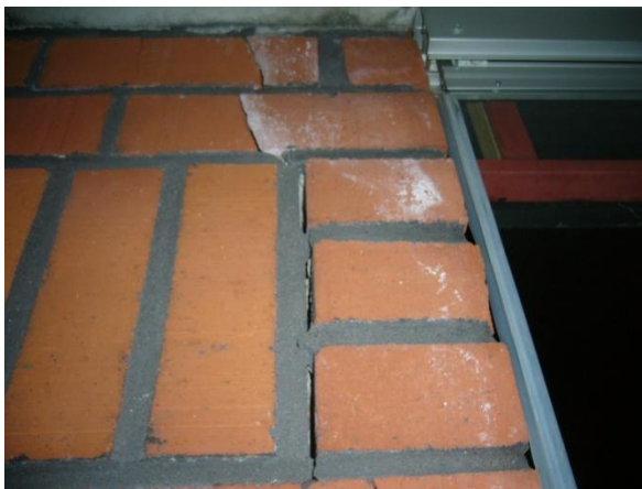
KUVIO 18. Tiiliverhouksessa on useiden huoneistojen parvekkeella halkeamia
