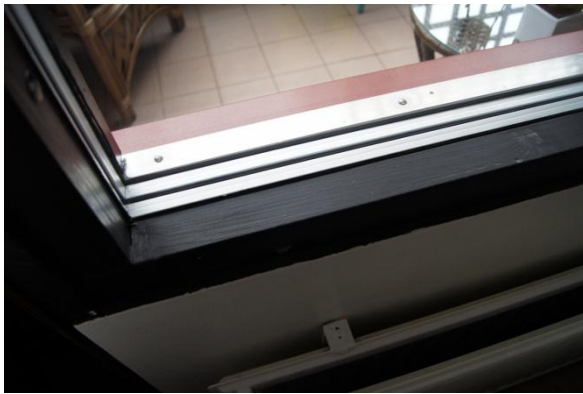
KUVIO 21. Ikkunat ovat yleisesti tyydyttävässä kunnossa
