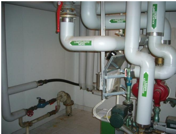
KUVIO 34. Järjestelmissä ei havaittu vuotoja
