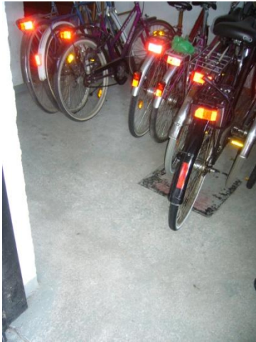
KUVIO 31. Pyörävaraston lattiassa on kulumaa
