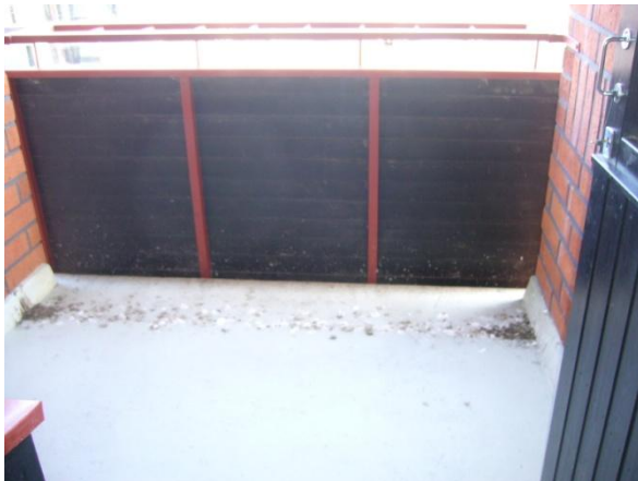
KUVIO 30. Tuuletusparvekkeen lattiat tulisi puhdistaa
