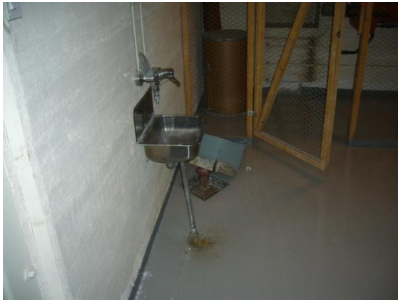
KUVIO 47. Väestönsuojassa havaittiin huomattavia kosteuspoikkeamia
