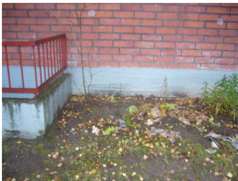
KUVIO 17. Sokkelissa on havaittavissa paikoitellen maalin irtoilua ja likaa
