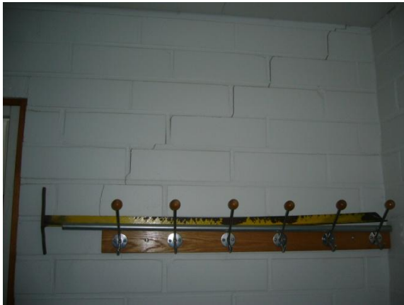
KUVIO 25. Pesutuvan tiiliseinässä on halkeama
