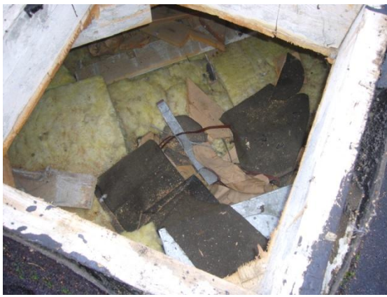
KUVIO 23. Yläpohjan eristetilassa on sinne kuulumatonta tavaraa
