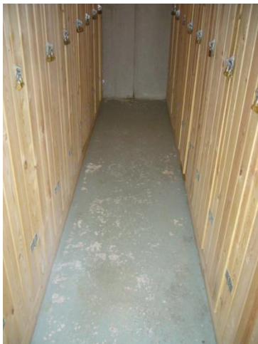
KUVIO 29. Kylmävaraston lattia on kulunut
