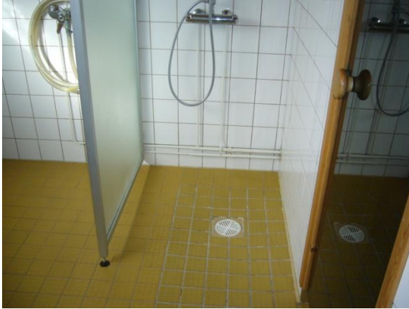
KUVIO 38. Pesuhuoneessa havaittiin kosteuspoikkeamaa.
