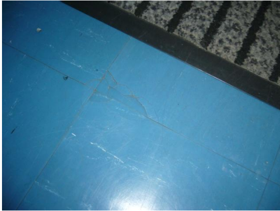
KUVIO 24. Lattiapinnassa pieniä vaurioita
