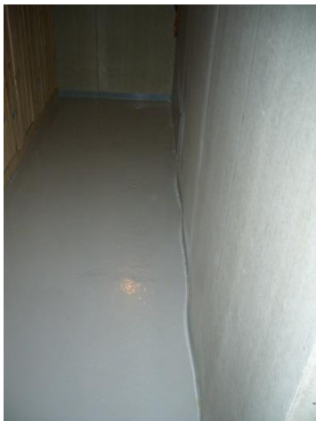
KUVIO 46. Seinälevytykset ovat turpoilleet mahdollisesti kosteuden takia
