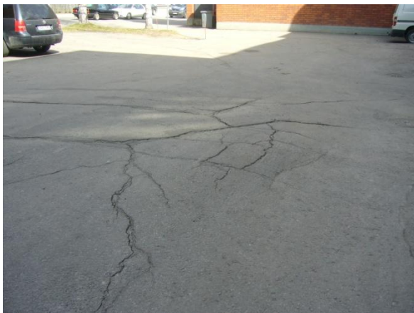
KUVIO 13. Piha-alueiden päällysteet ovat pääosin välttävässä kunnossa
