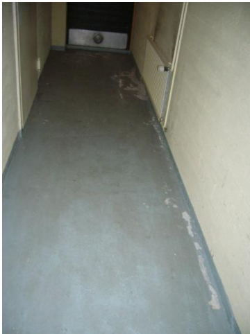
KUVIO 32. B-portaan kellarikerroksen lattiassa on kulumaa
