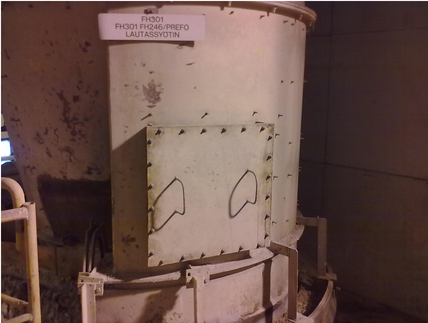
KUVA 19. FHT lautassyöttimen suppilossa oleva miesluukku. (valokuva Anssi Hakkarainen)
