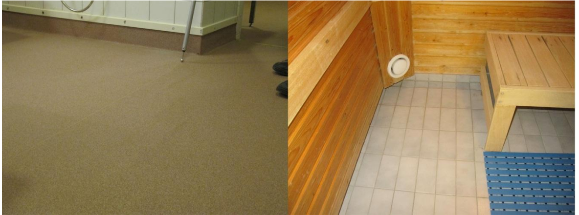
Kuva 25. Kellarin pesuhuoneen lattiamatto on kupruillut laajalta alueelta ja saunasta on lattialaattoja irti
