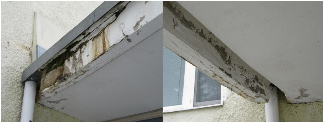
Kuva 14. H-oven vaurioitunut katos. Vasemmalta näkee, että rakenteessa on alkanut kasvaa sammalta
