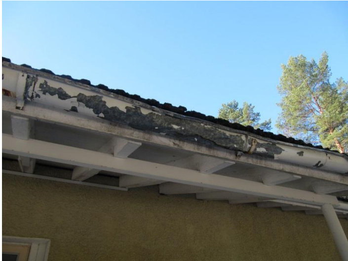
Kuva 8. S-oven katoksen ränni on pahasti vaurioitunut toistuvien kuorma-autolla peruutusten vuoksi
