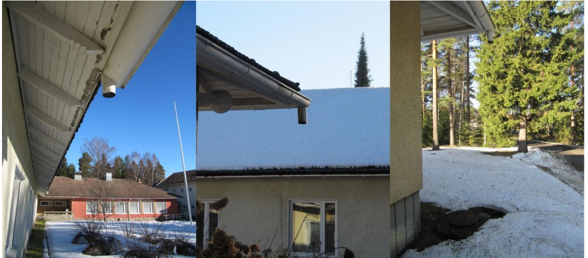
Kuva 3. Kuvassa muita syöksyputkettomia rännejä. Vasemmalla olevasta kuvasta näkyy myös, että Aamuruskon rakennusosasta puuttuu ränni lähes kokonaan
