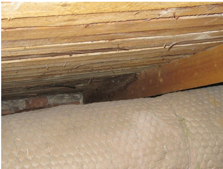
Kuva 17. Keittiön ullakon katoniskoista näkee, että rakenteet ovat saaneet kosteutta
