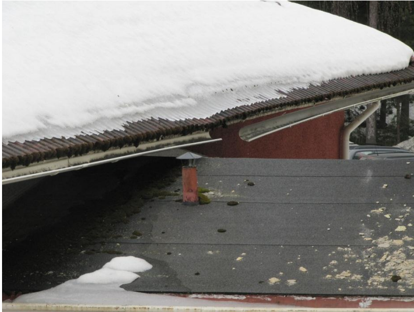
Kuva 5. Yhdyskäytävän katolla on sammalta huonon ränniratkaisun vuoksi
