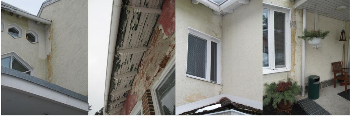
Kuva 13. Julkisivuverhouksen vaurioita. Toisena vasemmalta on keittiön pahasti vaurioitunut ulkoseinä. Äärimmäisenä oikealla on K-oven katos, jonka rännin kaato on seinään päin
