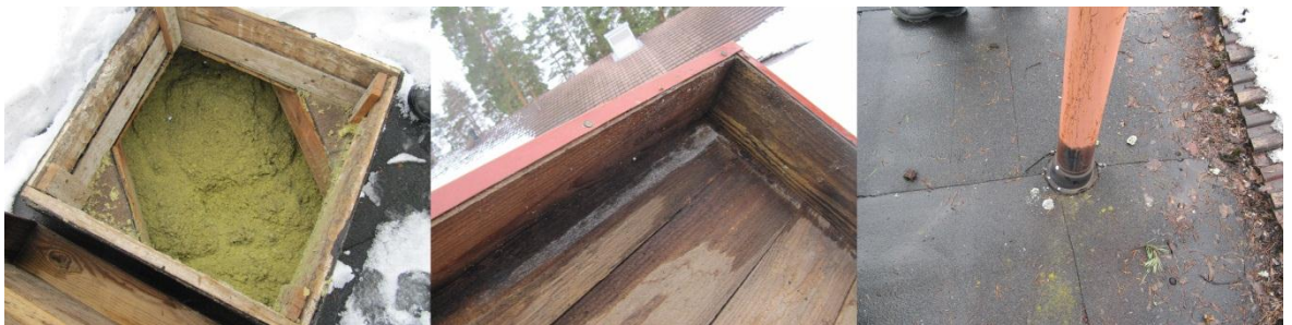
Kuva 20. Lähdekodin sisääntulo-osan yläpohjan tarkistusluukusta näkee, että yläpohja on aivan täynnä eristettä jopa harjalla. Tarkistusluukkujen kannet ovat märkiä. Läpivientejä ei ole tiivistetty niiden juurista
