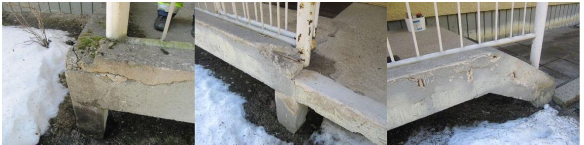
Kuva 9. S-oven katoksen perustukset ovat myös pahoin vaurioituneet
