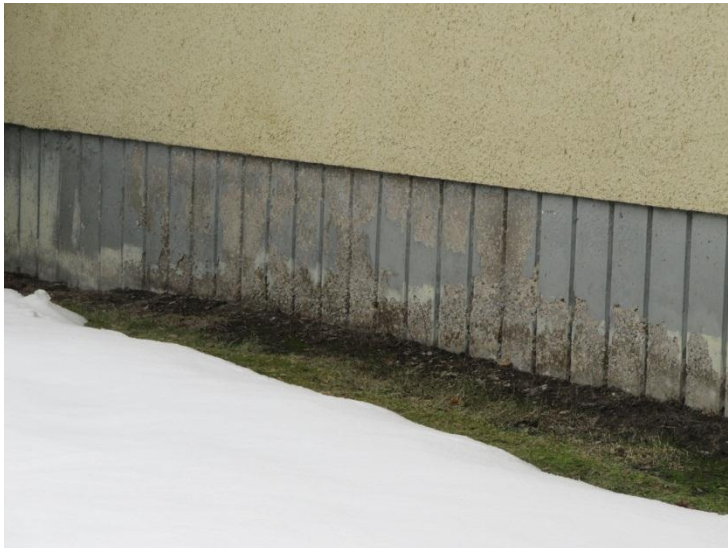
Kuva 10. Laajennusosan sokkelin maalipinnat ovat huonot
