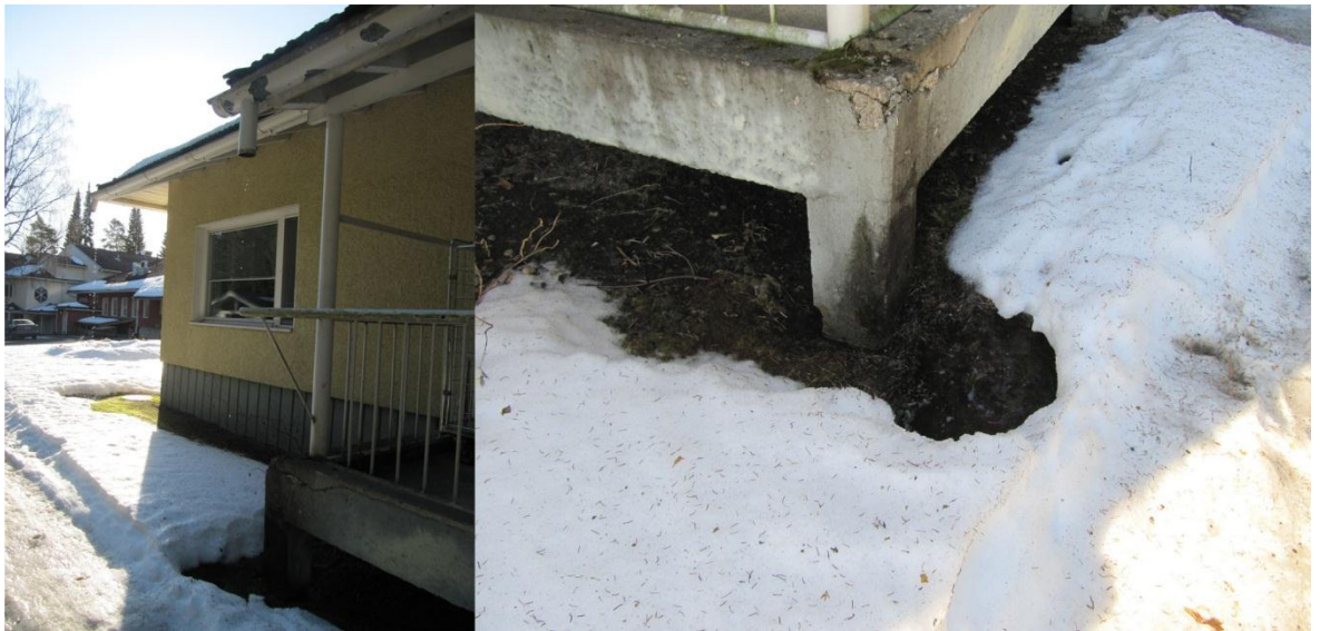
Kuva 2. Syöksyputketon ränni ja kohta mihin vesi tippuu
