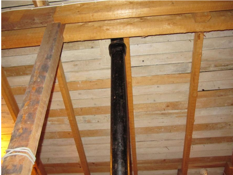
Kuva 19. Lähdekodin Iltaruskon ullakon läpi kulkevia viemäriputkia ei ole lämpöeristetty
