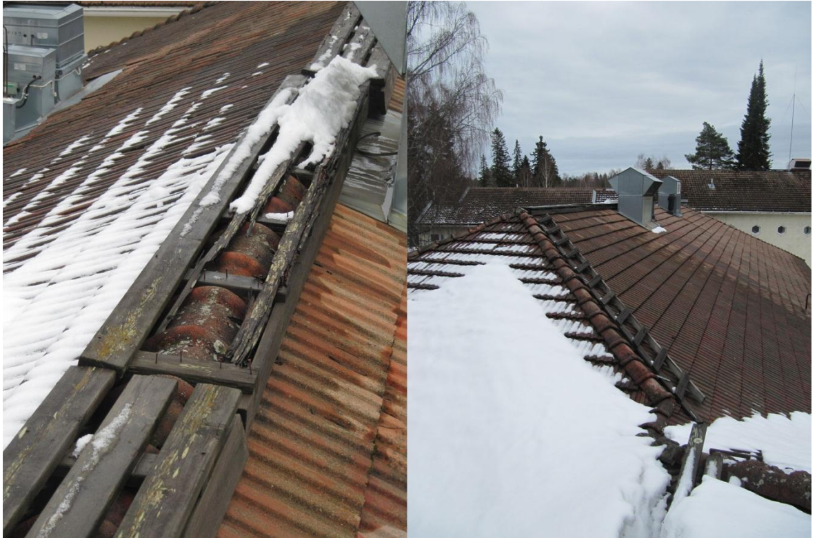
Kuva 22. Kattovarusteet ovat puuta ja paikoitellen pahasti lahonneita
