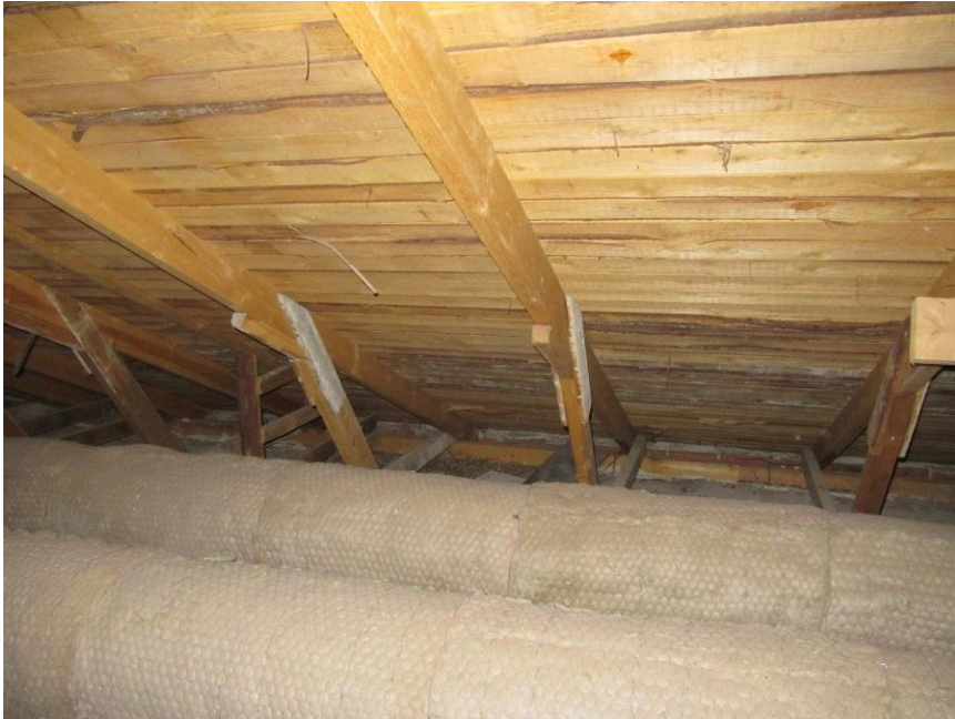
Kuvio 4. Tuomikodin yläpohjarakenne. Seinän ja yläpohjan liitoskohdasta näkee, ettei siellä ole tuuletusrakoja
