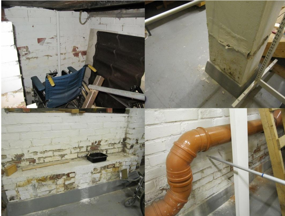
Kuva 11. Vanhan lämpökeskuksen tilassa oli erittäin korkeita kosteuslukemia n. 500mm laatan pinnasta ylöspäin
