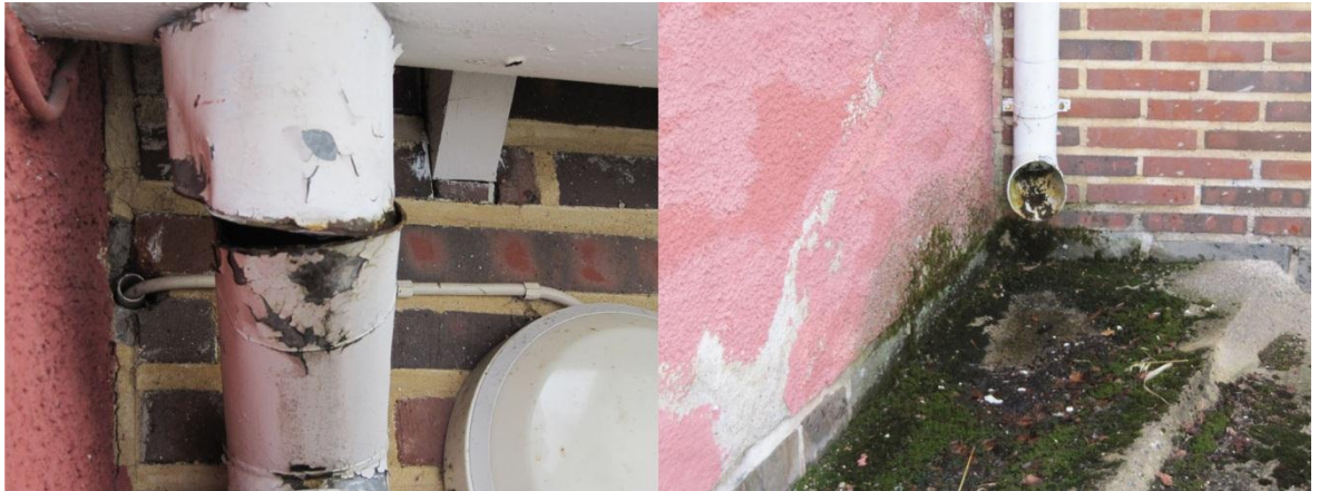
Kuva 4. E-oven yhdyskäytävän syöksyputki on poikki ja kulmaus on pahasti sammaloitunut
