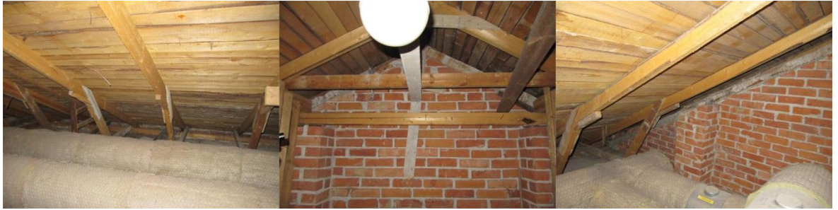
Kuva 16. Alkuperäisten rakennusosien ullakoilla ei ole riittävästi tuuletusreikiä
