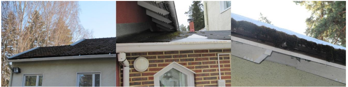
Kuvio 8. Katoilla esiintyvää sammaloitumista
