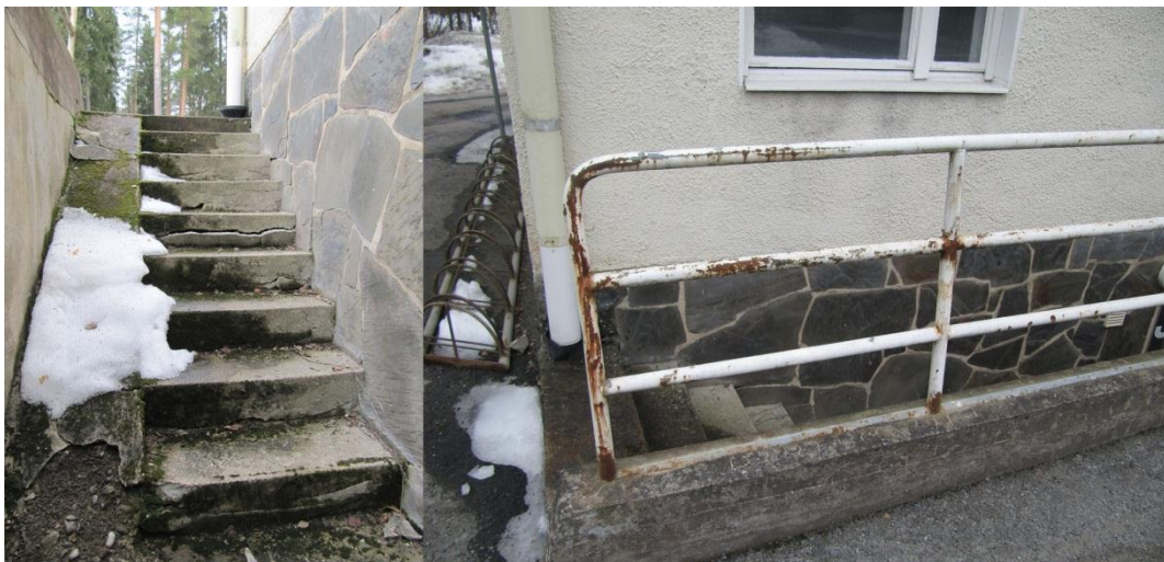
Kuva 15. Pienkoti Kannukan kellariin johtavat portaat ovat pahasti halkeilleet. Portaiden kaide on ruosteessa
