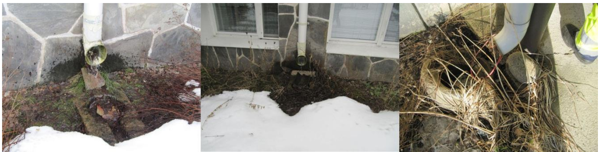
Kuva 6. Vedenohjaus toimii huonosti vanhoilla syöksyputkilla ja betonisilla vedenohjaimilla. Oikealla olevasta kuvasta näkyy, että joissakin syöksyputkissa on lämmityskaapelit
