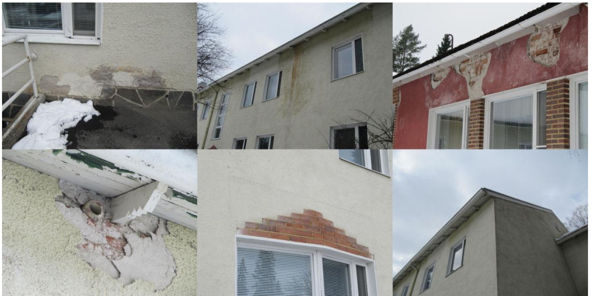
Kuva 12. Julkisivuverhouston vaurioita. Alhaalta oikealta näkee, ettei rakennusosassa ole räystästä
