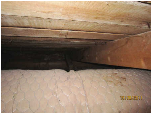
Kuva keittiön ullakolta. Kuvasta näkyy, kuinka kosteus on vaikuttanut rakenteisiin.
